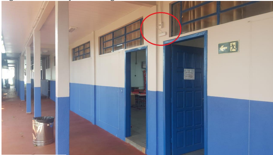
Figura 10: Iluminação de emergência deslocada.
