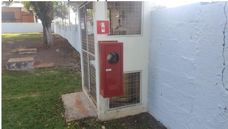
Figura 12: Sinalização de equipamento em local de difícil visualização.
