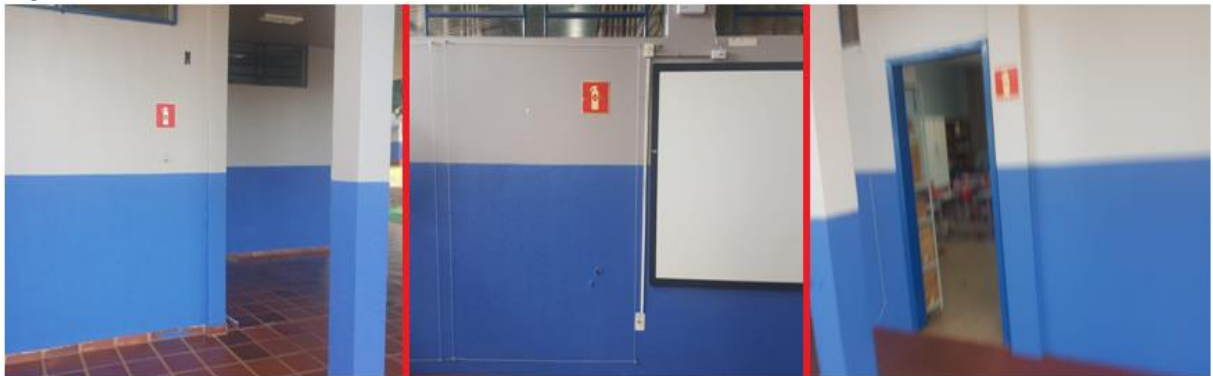
Figura 13: Ausência do extintor.
