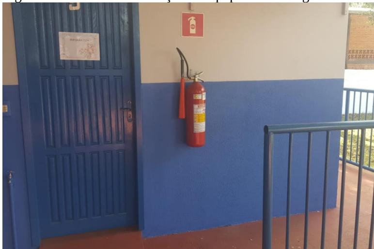
Figura 11: Altura de sinalização de equipamento irregular.
