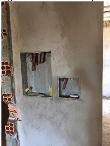
Figura 3 – Caixa de distribuição
