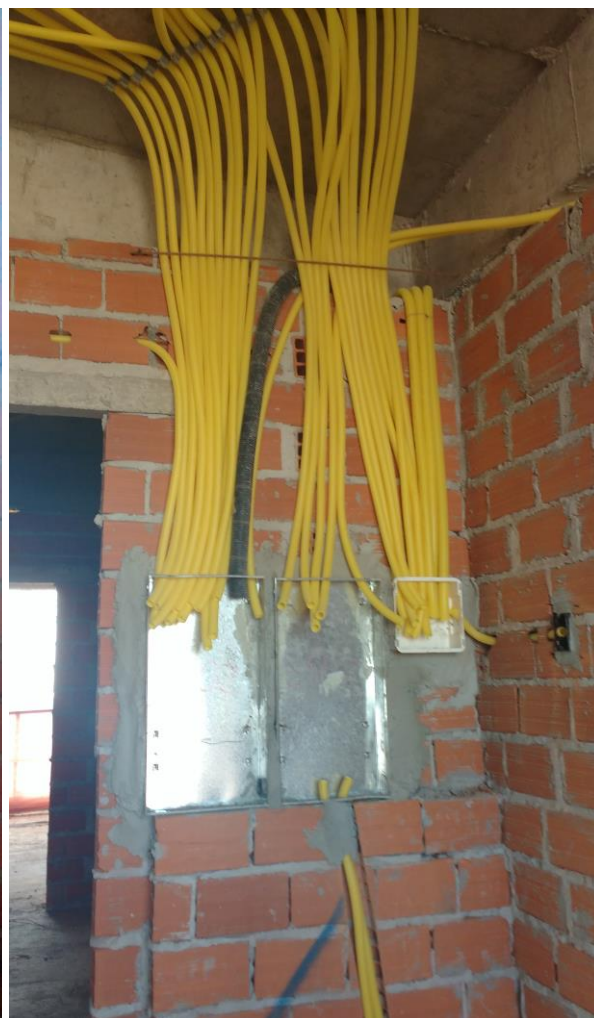
Figura 6 – Caixa de passagem
