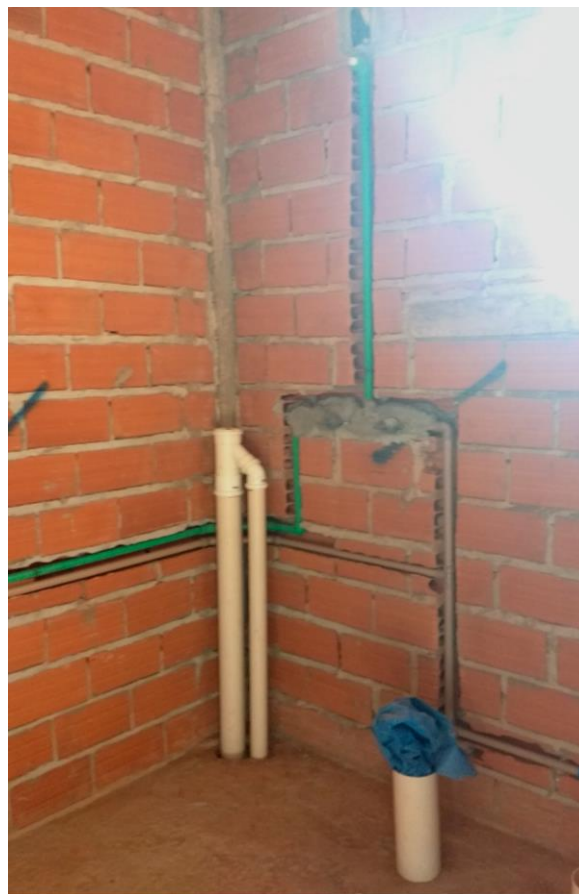
Figura 4 – Tubulação água quente e fria
