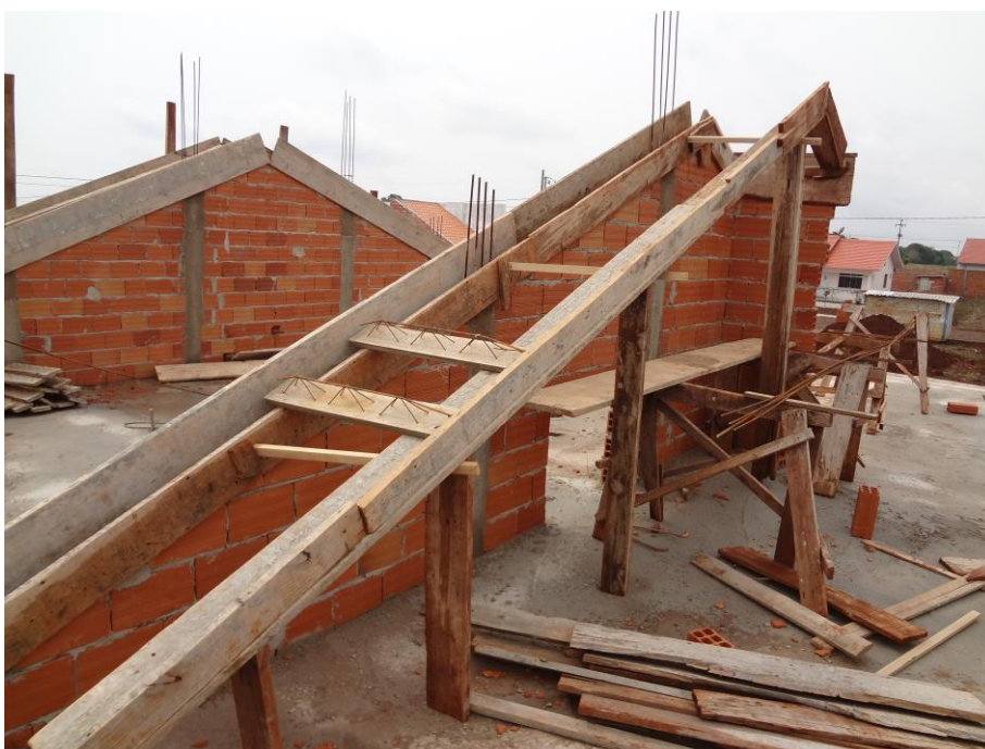
Imagem 13: Preparação para beirais estagnada por falta de repasse de vigotas – Obra 2
