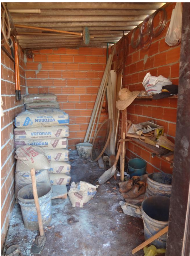
Imagem 3: Organização do depósito – Obra 2.
