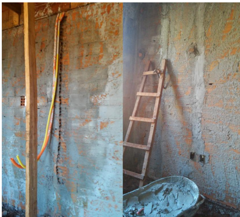
Figura: Instalação elétrica.
