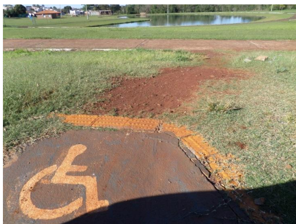
Figura 37 – Acesso de cadeirantes em péssimas condições de uso.
