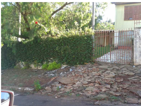
Imagem 4 – Calçada intrafegável no bairro Country.
