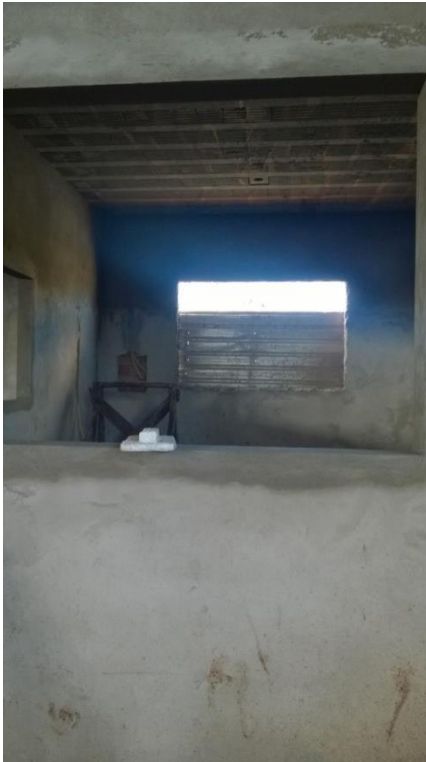
Figura 08 – Parede com emboço 01
