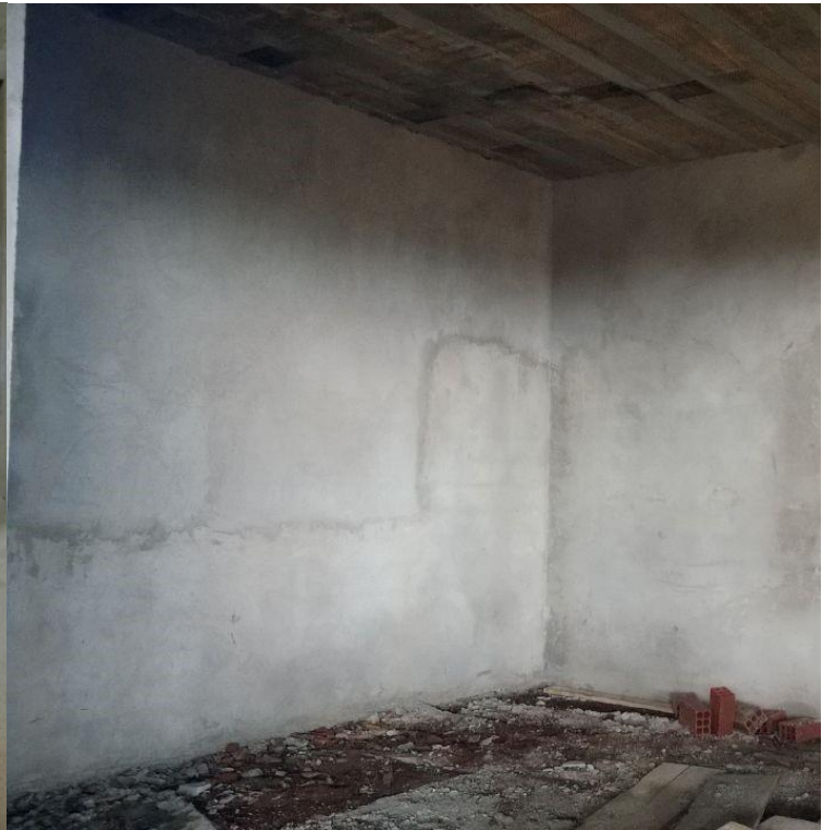
Figura 09 – Parede com emboço 02
