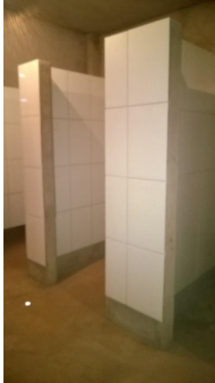
Figura 10 – Parede com emboço 01
