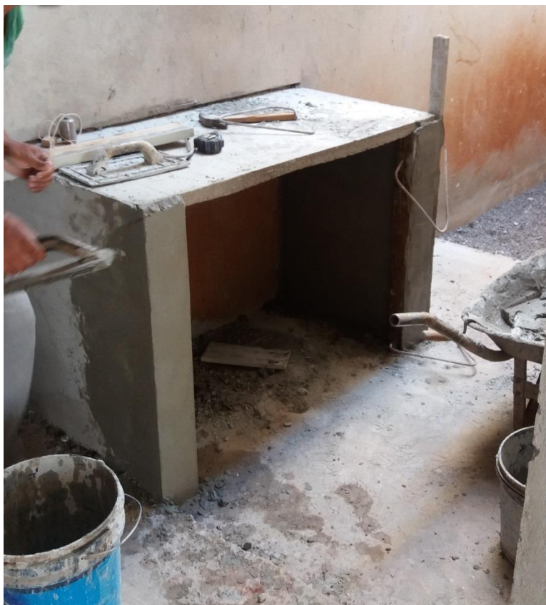
Figura 2 - Requadro central de gás
