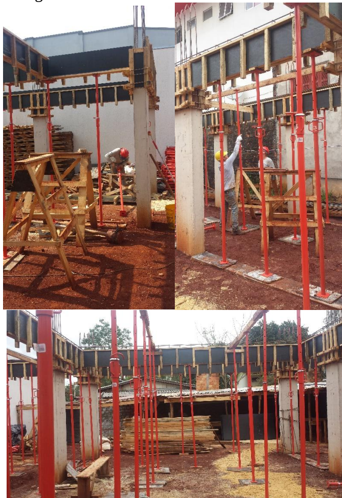
Imagem 08: Escoramento metálicos de vias aéreas.
