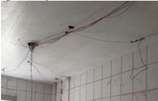
Figura 8: Instalação Elétrica Bwc
