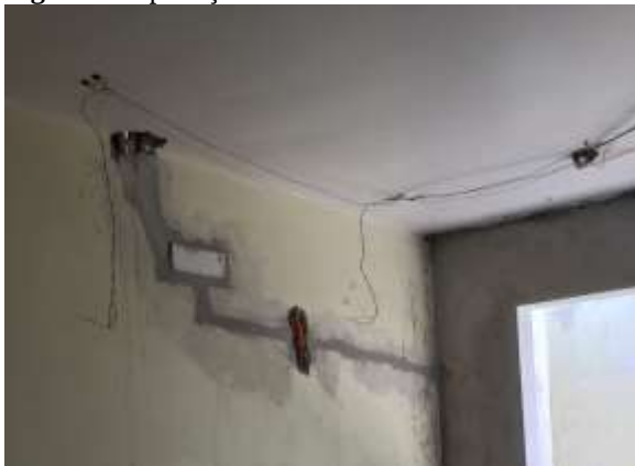
Figura 6: Aplicação de Conduítes
