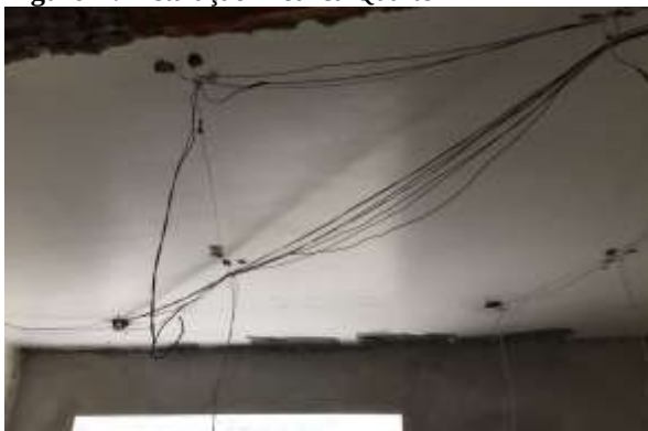
Figura 7: Instalação Elétrica Quarto
