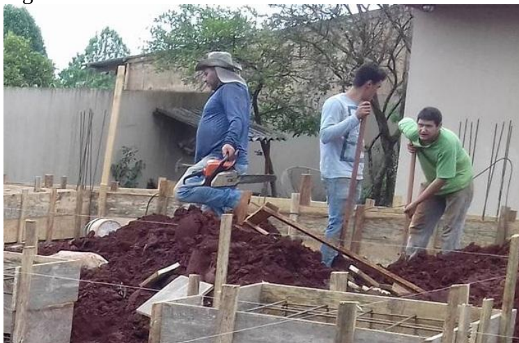
Figura 16 - Funcionários não utilizando os EPI
