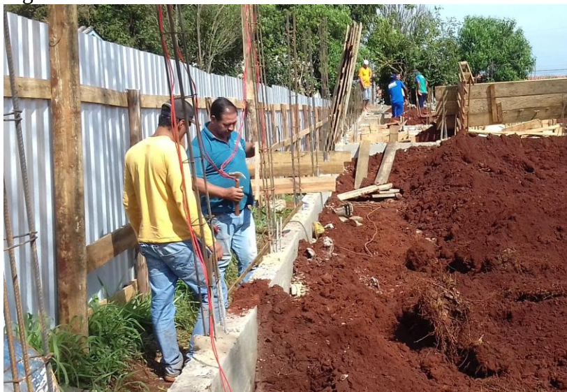
Figura 18 - Funcionários não utilizando os EPI
