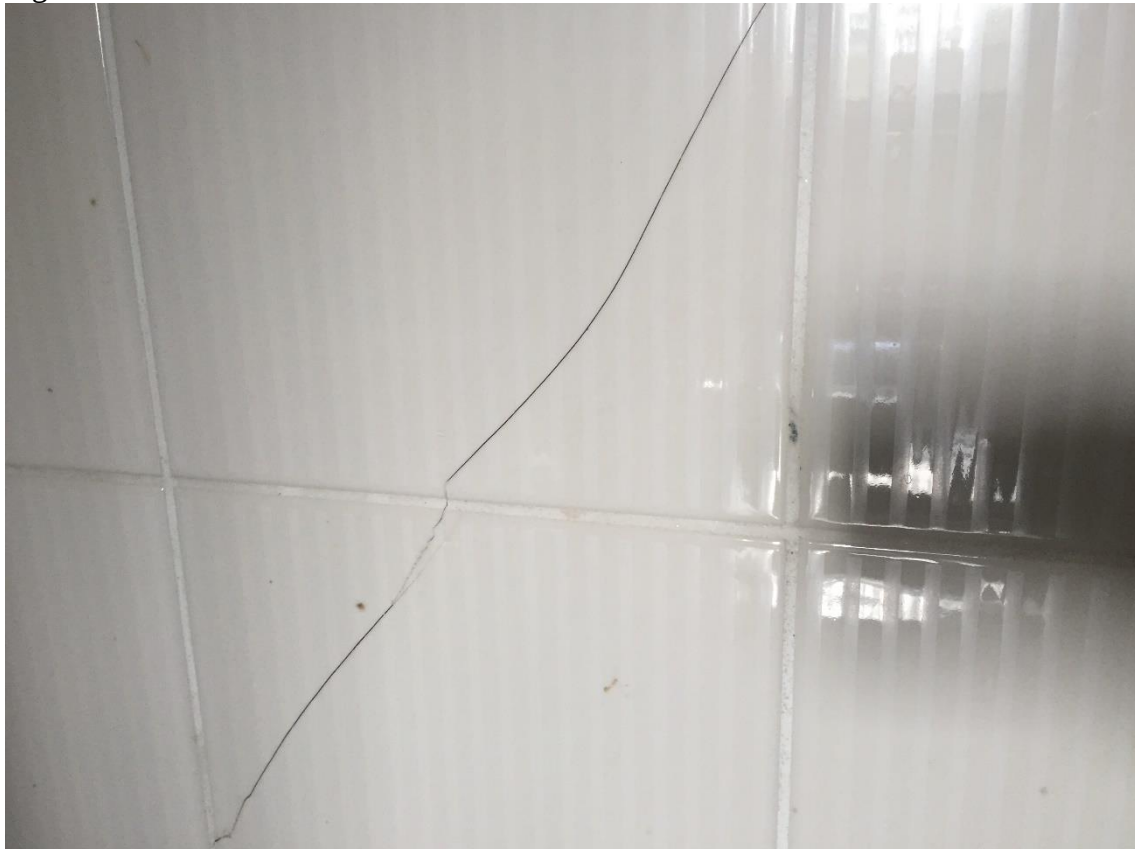
Figura 11 – Fissura na cerâmica.
