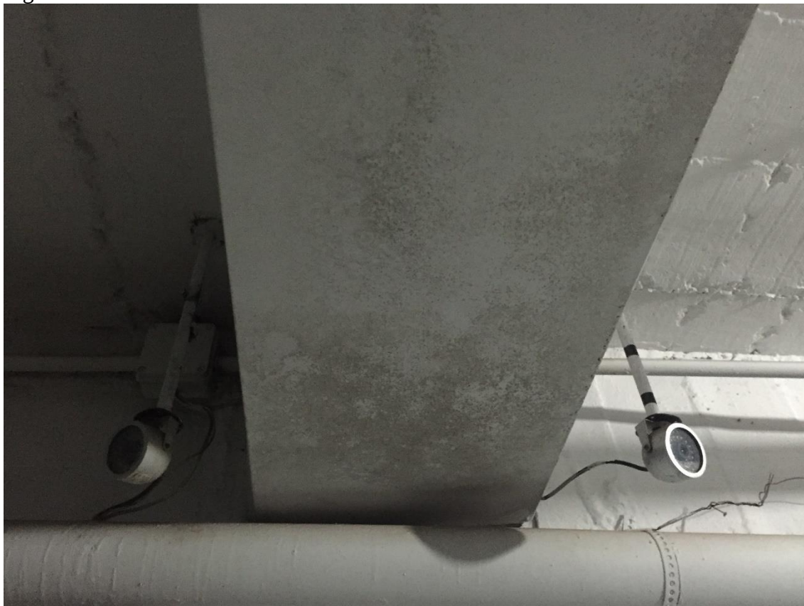
Figura 21 – Bolor no subsolo.
