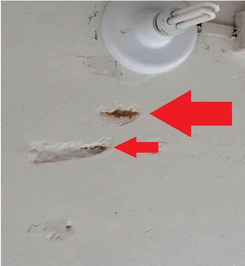
Figura 18 – Corrosão na armadura.
