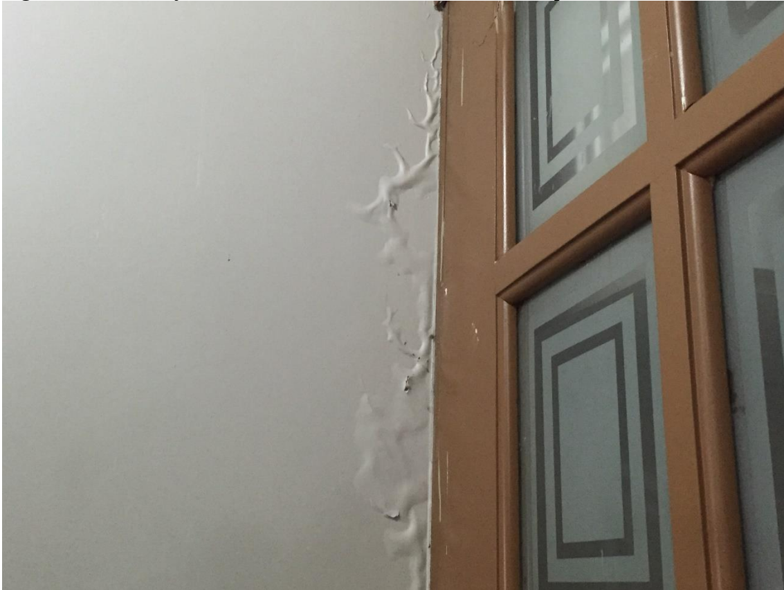
Figura 07 – Infiltração no hall de entrada formando bolhas na pintura.
