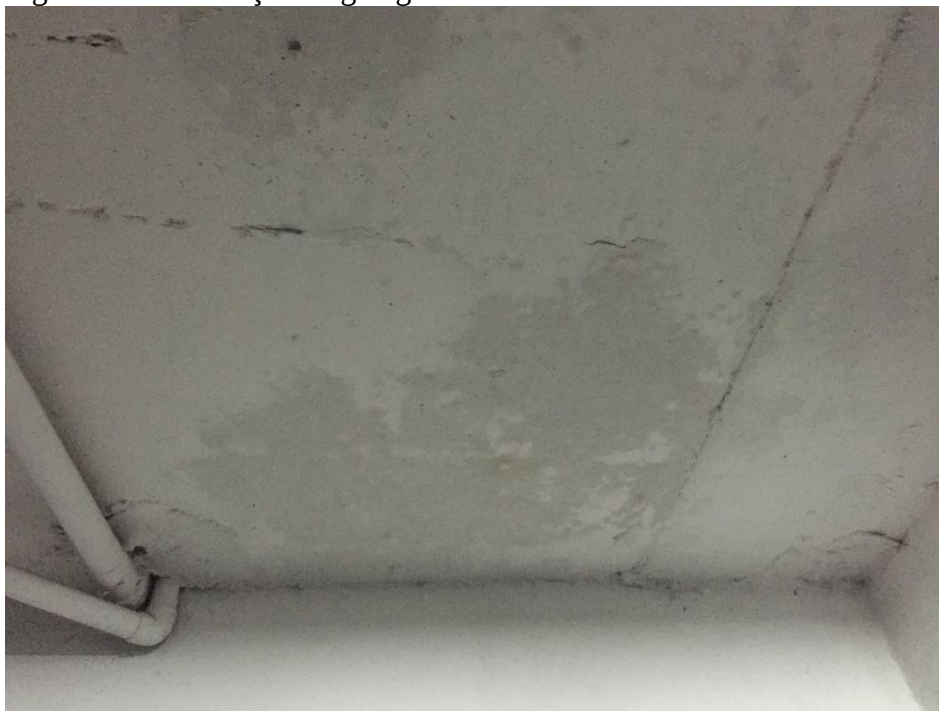
Figura 19 – Infiltração na garagem do subsolo.
