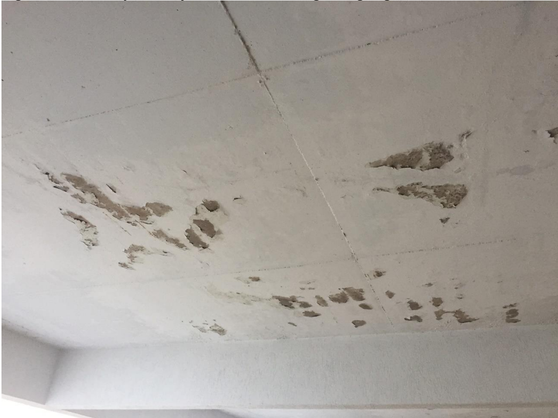
Figura 14 – Infiltração em laje de cobertura de vagas de garagem.
