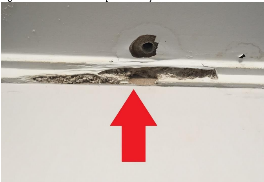
Figura 10 – Área danificada pela infiltração.
