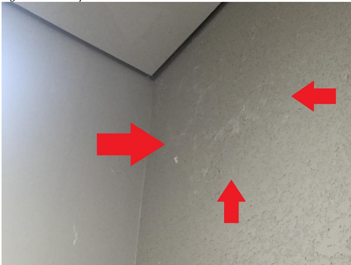
Figura 06 – Infiltração no hall de entrada.
