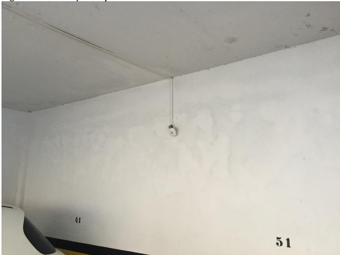
Figura 13 – Infiltração em parede de divisa.
