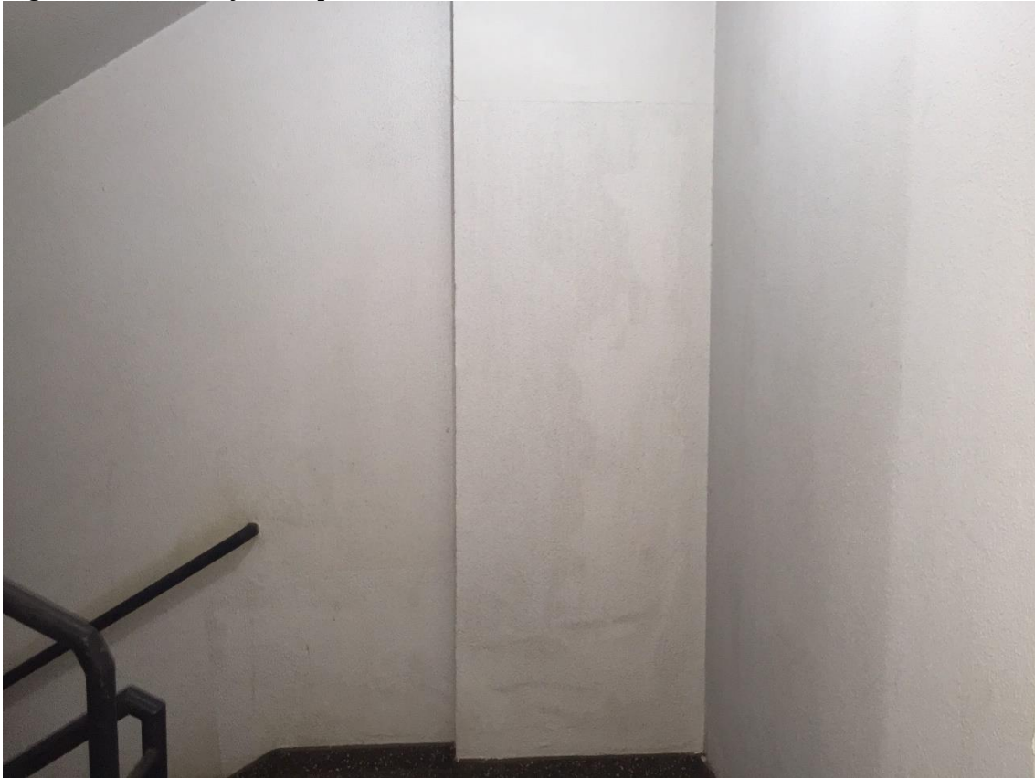
Figura 05 – Infiltração em parede.
