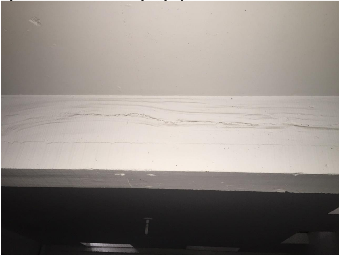
Figura 22 – Fissura horizontal em viga de garagem no subsolo.
