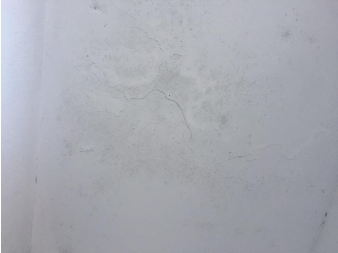
Figura 16 – Fissura em laje.
