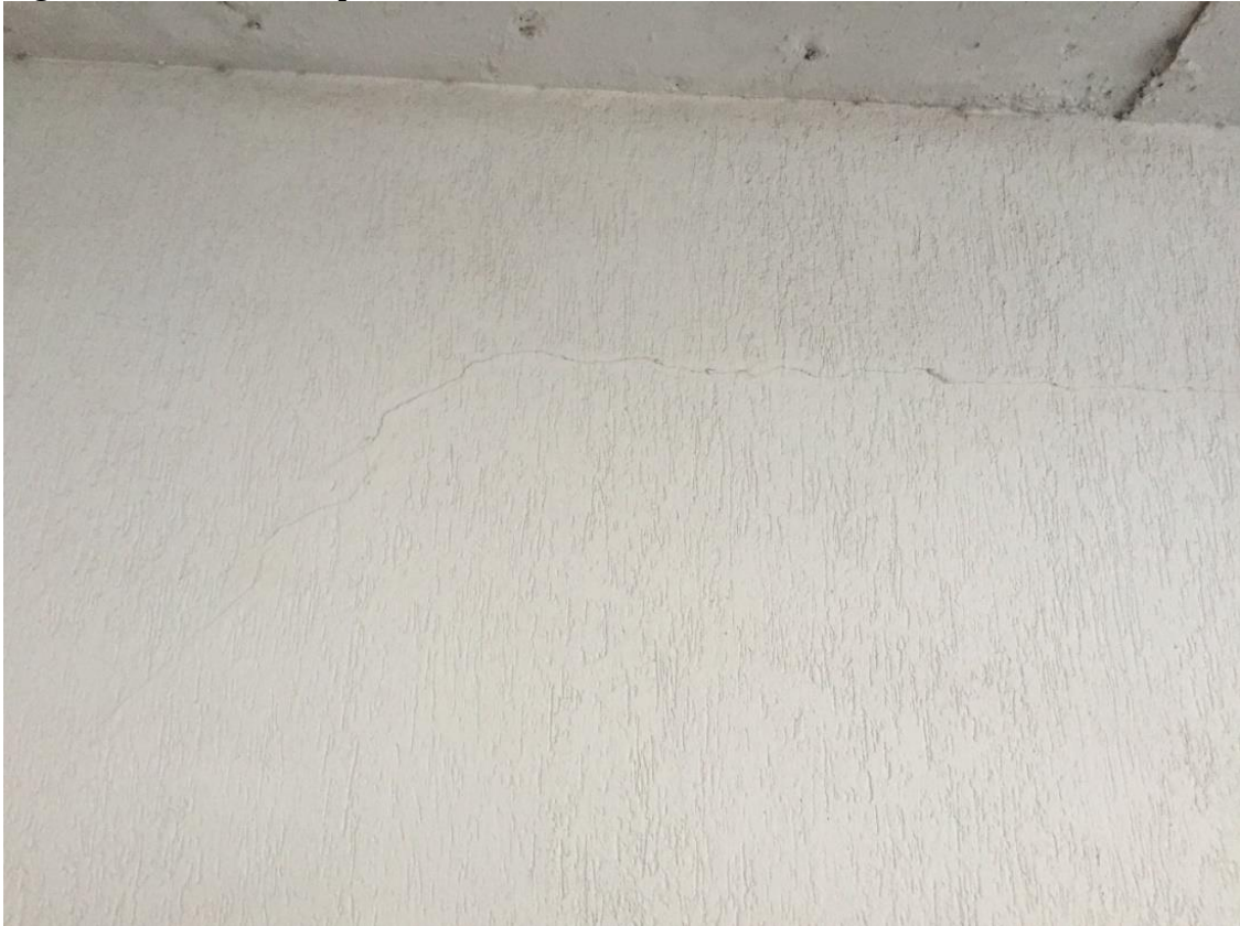
Figura 17 – Fissura em parede.
