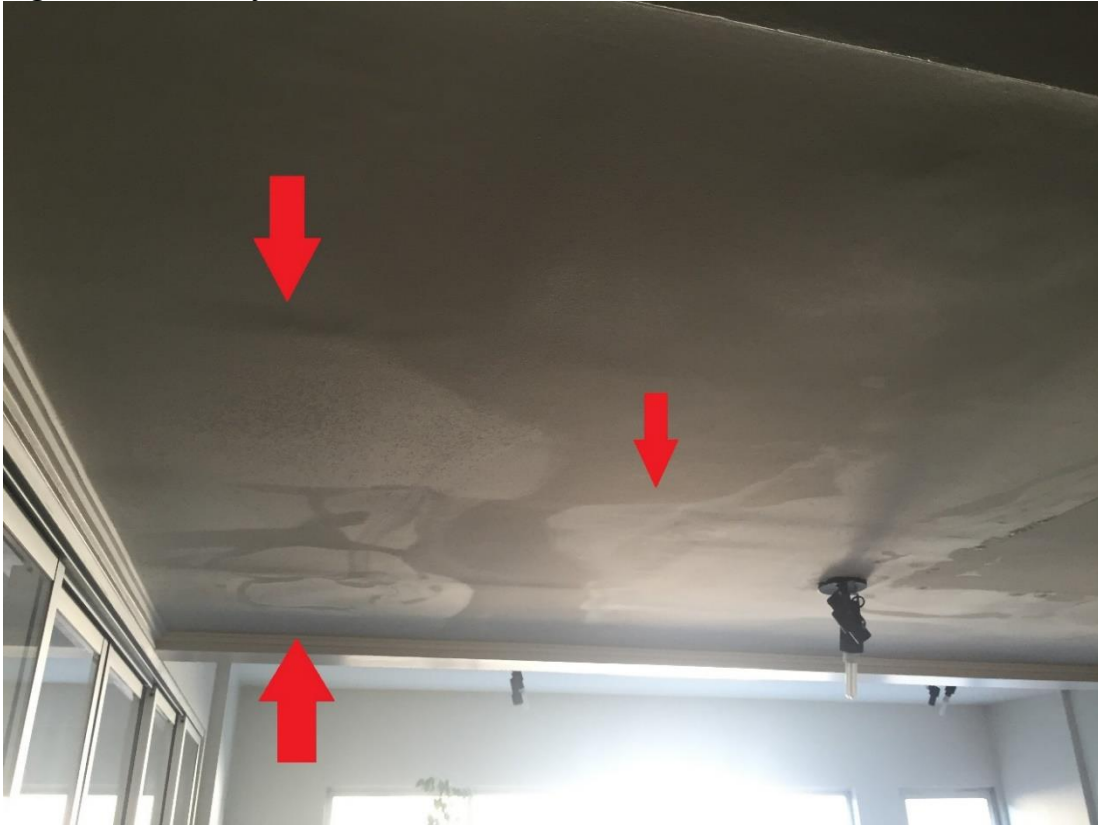
Figura 09 – Infiltração no salão de festas.
