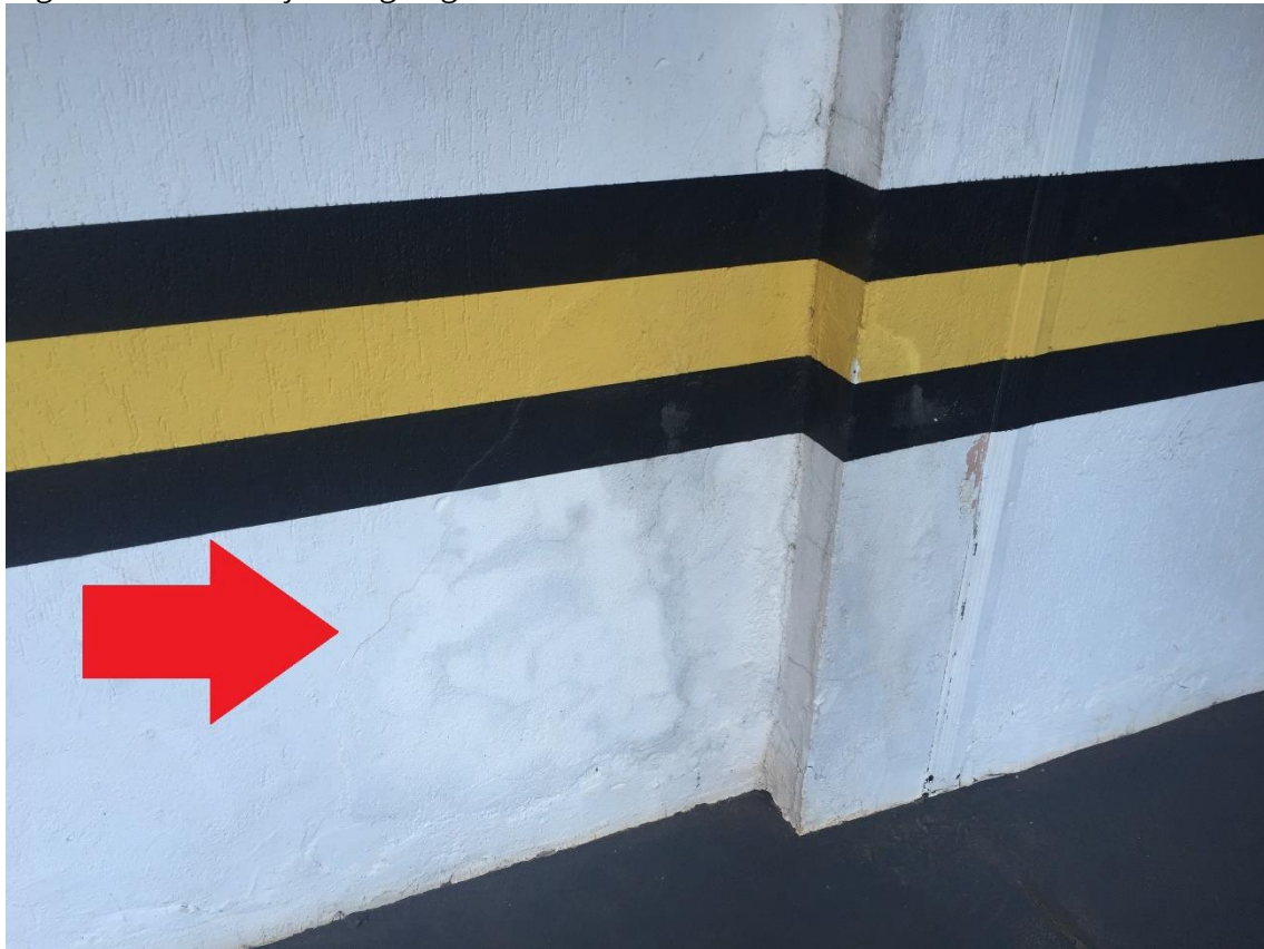
Figura 12 – Infiltração na garagem térrea.
