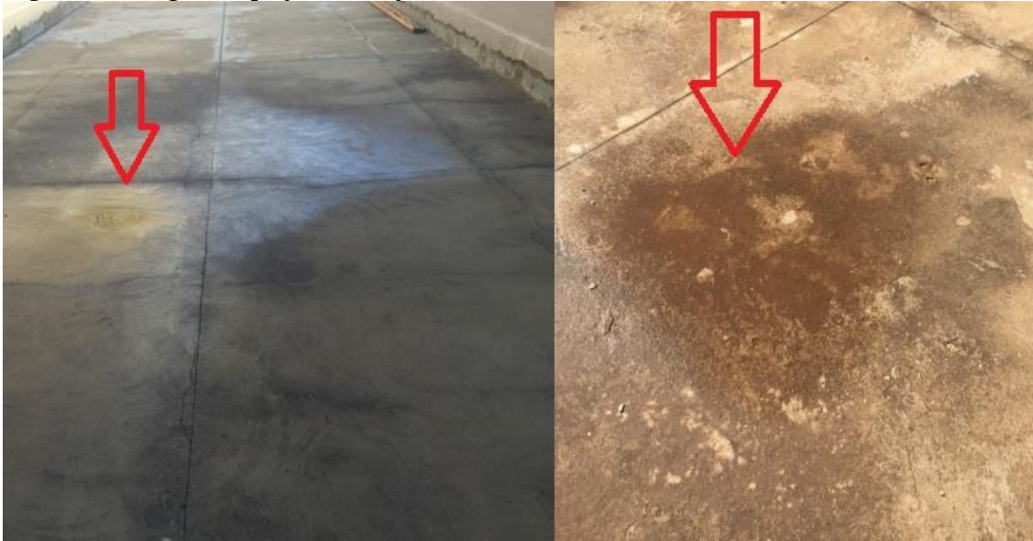
Figura 15 – Água empoçada na laje de cobertura.
