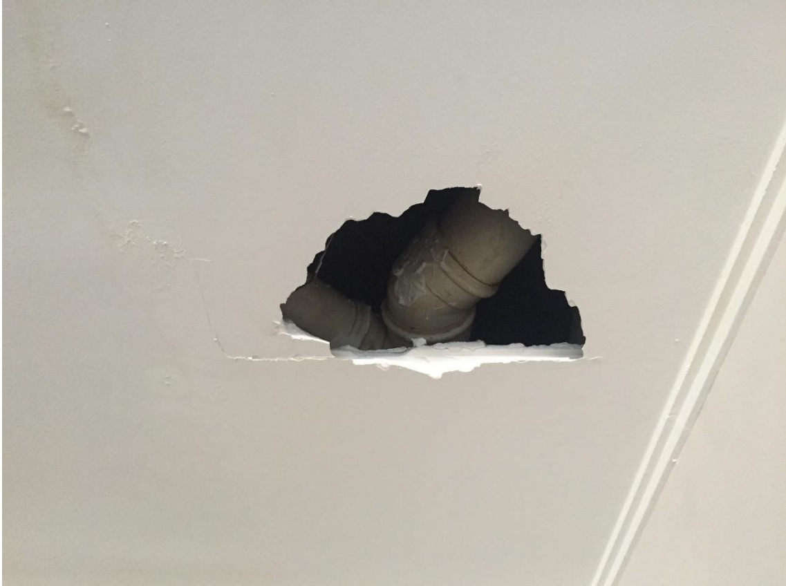
Figura 08 – Presença de tubulação na área superior à cobertura do salão de festas.
