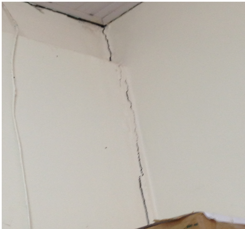
Figura 30 – Trinca vertical na parede. Fonte: Autor, 2016.
