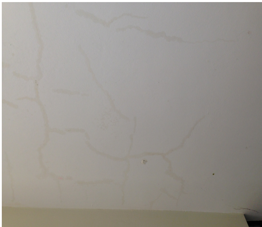
Figura 39 – Fissuras na laje com sinais de infiltração.
