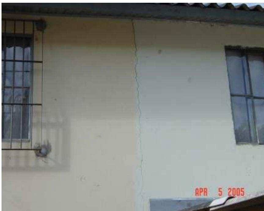
Figura 20 – Trincas na parede comum entre dois módulos.
