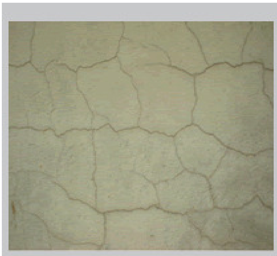
Figura 22 – Retração da argamassa de assentamento. Fonte: SEGAT, 2005.
