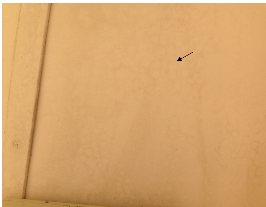
Figura 21 – Micro fissuras na extensão da parede.
