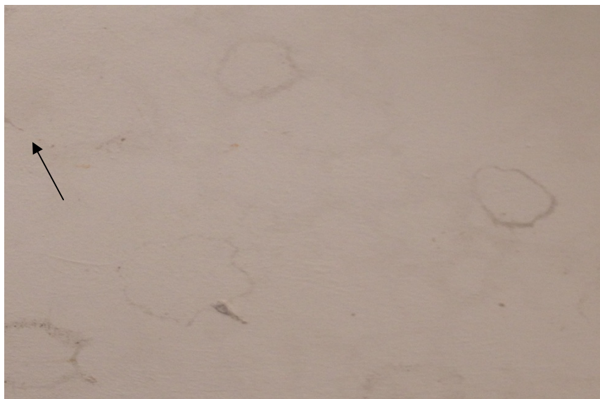
Figura 41 – Infiltração na laje.
