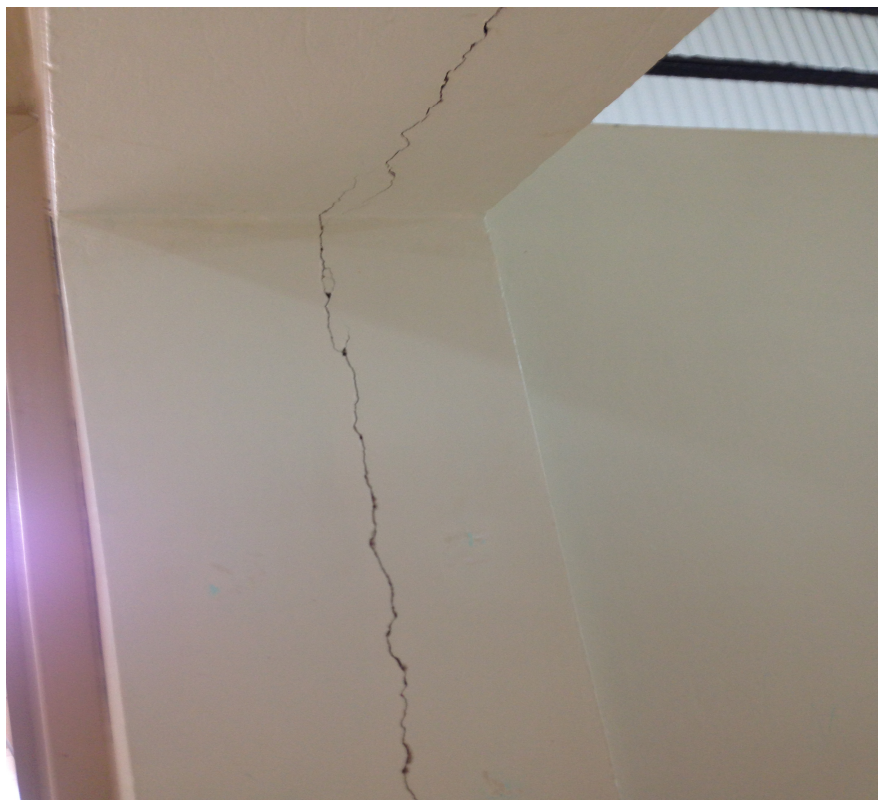
Figura 19 – trinca na ligação entre duas estruturas.
