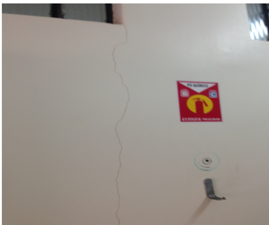
Figura 25 – Fissura causada por recalque em parede. Fonte: Autor, 2016.
