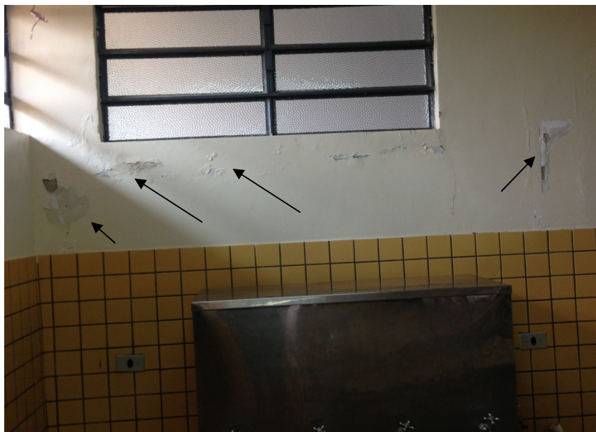
Figura 40 – Bolor decorrido do vazamento de tubulação hidráulica. Fonte: Autor, 2016.
