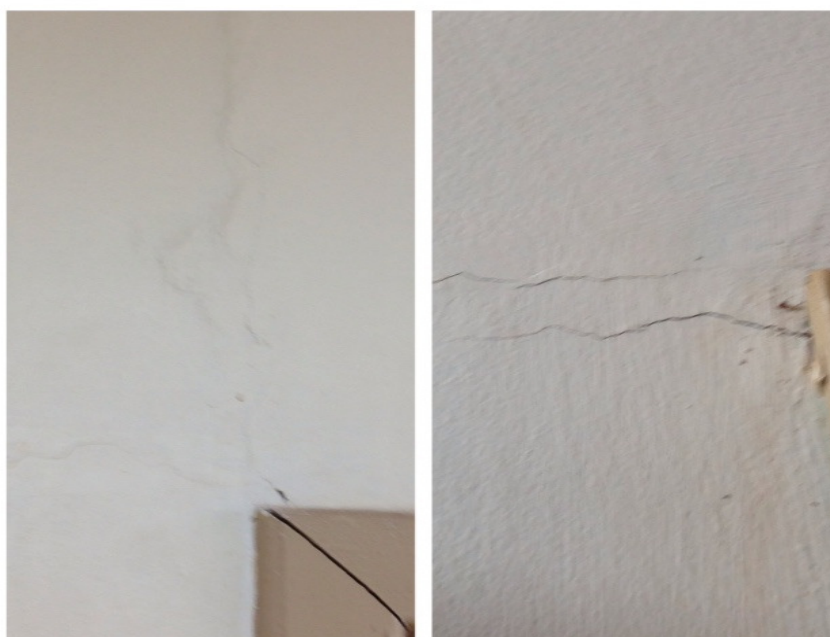
Figura 32 – Fissuras causadas por deformação da estrutura. Fonte: Autor, 2016.
