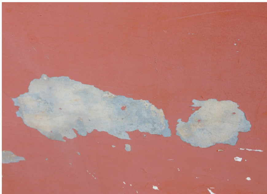
Figura 43 – Descolamento de pintura na parede externa. Fonte: Autor, 2016.
