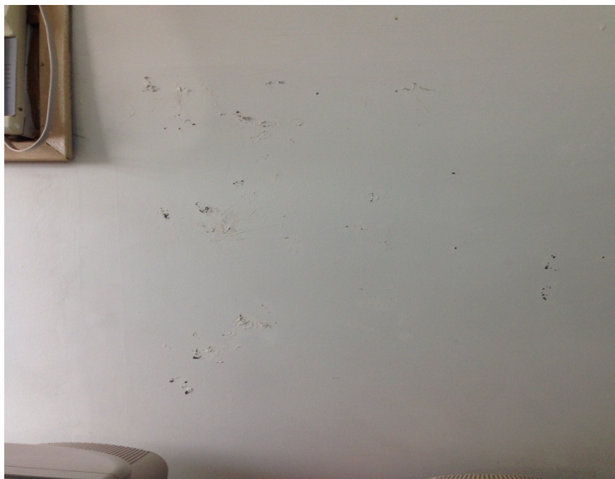
Figura 42 – Pontos de bolor na extensão da parede.
