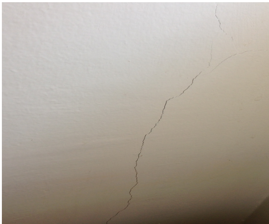
Figura 23 – Fissura por movimentação térmica na parede. Fonte: Autor, 2016.
