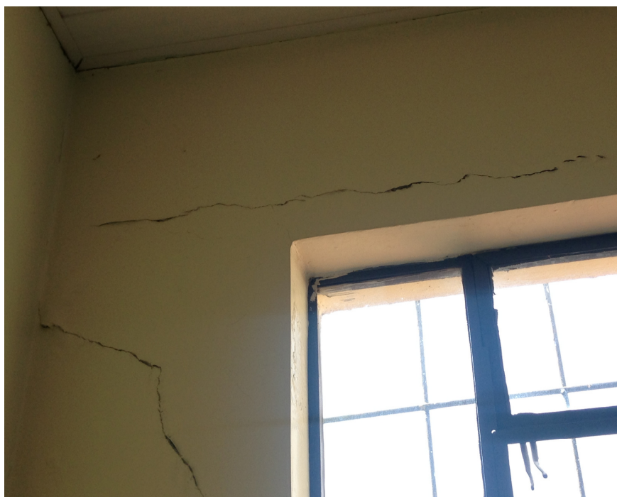
Figura 27 – Trincas na parede. Fonte: Autor, 2016.
