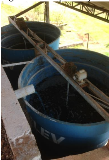
Figura 2 – Tanque estação de tratamento de efluente.
