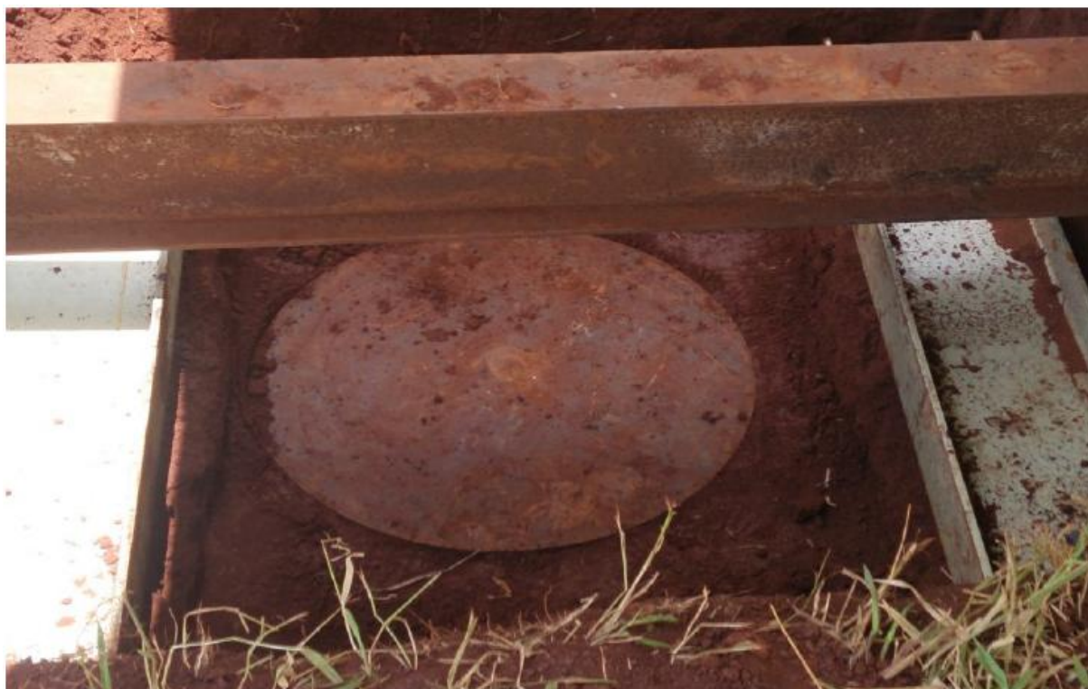
Figura 8 – Placa Metálica, conforme NBR 6489/84
