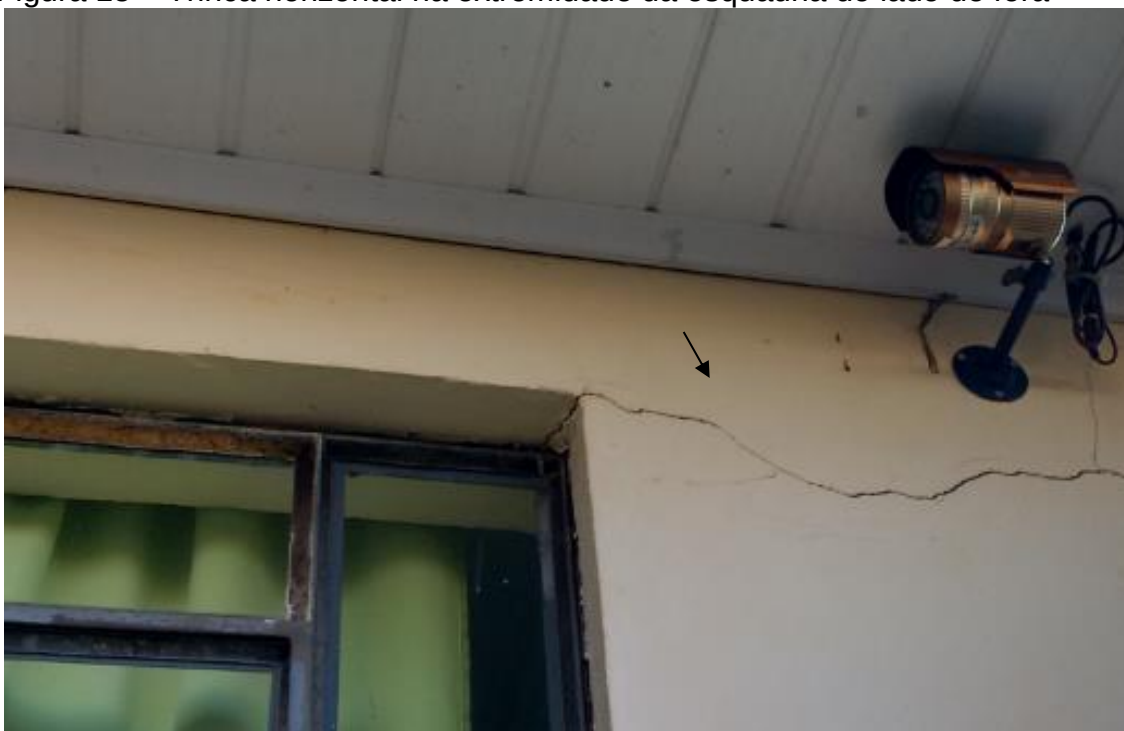
Figura 15 – Trinca horizontal na extremidade da esquadria do lado de fora
