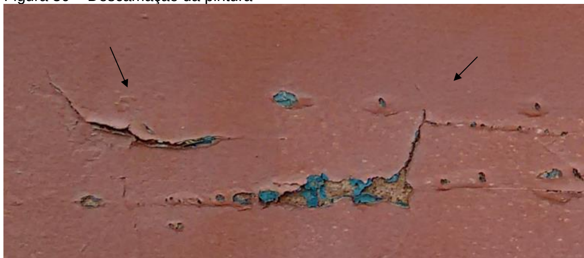
Figura 30 – Descamação da pintura
