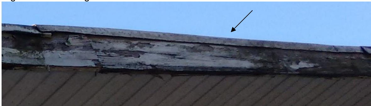
Figura 36 – Patologia na madeira do beiral
