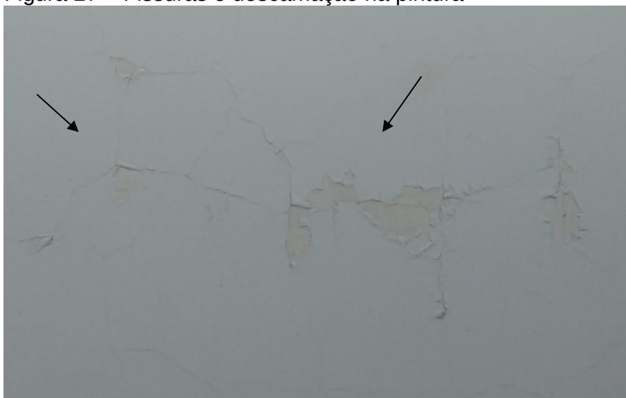
Figura 27 – Fissuras e descamação na pintura
