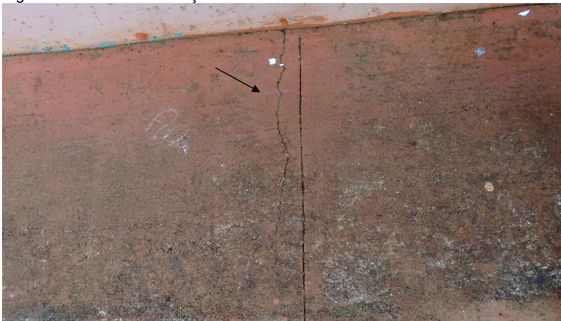
Figura 24 – Trincas na calçada
