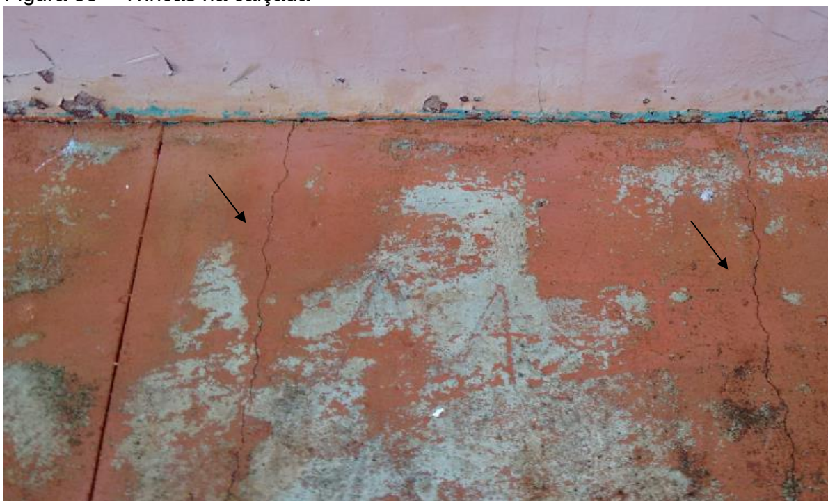
Figura 35 – Trincas na calçada
