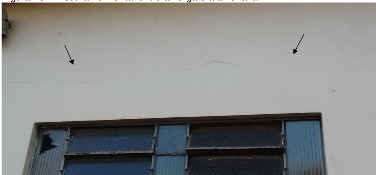
Figura 18 – Fissura horizontal entre a verga e a alvenaria
