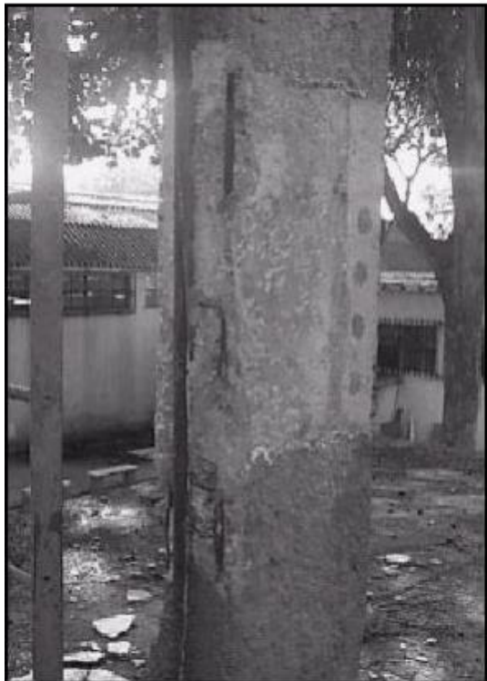
Figura 8 – Armadura corroída e desagregação do concreto no pilar
