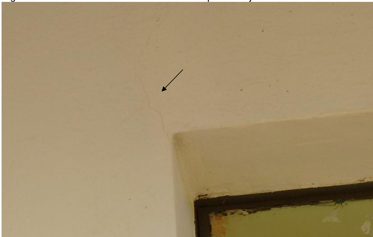
Figura 32 – Fissura vertical na extremidade superior da janela
