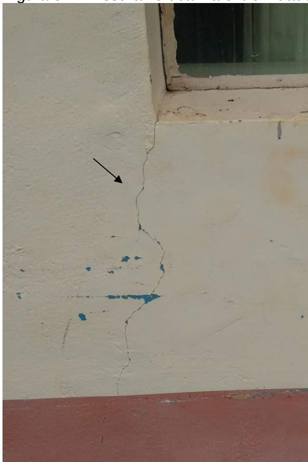
Figura 31 – Fissura vertical na extremidade inferior da janela
