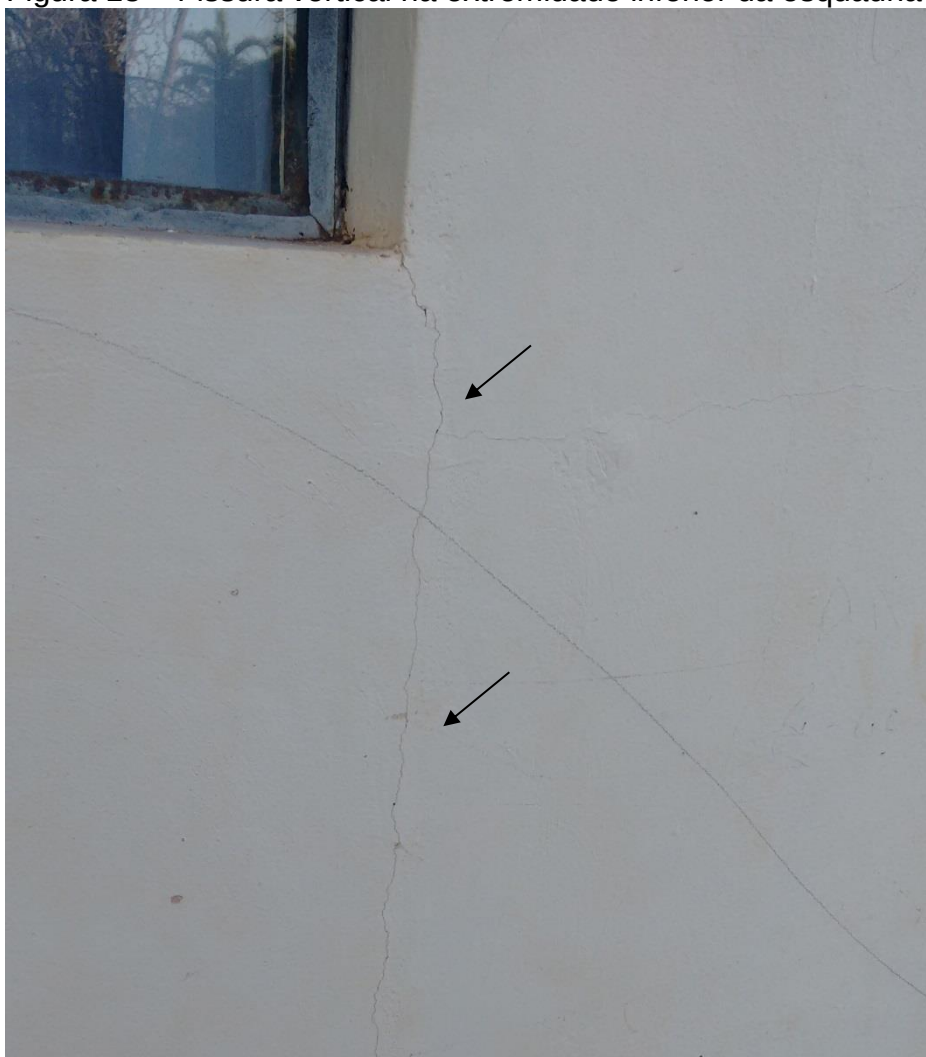
Figura 13 – Fissura vertical na extremidade inferior da esquadria
