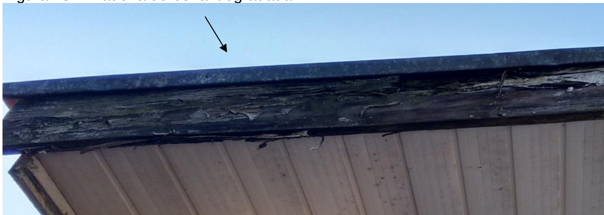
Figura 28 – Madeira do beiral degradada
