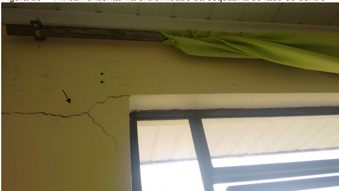
Figura 16 – Trinca horizontal na extremidade da esquadria do lado de dentro
