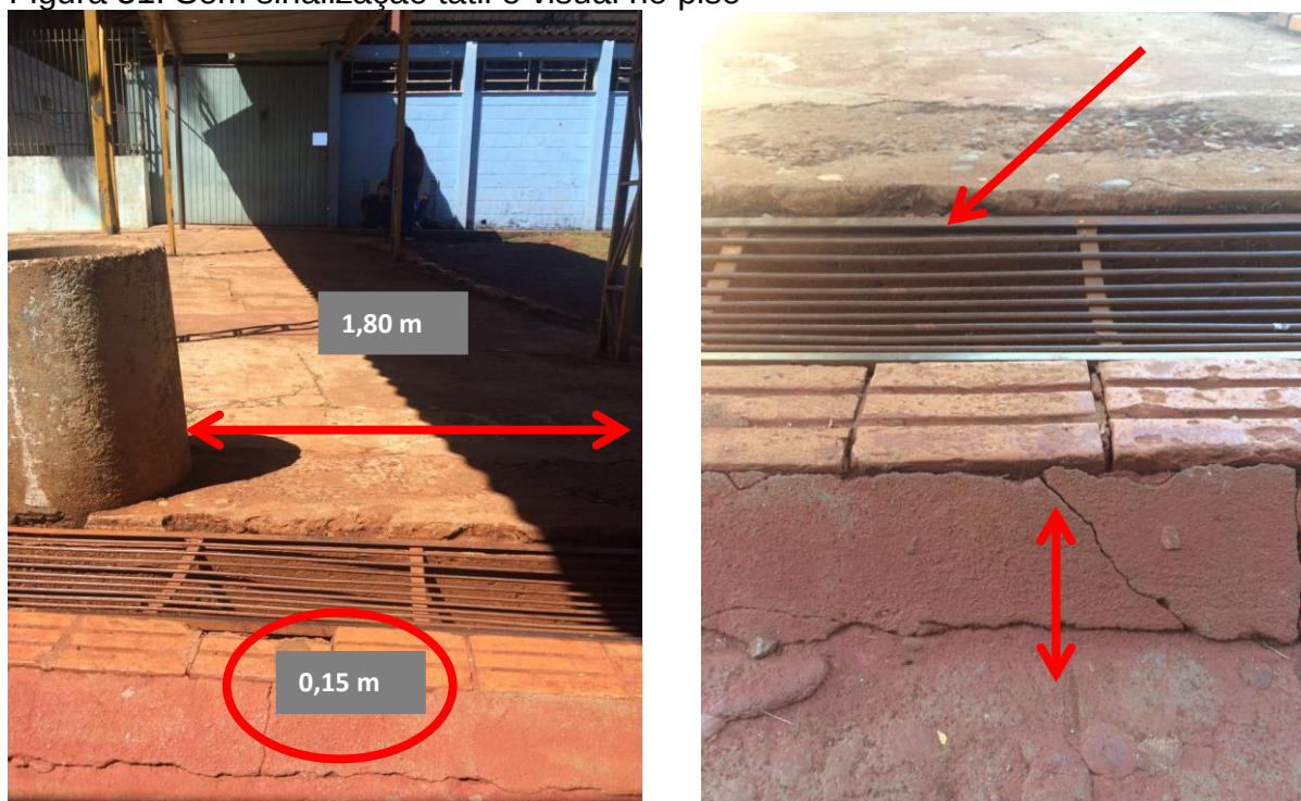
Figura 31: Sem sinalização tátil e visual no piso
