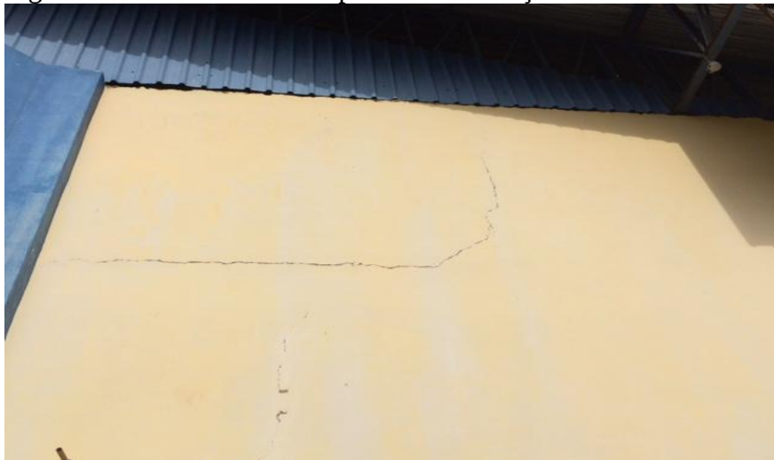
Figura 224 - Fissura causada pela movimentação térmica da estrutura
