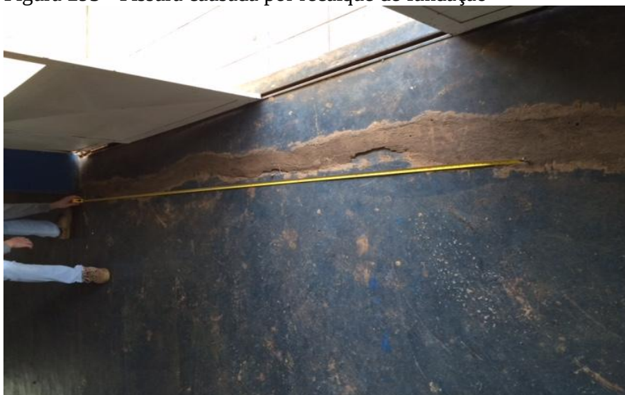
Figura 293 - Fissura causada por recalque de fundação
