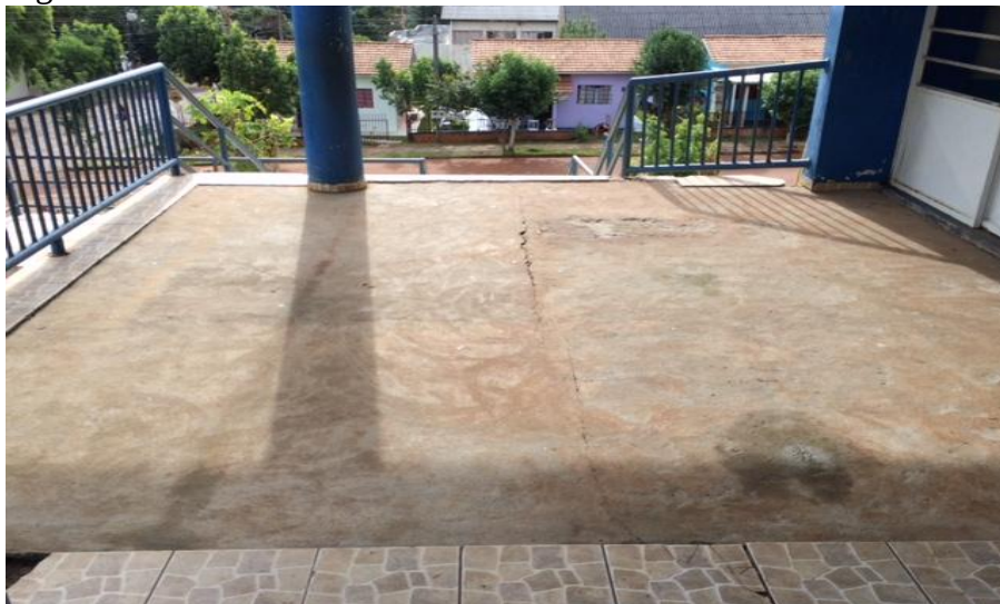
Figura 271 - Destacamento do revestimento cerâmico.
