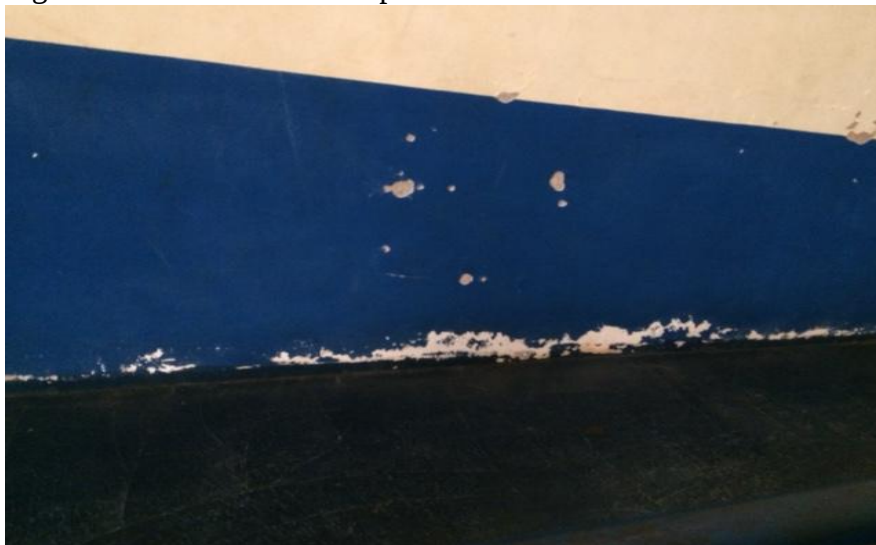
Figura 327 - Descascamento pintura devido à umidade ascendente.
