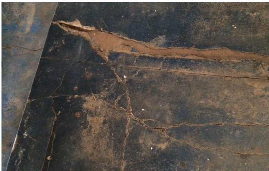
Figura 282 - Fissuras causadas pela acomodação do solo
