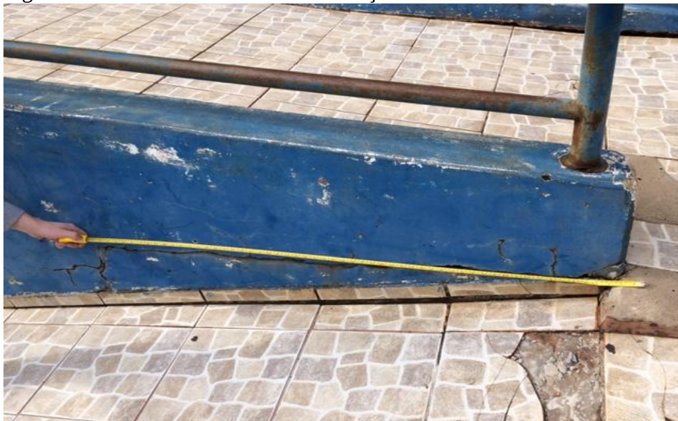
Figura 235 - Fissura oriunda da acomodação do solo
