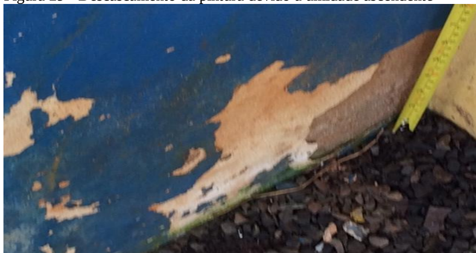
Figura 29 - Descascamento da pintura devido à umidade ascendente
