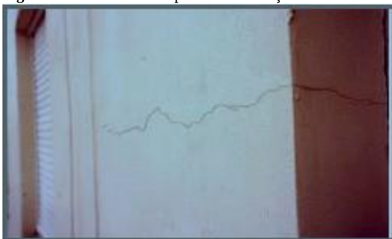
Figura 6 - Fissura causada pela movimentação térmica
