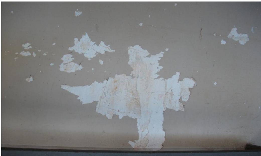
Figura 14 - Descascamento de tinta em parede
