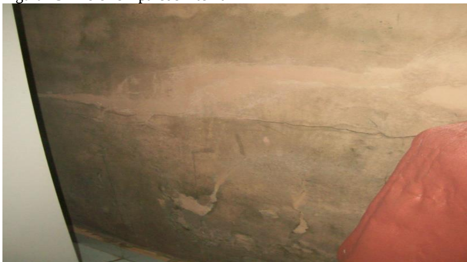
Figura 13 - Bolor em parede interna
