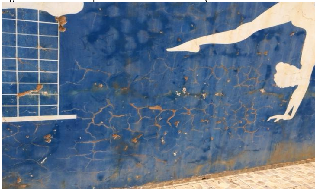
Figura 19 - Fissuras mapeadas na fachada da edificação
