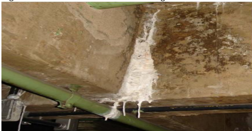
Figura 12 - Eflorescência no encontro de vigas
