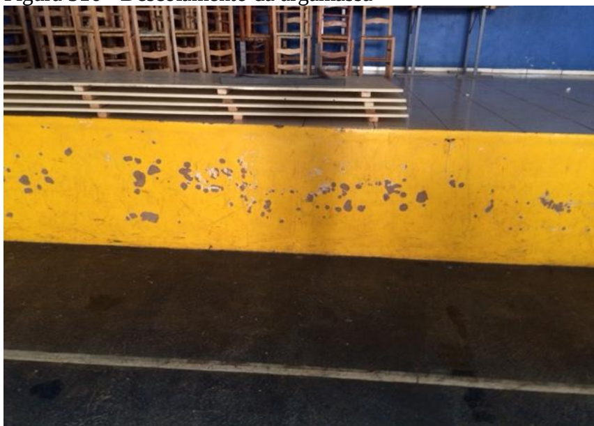
Figura 316 - Descolamento da argamassa
