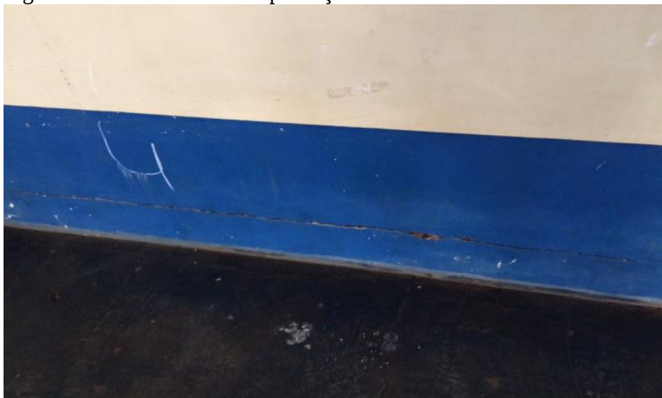
Figura 305 - Fissura causada pela ação da umidade
