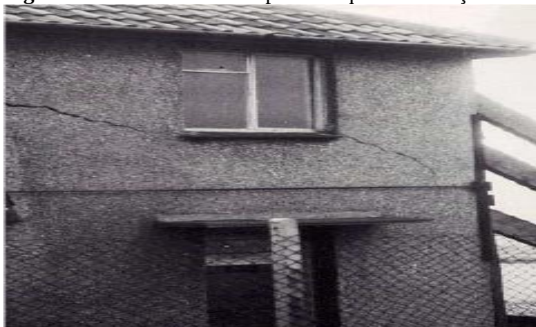
Figura 9 - Fissuras causadas por recalque de fundação
