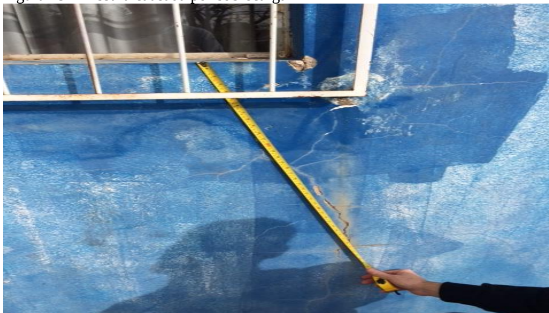
Figura 191- Fissura causada por sobrecarga
