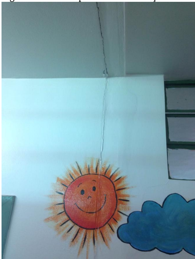
Figura 12 - Trincas por falta de amarração da alvenaria
