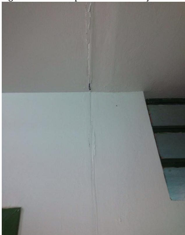
Figura 13 - Trincas por falta de amarração da alvenaria
