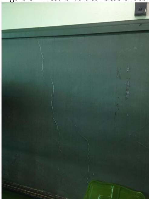
Figura 9 - Fissura vertical ocasionada por sobrecarga na parte central do quadro
