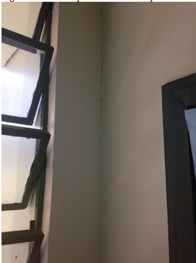
Figura 14 - Trincas por falta de amarração da alvenaria
