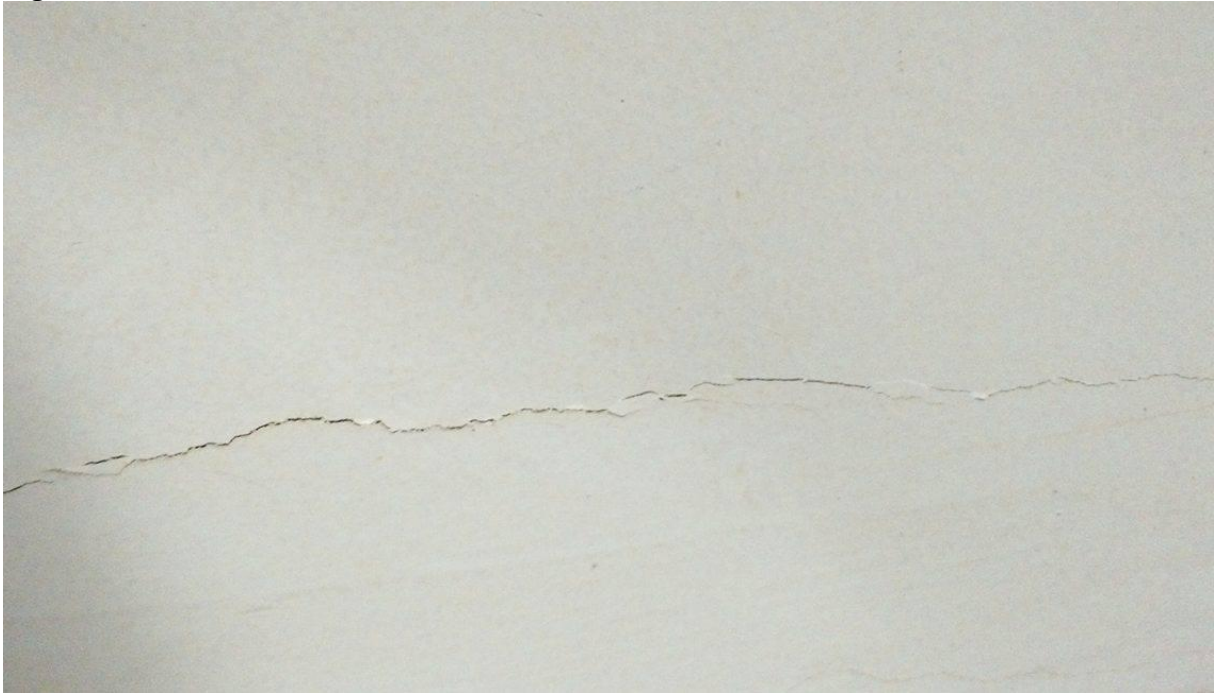
Figura 5 - Fissura da Tinta
