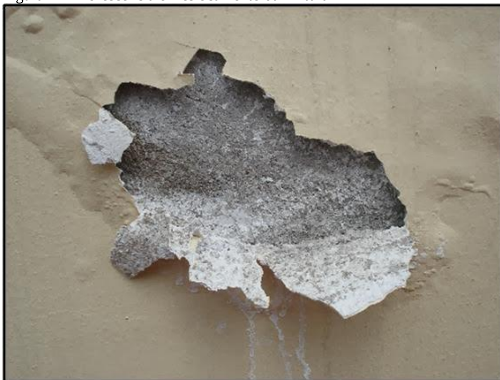
Figura 4 - Eflorescência e Deslocamento da Pintura
