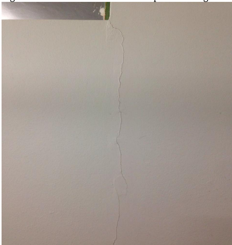
Figura 8 - Fissura vertical ocasionada por sobrecarga ao lado direito, inferior da janela
