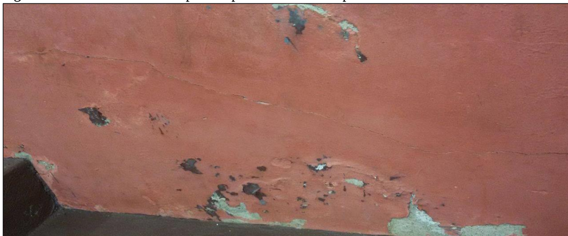
Figura 23 – Descascamento da pintura próximo à base da parede.
