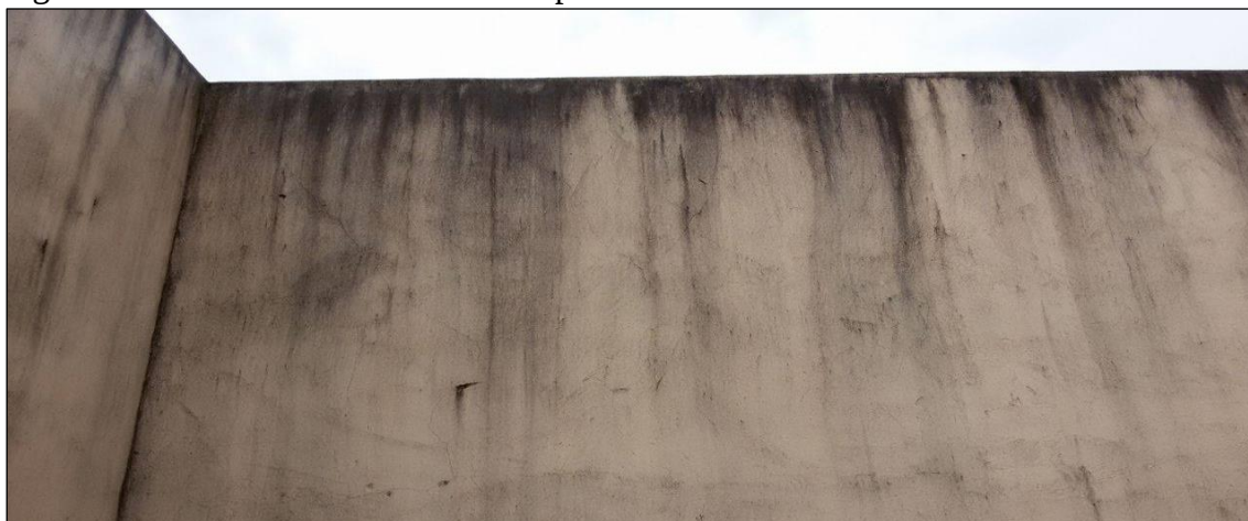
Figura 20 – Manchas de umidade no topo dos muros.
