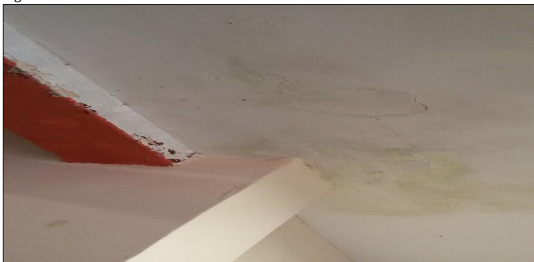
Figura 21 – Manchas de umidade no teto.
