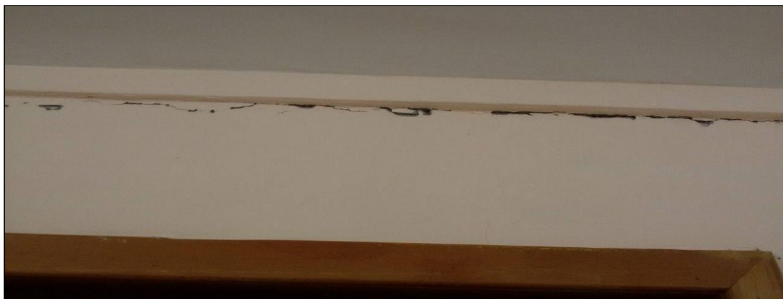
Figura 14 – Fissura resultante da dilatação térmica da laje superior.
