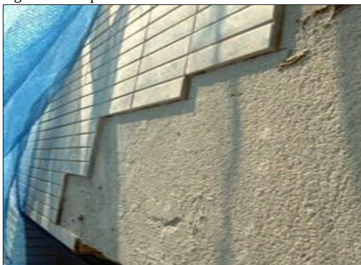
Figura 6 – Desplacamento do revestimento cerâmico.
