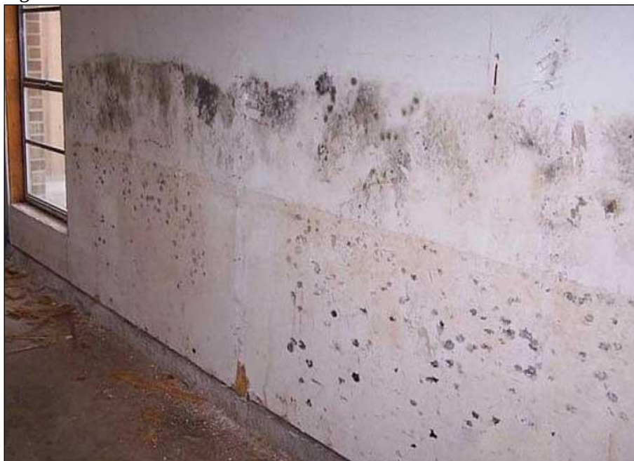
Figura 3 – Manchas de umidade.
