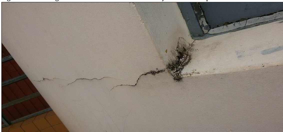
Figura 15 – Patologia resultante da ausência de inclinação mínima do peitoril.
