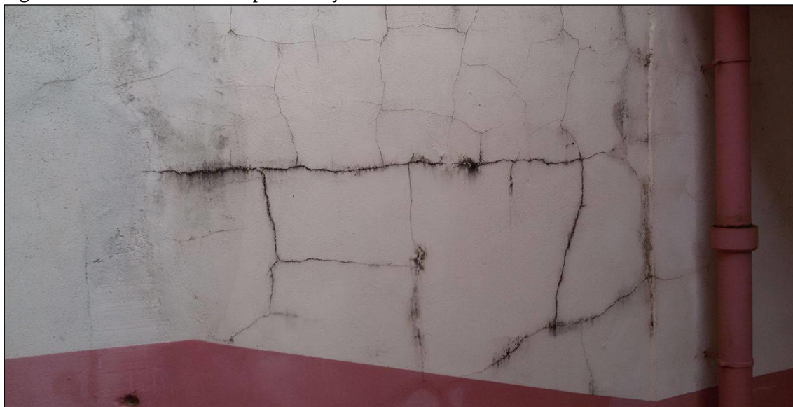
Figura 13 – Fissuras causadas pela retração.
