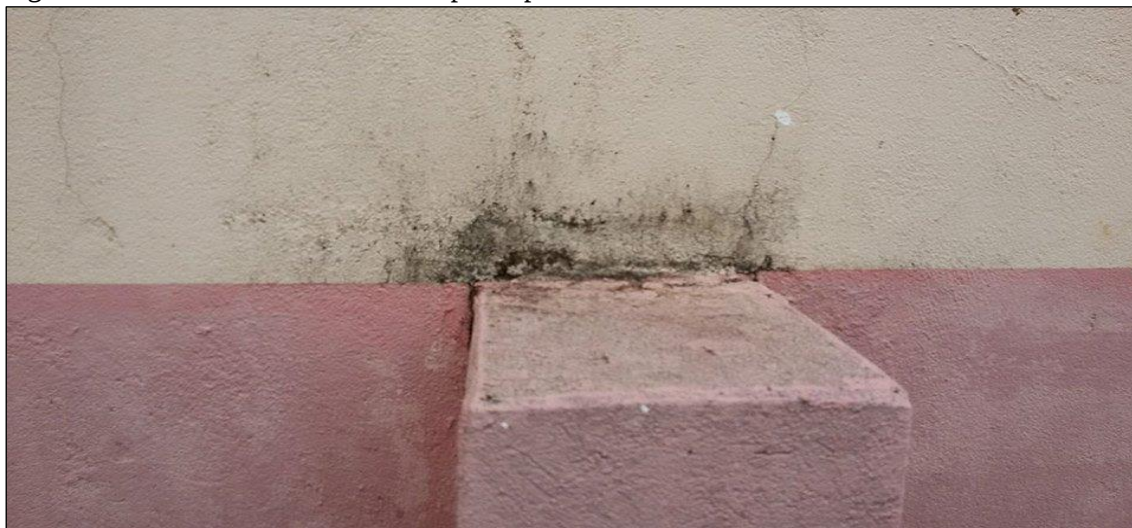
Figura 22 – Mancha de umidade no topo do pilarete.
