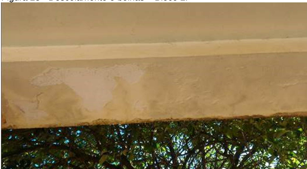
Figura 28 - Descolamento e bolhas – Bloco 2.
