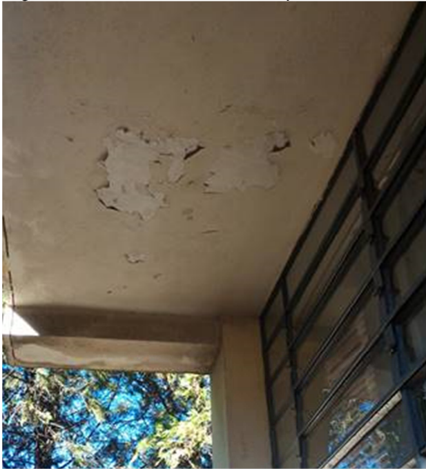
Figura 27 - Descascamento na pintura do teto do Bloco 2.
