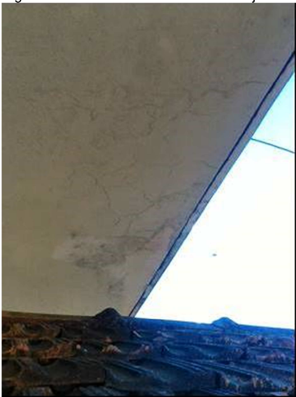
Figura 24 - Manchas de umidade na laje do Bloco 2.
