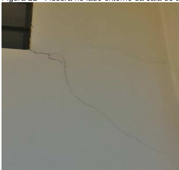
Figura 21 - Fissura no lado externo da sala de aula.
