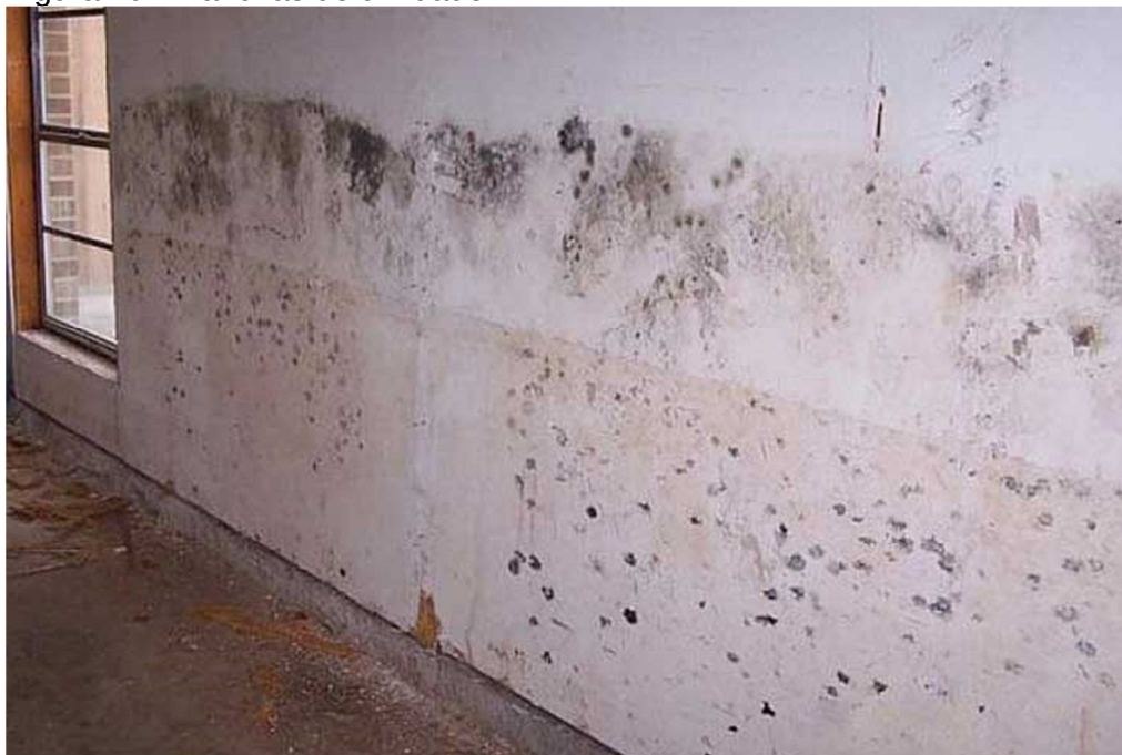
Figura 10 - Manchas de umidade.
