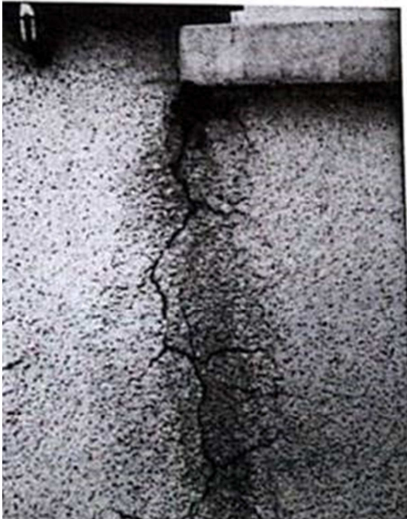
Figura 8 - Fluxo de água interceptado no peitoril da janela.
