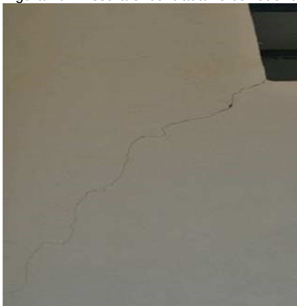
Figura 20 - Fissura encontrada no corredor de acesso às salas.
