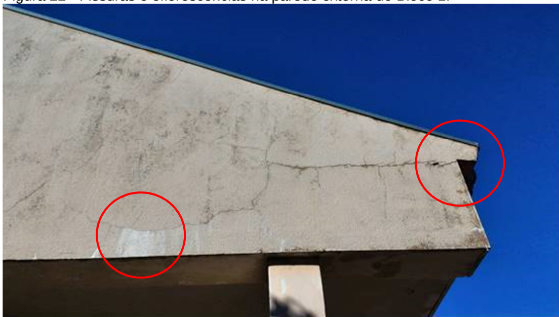
Figura 22 - Fissuras e eflorescências na parede externa do Bloco 1.
