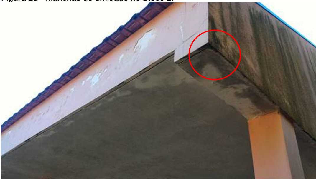
Figura 25 - Manchas de umidade no Bloco 1.
