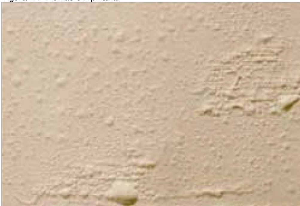
Figura 12 - Bolhas em pintura.
