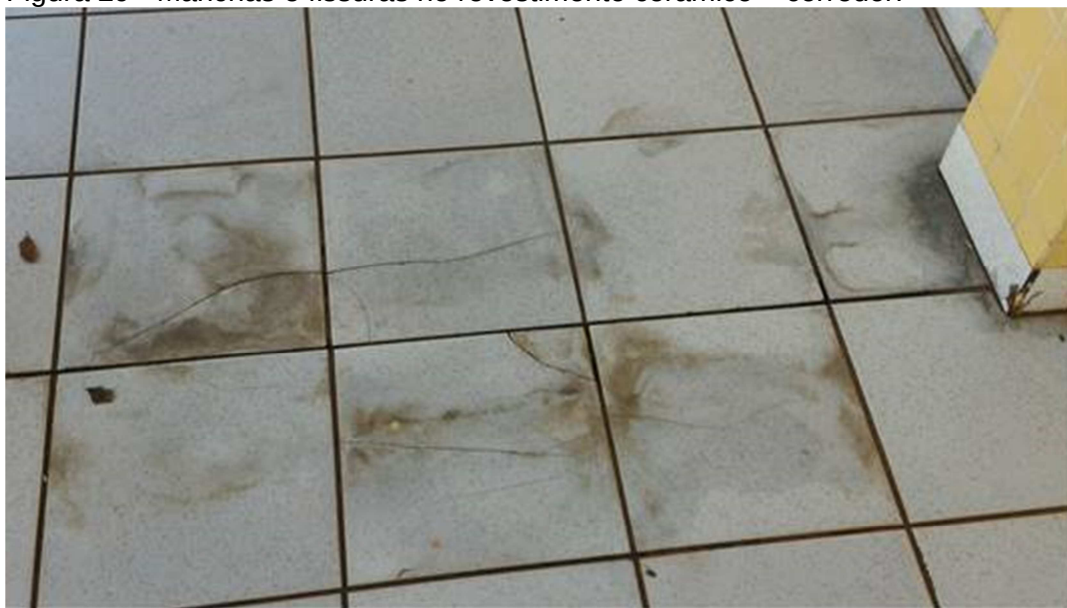
Figura 29 - Manchas e fissuras no revestimento cerâmico – corredor.
