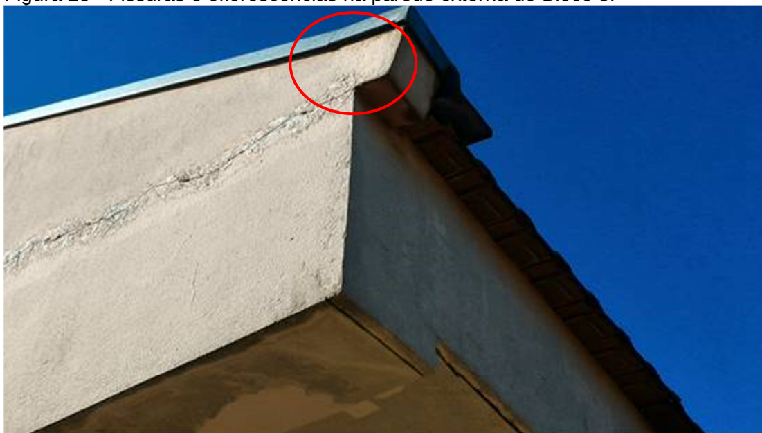
Figura 23 - Fissuras e eflorescências na parede externa do Bloco 3.
