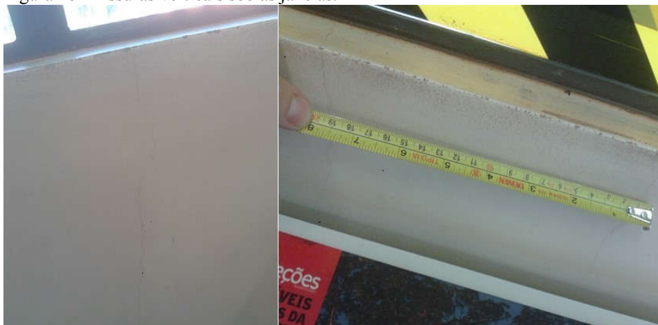
Figura 28 - Fissuras verticais sob as janelas.
