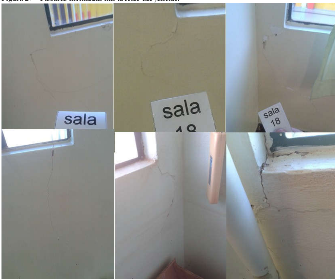
Figura 27 - Fissuras inclinadas nas arestas das janelas.
