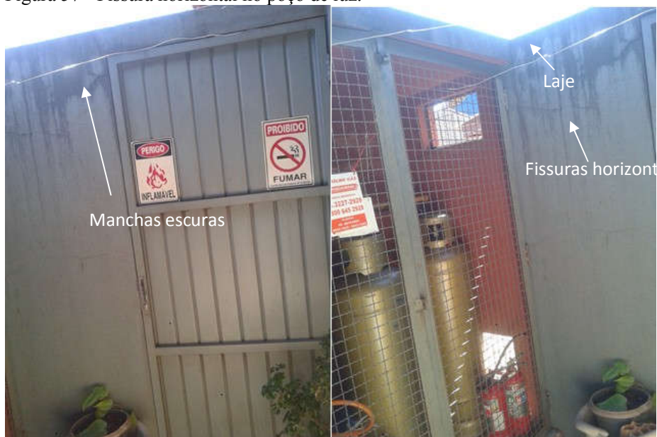
Figura 57 - Fissura horizontal no poço de luz.
