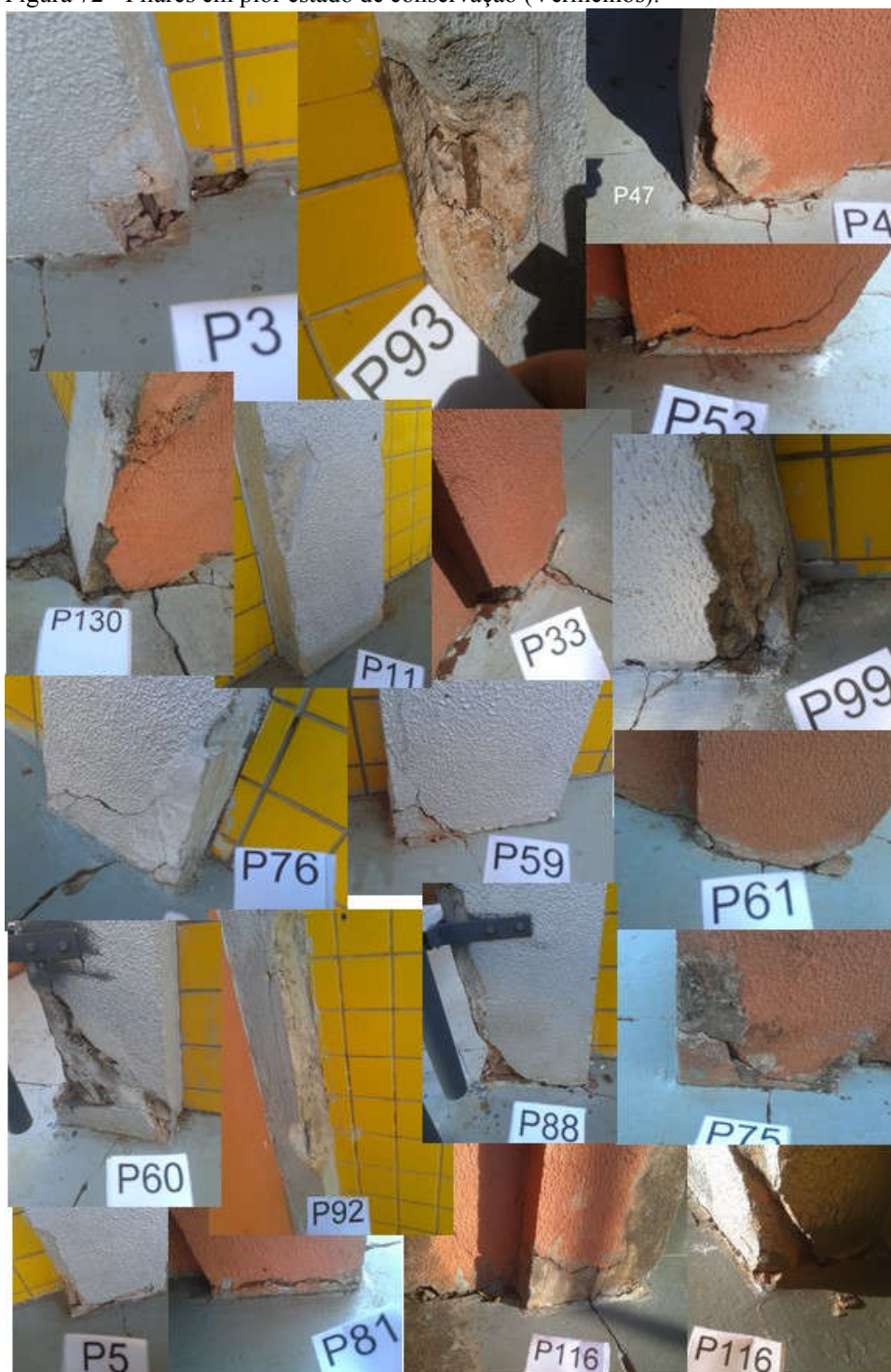
Figura 72 - Pilares em pior estado de conservação (Vermelhos).
