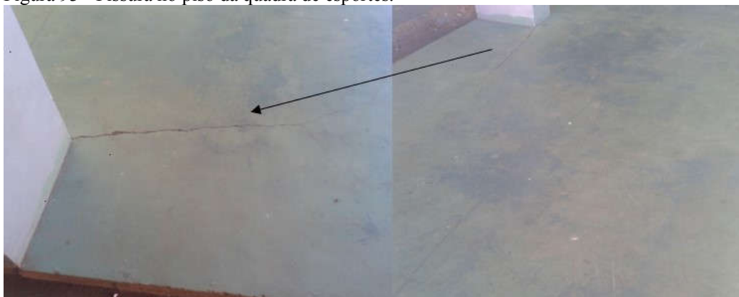
Figura 93 - Fissura no piso da quadra de esportes.
