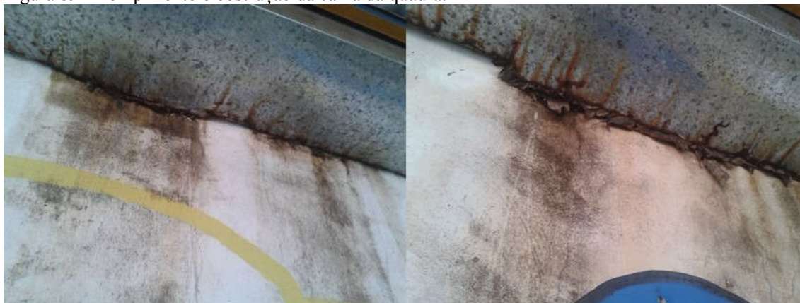
Figura 89 - Rompimento e obstrução da calha da quadra.
