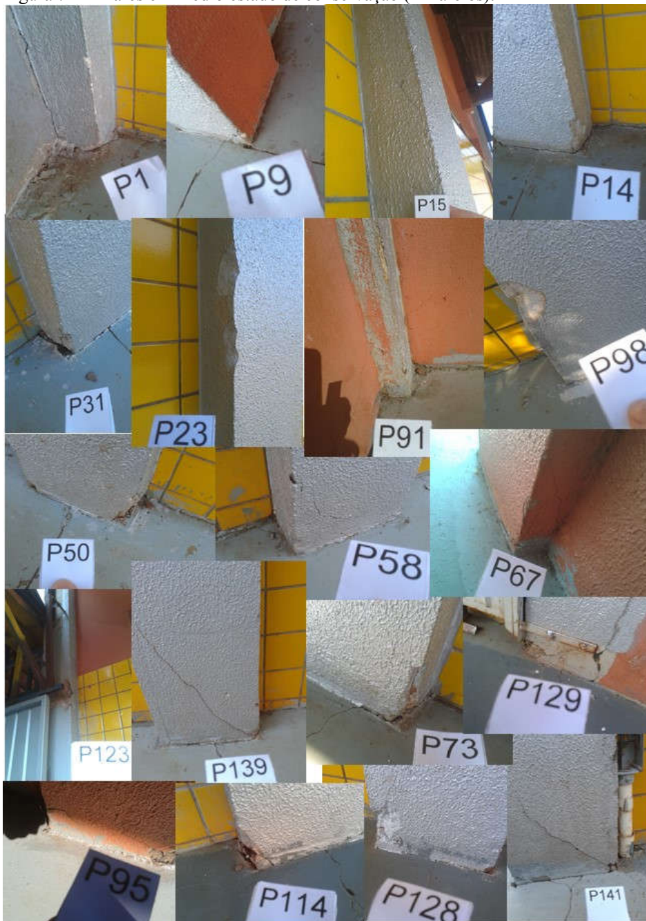
Figura 71 - Pilares em médio estado de conservação (Amarelos).
