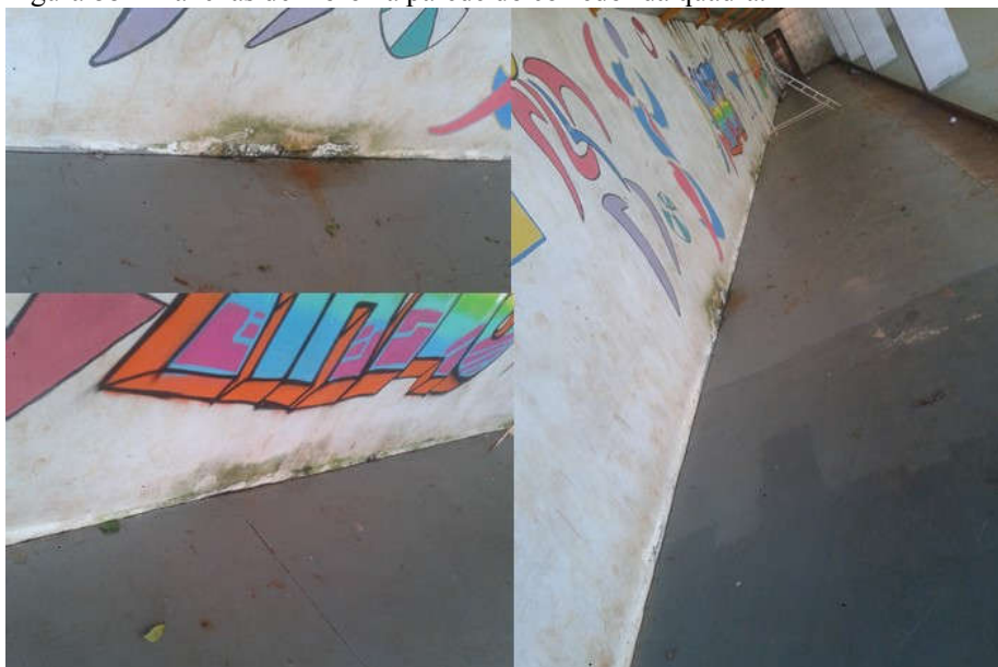
Figura 88 - Manchas de mofo na parede do corredor da quadra.
