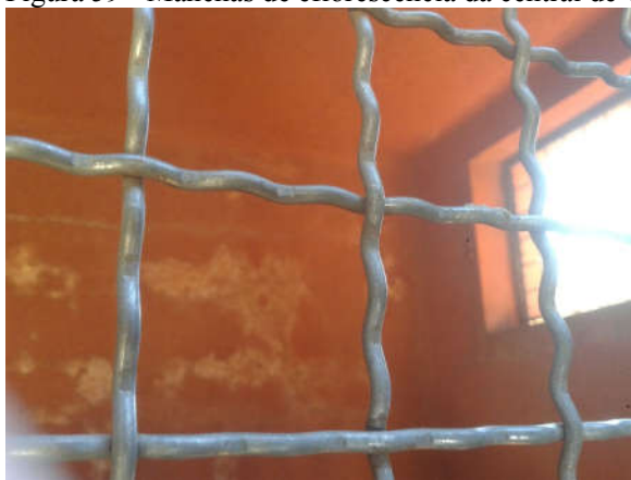
Figura 59 - Manchas de eflorescência da central de GLP.
