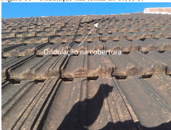
Figura 86 - Ondulação nas telhas do bloco 5.
