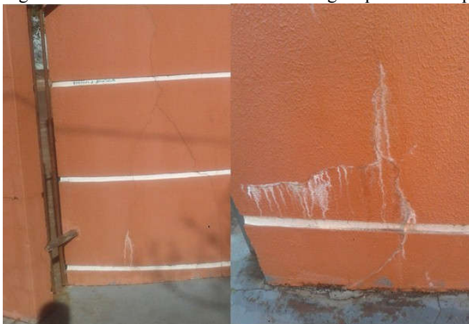
Figura 41- Manchas de eflorescência na região posterior do portal.
