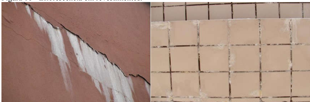
Figura 16 - Eflorescência em revestimentos.
