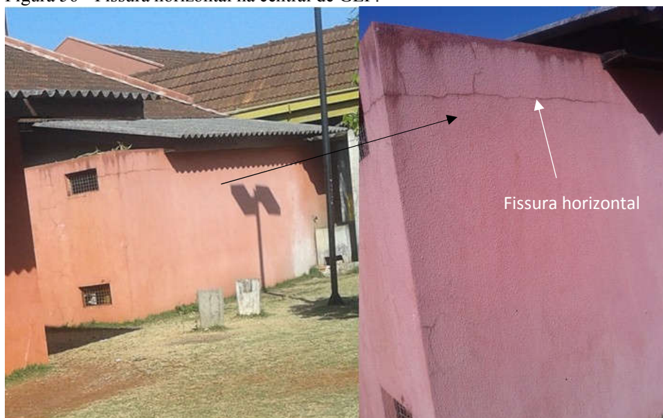
Figura 56 - Fissura horizontal na central de GLP.
