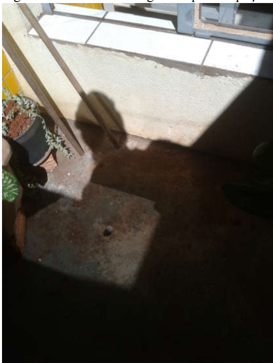
Figura 60 - Falta de drenagem no piso do poço de luz.
