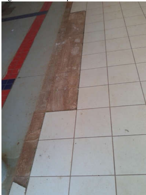
Figura 67- Falha do piso cerâmico do hall de entrada.
