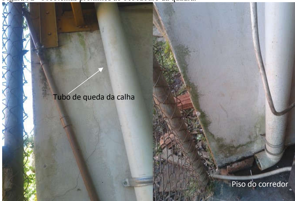
Figura 92 - Problemas próximos ao bebedouro da quadra.
