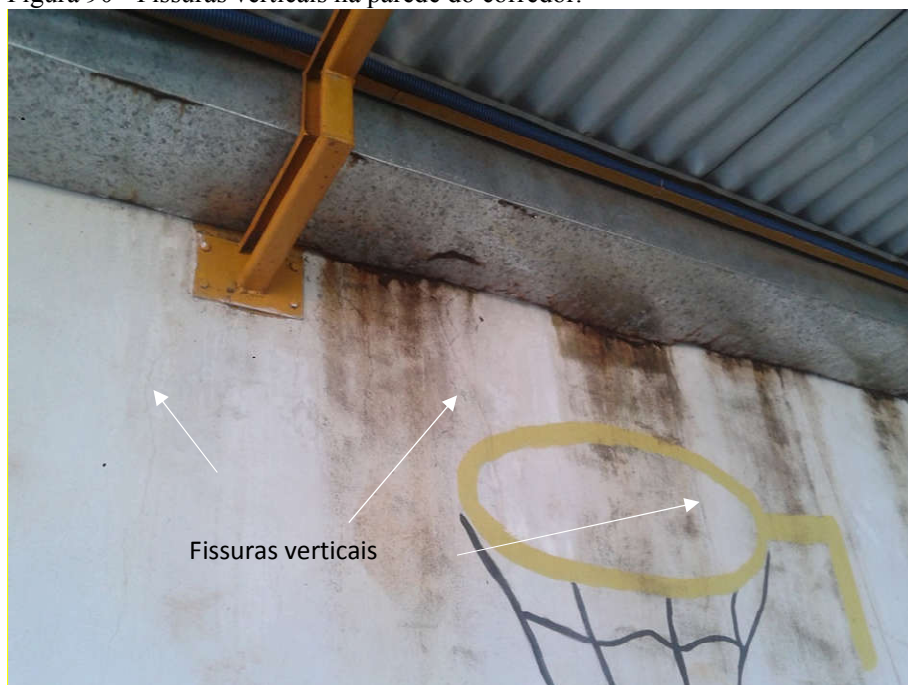
Figura 90 - Fissuras verticais na parede do corredor.
