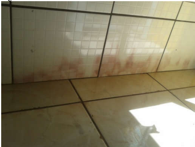
Figura 61 - Manchas no revestimento cerâmico no refeitório dos funcionários.
