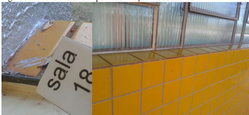
Figura 30 - Deficiência na impermeabilização das aberturas.
