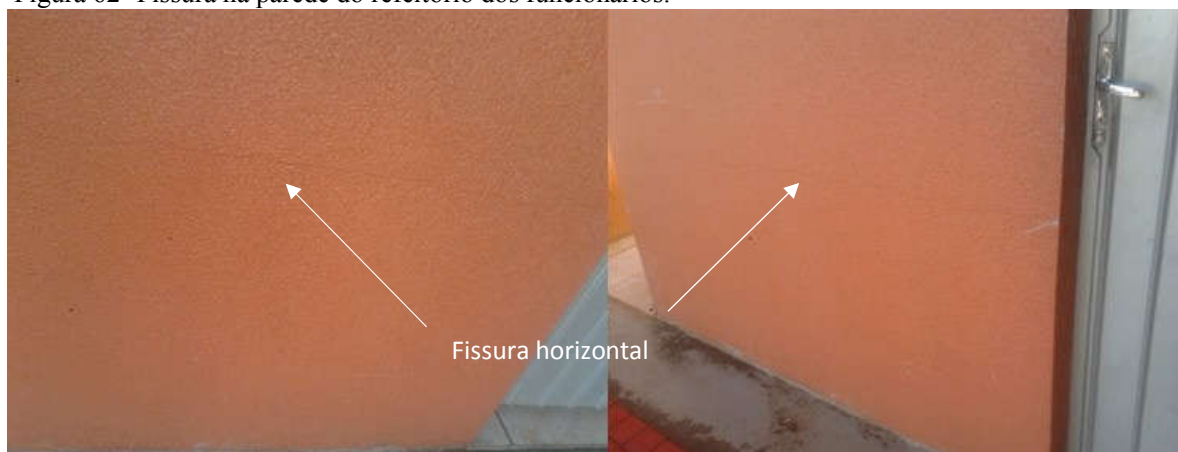
Figura 62- Fissura na parede do refeitório dos funcionários.
