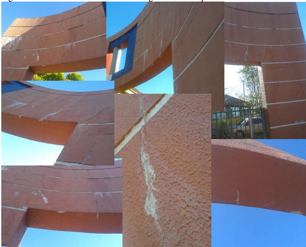
Figura 42 - Manchas de eflorescência na região frontal do portal.
