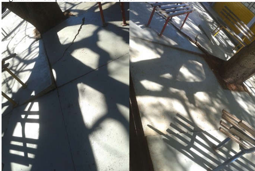
Figura 79 - Calçada com deformações.
