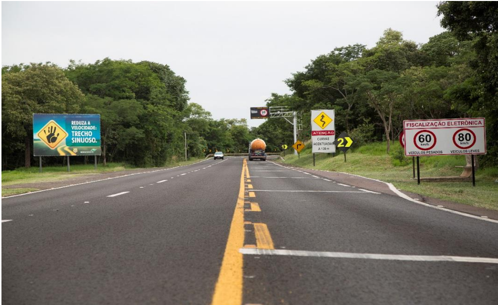
Figura 17 – Sinalização Horizontal e Vertical
