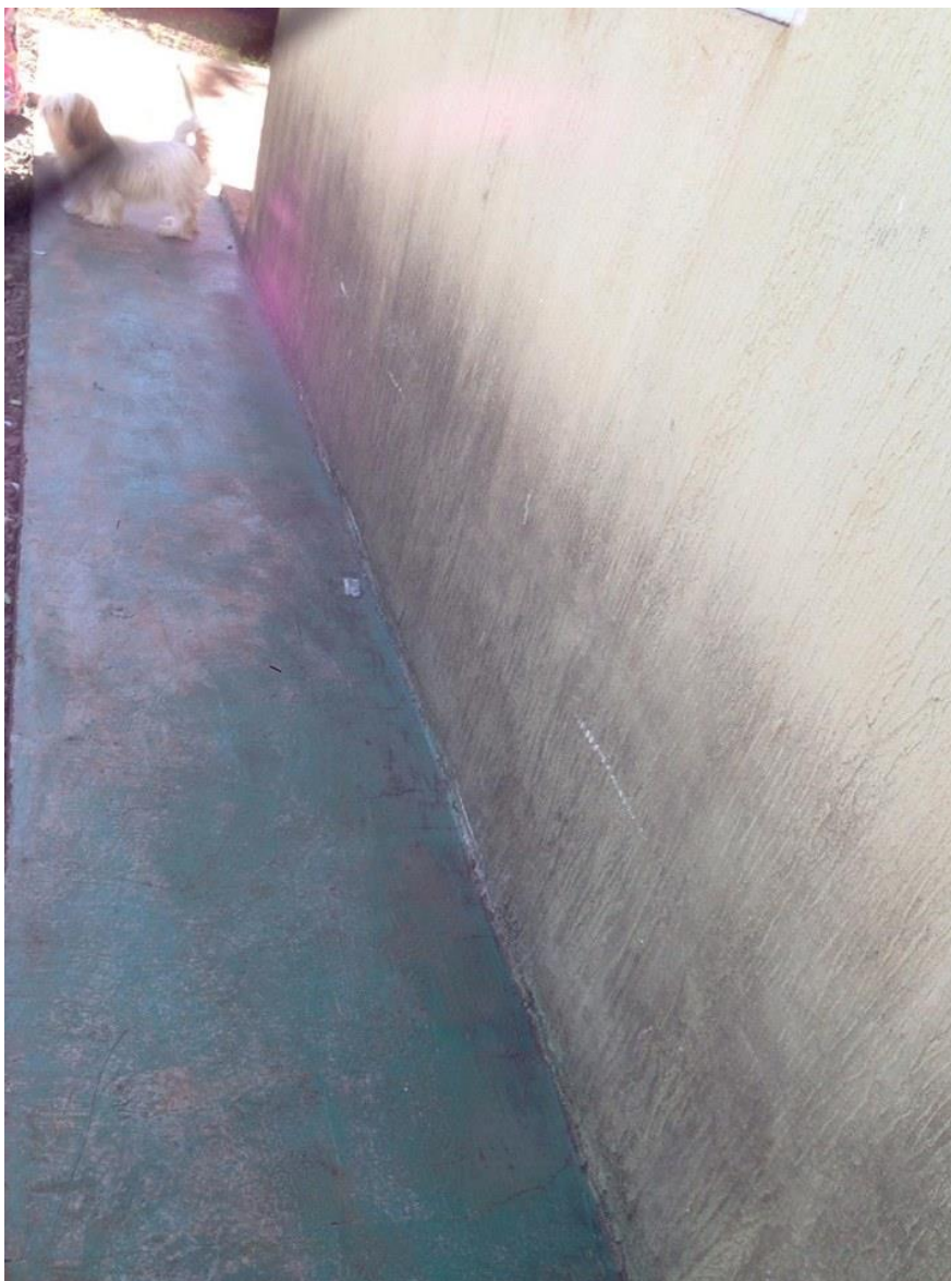
Figura 27: Superfície com mofo.
