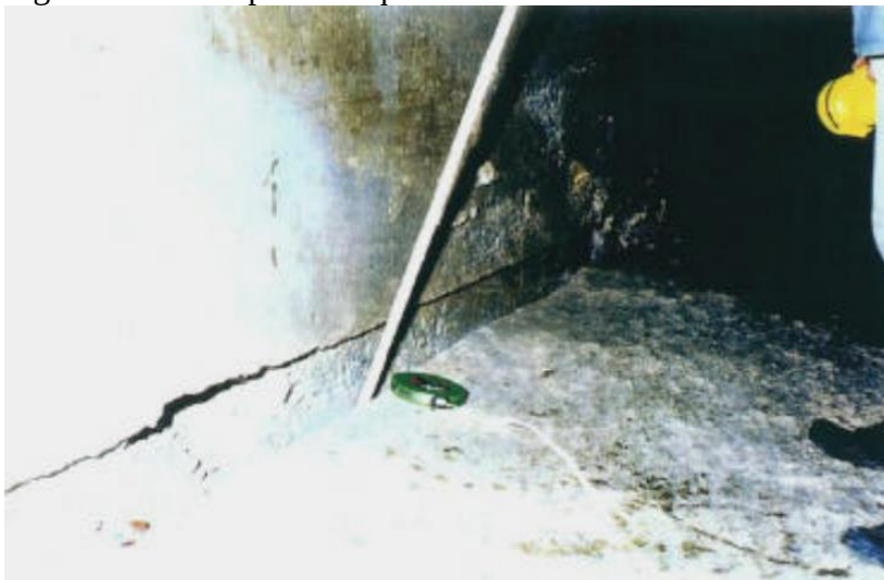
Figura 5: Fissura por recalque.
