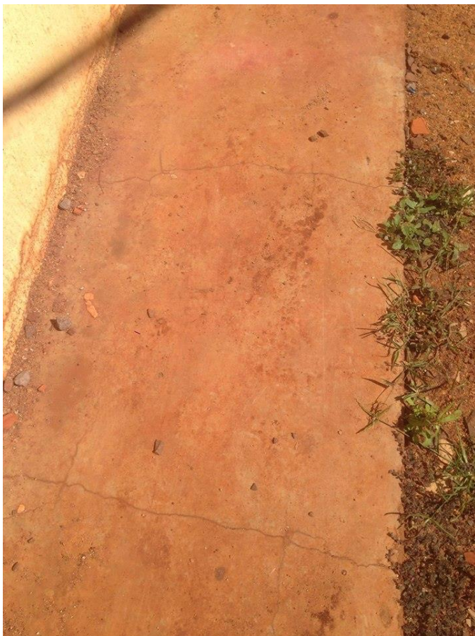
Figura 24: Fissuras nas calçadas.
