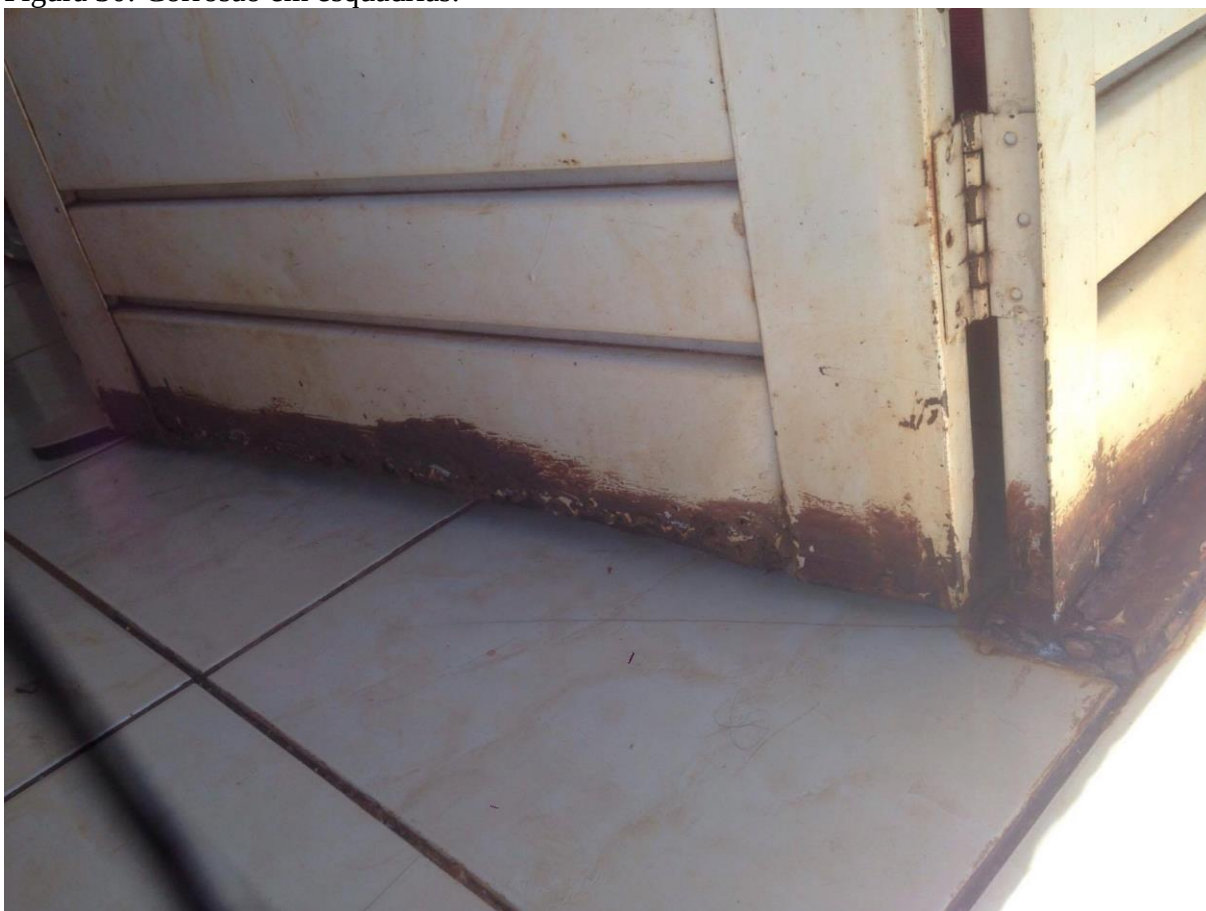
Figura 30: Corrosão em esquadrias.
