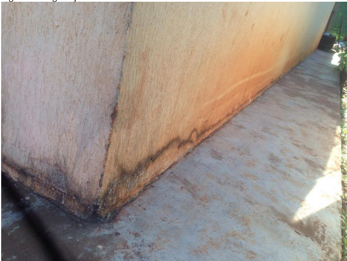
Figura 31: Degradação do concreto.
