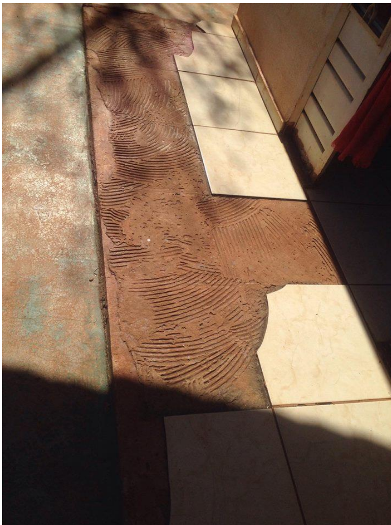
Figura 26: Deslocamento de revestimentos.
