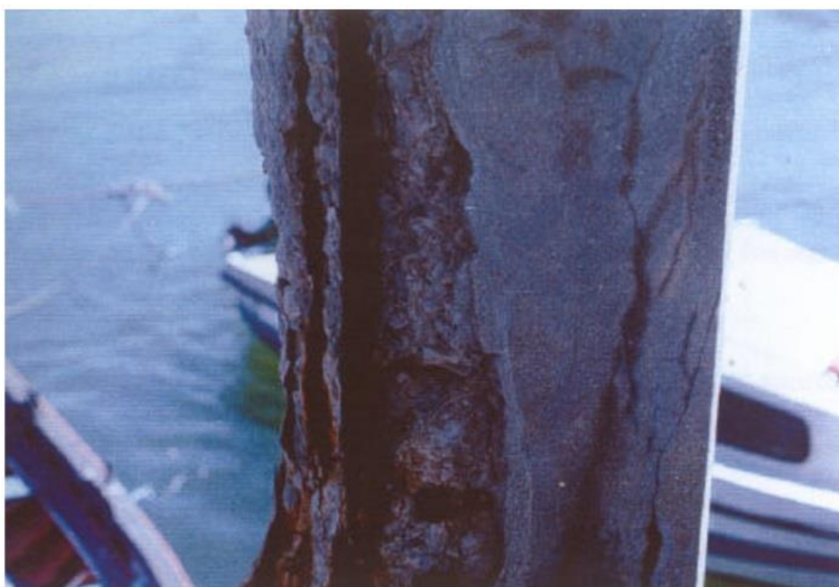
Figura 6: Corrosão do concreto armado.
