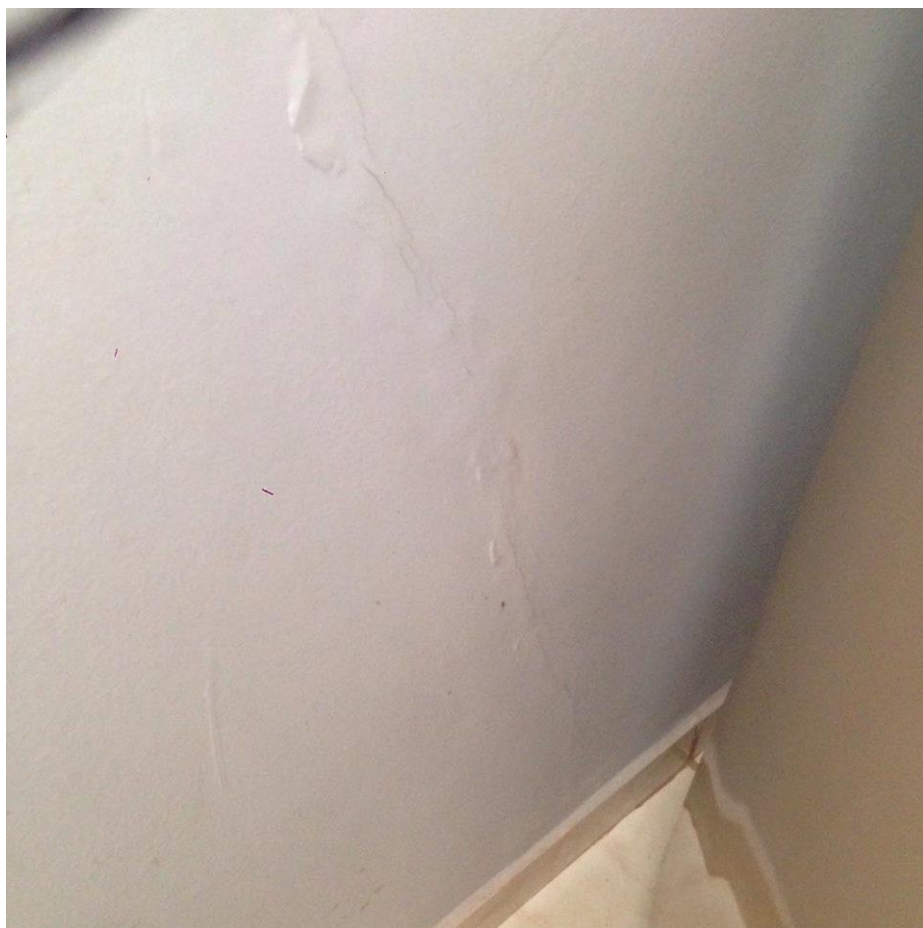
Figura 29: Desagregação da Pintura.
