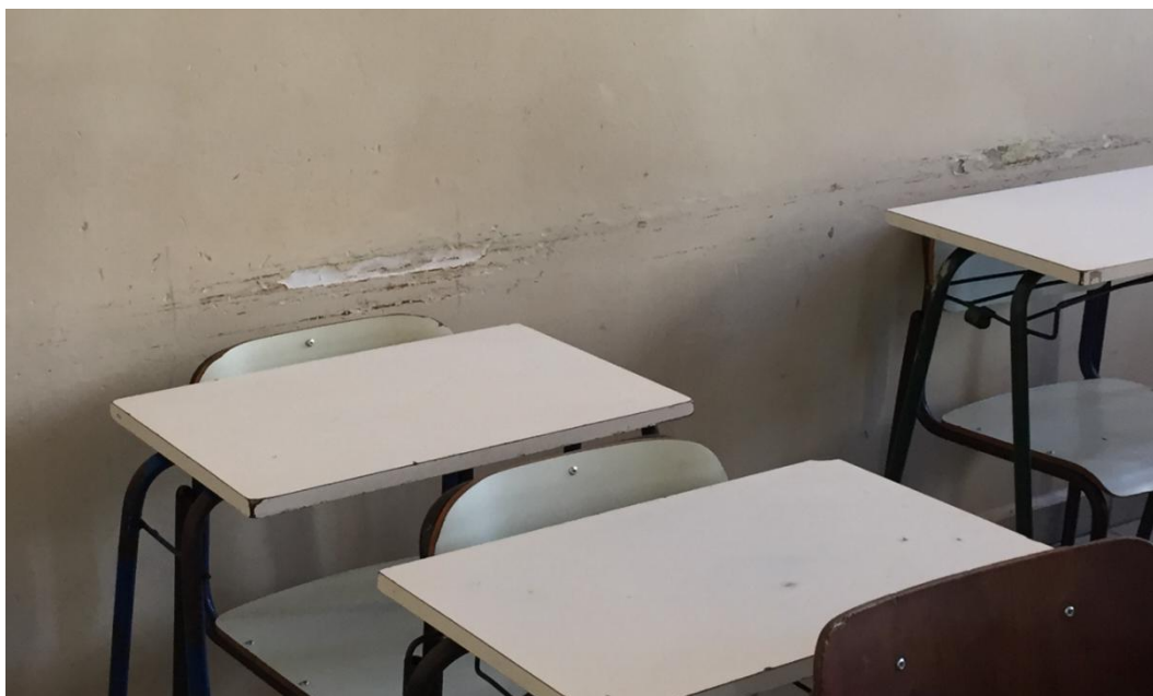
Figura 25 – Desgaste dos revestimentos da parede pelo atrito das carteiras
