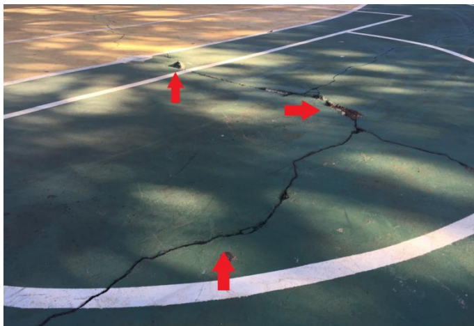
Figura 18 – Trincas na quadra poliesportiva devido a processo de dilatação térmica e adensamento
