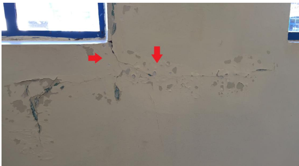
Figura 10 – Trincas e fissuras nos peitoris das janelas
