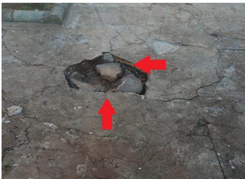
Figura 17 – Agravamento da manifestação patológica devido ao adensamento pela infiltração nas trincas
