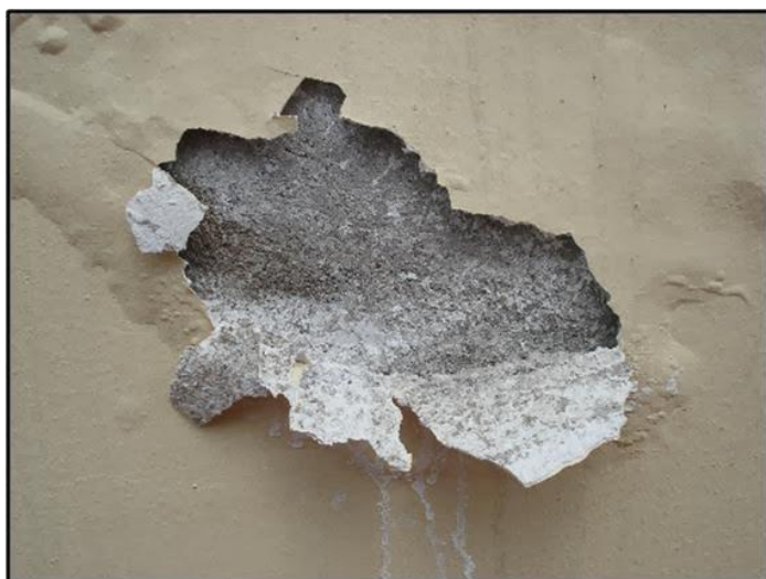
Figura 04 - Configuração eflorescência em revestimento
