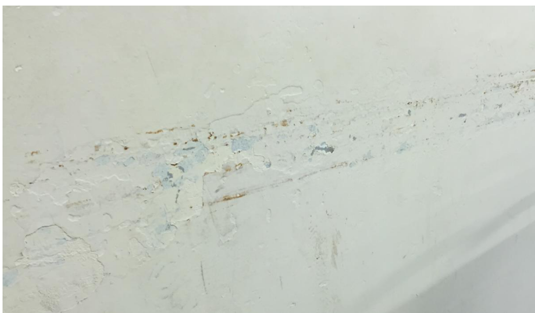
Figura 26 – Desgaste dos revestimentos da parede pelo atrito das carteiras
