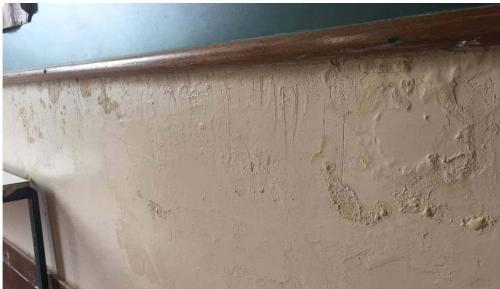
Figura 20 - Bolhas e eflorescência na região da parede interna do auditório
