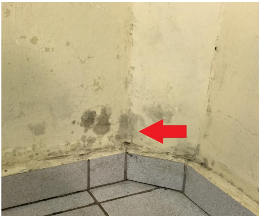
Figura 24 – Manchas escuras nos revestimentos das paredes
