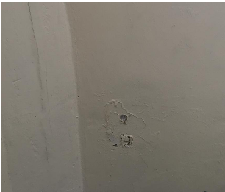
Figura 21 – Manifestação de eflorescência e descascamento do revestimento
