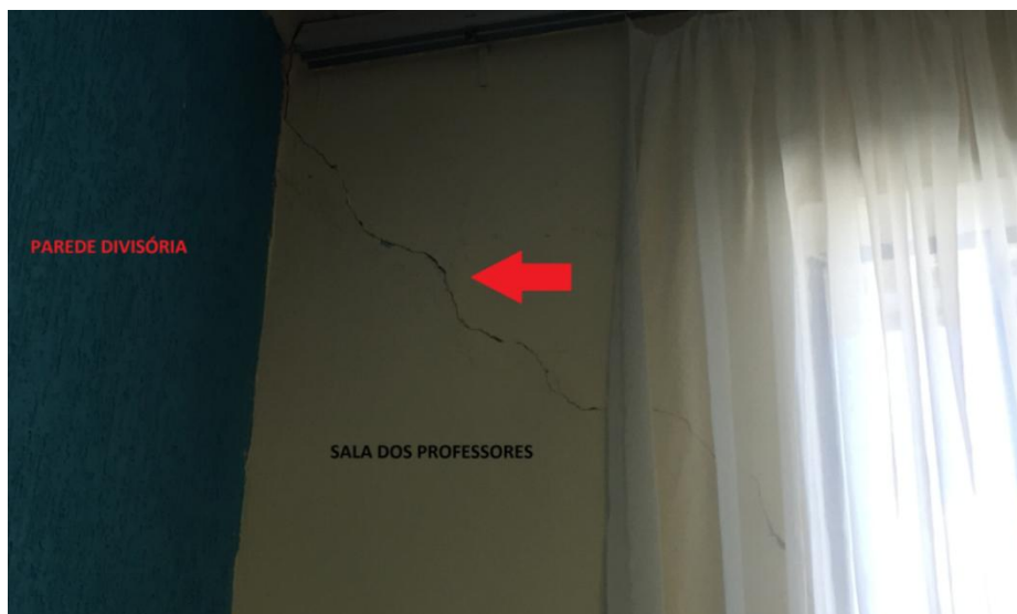
Figura 08 - Trinca na parede interna sala dos professores
