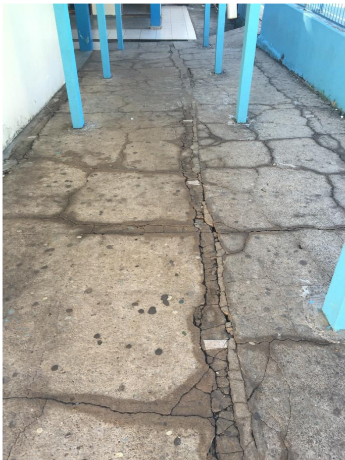
Figura 16 - Trincas e fissuras nos corredores externos
