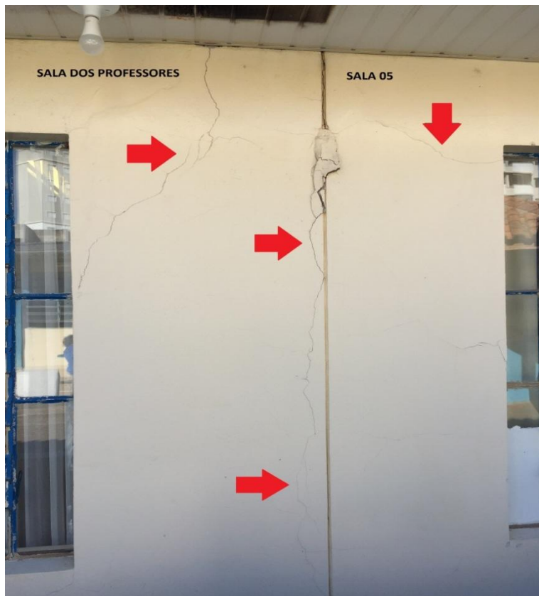
Figura 07 - Trincas na parede externa sala dos professores divisa com sala 05
