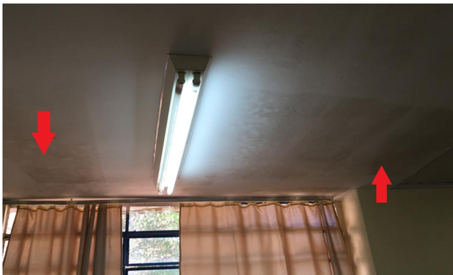
Figura 23 – Manchas escuras nos revestimentos das lajes
