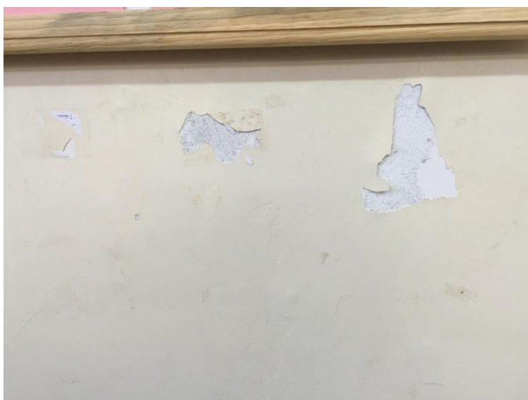
Figura 22 – Manifestação de eflorescência e descascamento do revestimento
