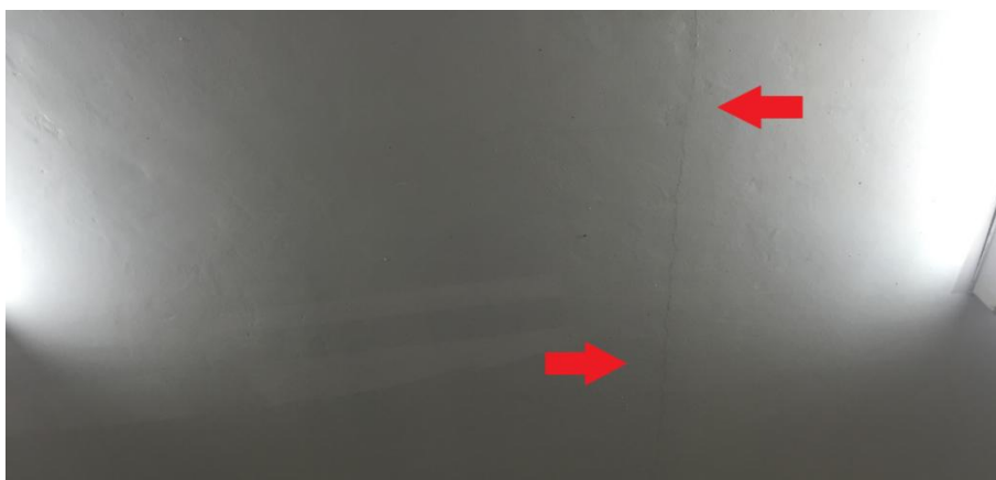
Figura 14 – Fissura horizontal na laje
