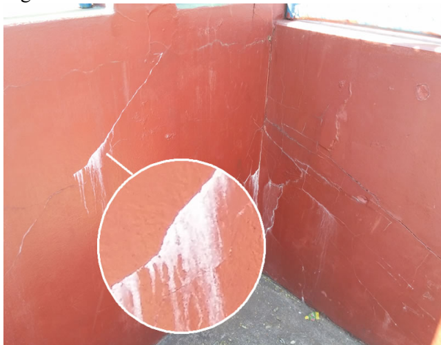
Figura 42 – Eflorescência no muro.
