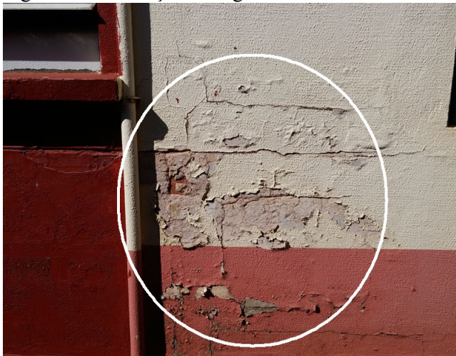
Figura 38 – Retração da argamassa do revestimento.
