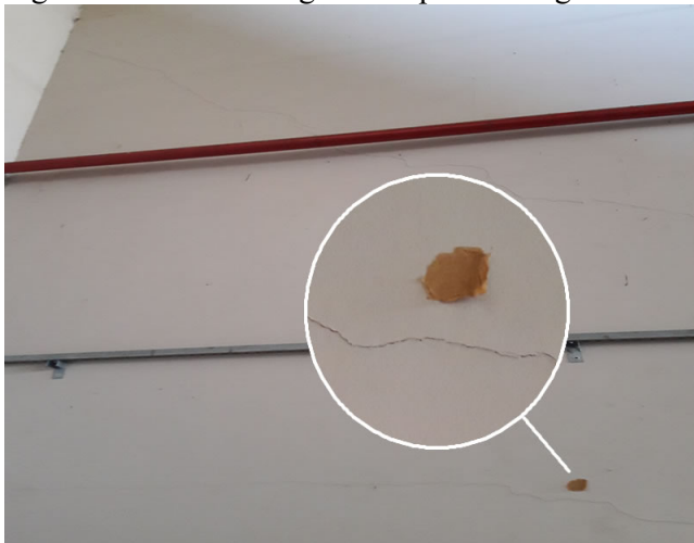
Figura 45 – Trinca diagonal na parede do ginásio.
