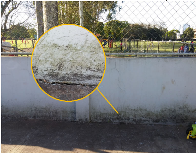
Figura 53 – Manchas de Umidade devido capilaridade na quadra.
