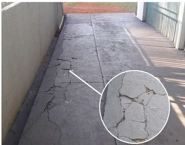
Figura 59 – Trincas no piso.
