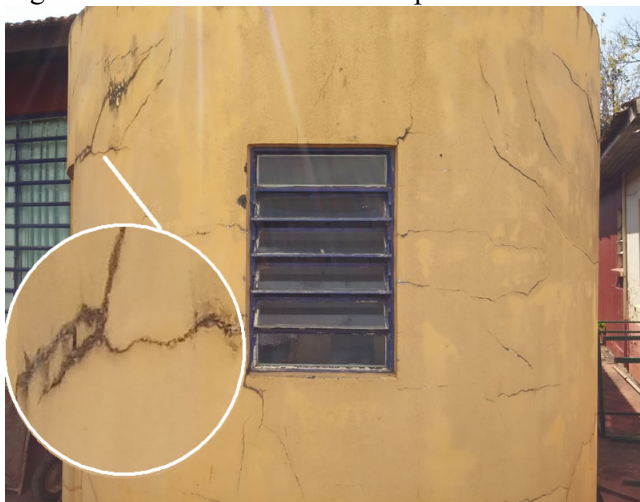
Figura 30 – Trincas e Fissuras na parede externa do banheiro.
