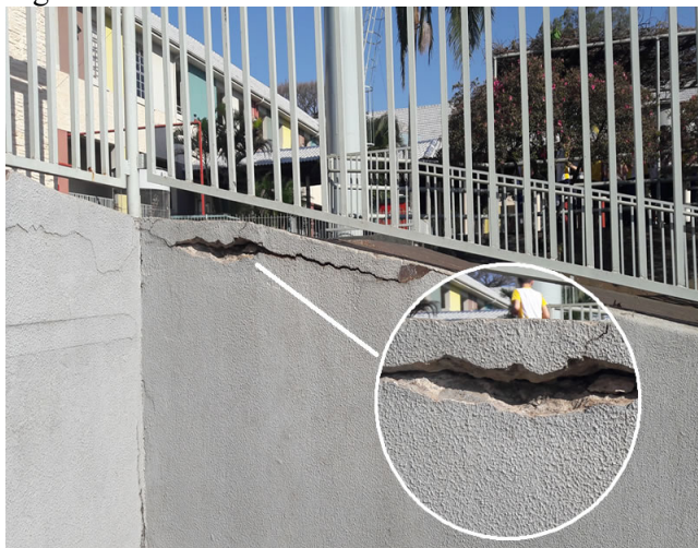
Figura 54 – Fenda no concreto.
