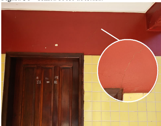
Figura 31 –Trinca sobre abertura.
