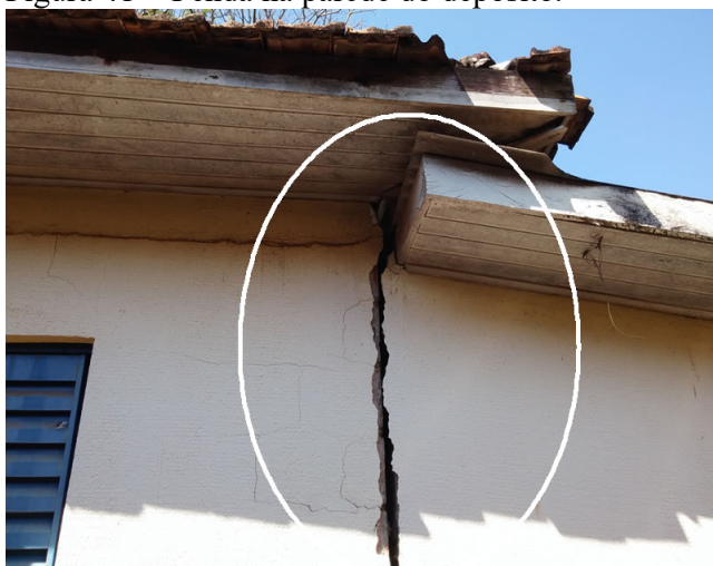
Figura 41 – Fenda na parede do depósito.
