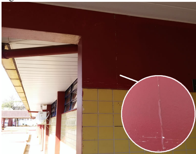
Figura 33 – Fissura vertical entre elementos estruturais.
