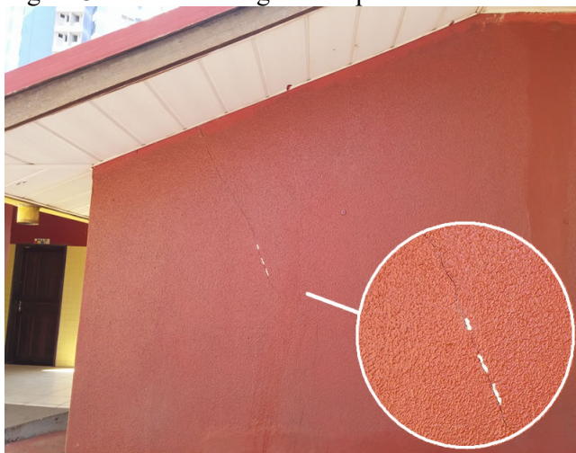
Figura 34 – Fissura diagonal na parede.
