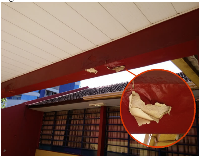
Figura 37 – Descolamento do revestimento.
