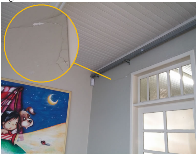
Figura 46 – Trincas e Fissuras sobre abertura.
