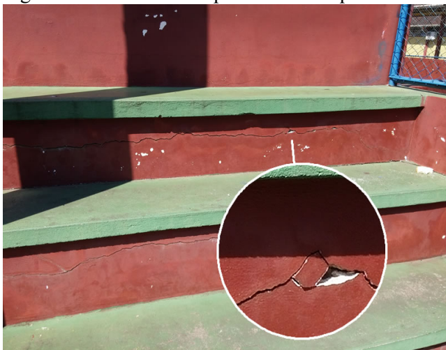
Figura 36 – Trinca na arquibancada da quadra.
