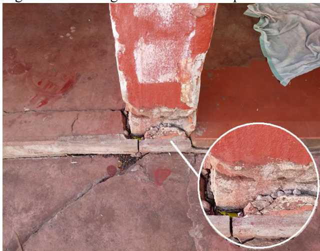
Figura 39 – Esmagamento da base do pilar
