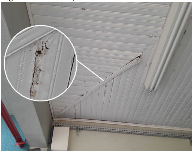
Figura 52 – Infiltração no forro.
