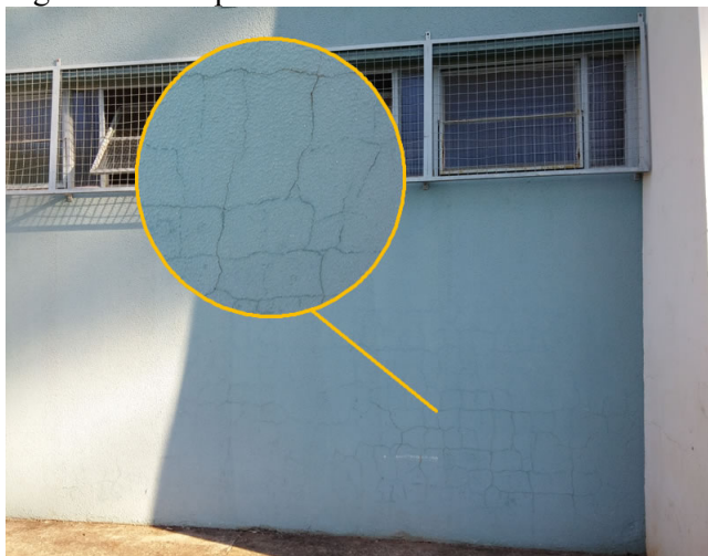
Figura 44 – Mapeamento de Trincas e Fissuras.
