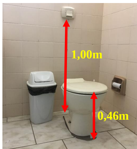
Figura 50 - Bacia sanitária e válvula de descarga
