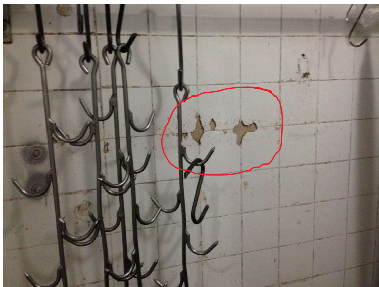
Figura 8: Revestimento cerâmico quebrado no acesso a câmaras frigoríficas
