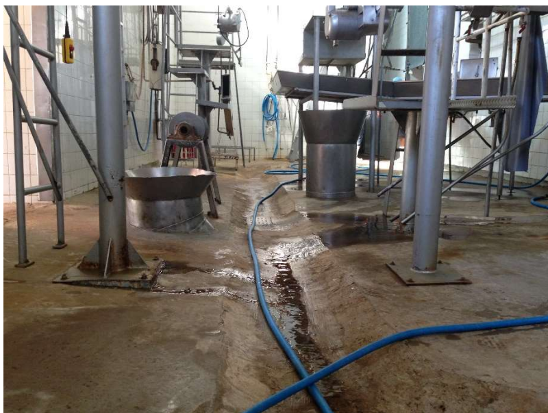
Figura 9: Situação atual do piso da indústria.
