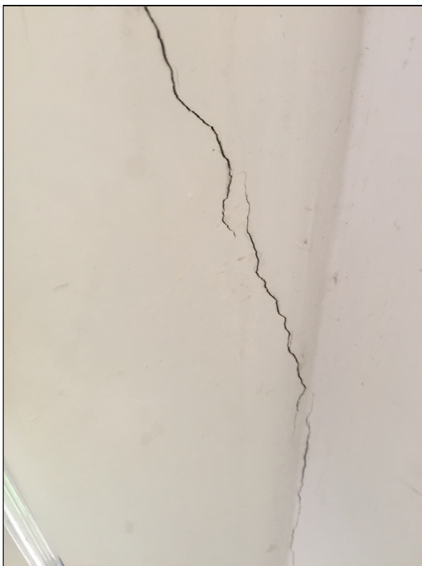
Figura 06 – Exemplo de fissuras em edificações.
