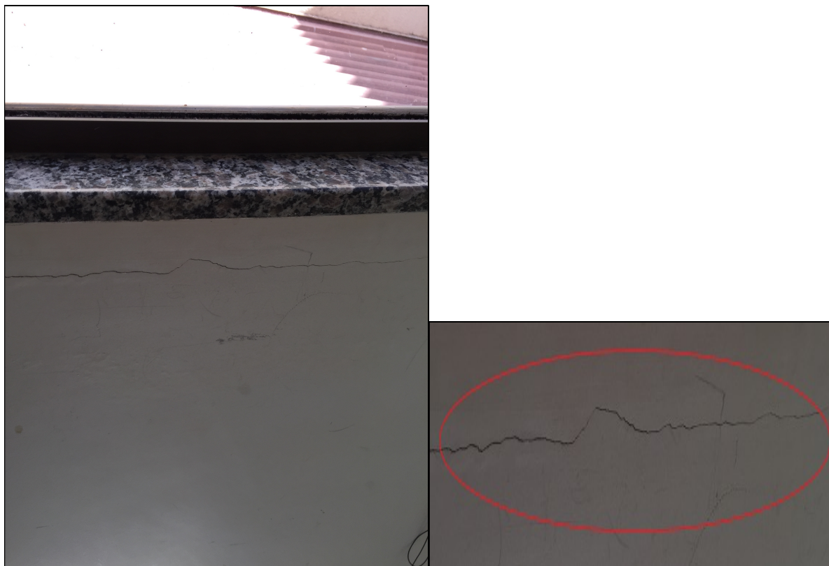
Figura 21 – Fissura abaixo de janela.
