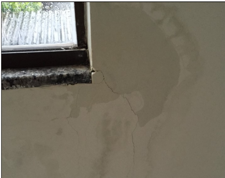
Figura 15 – Fissura em ângulo de 45°.
