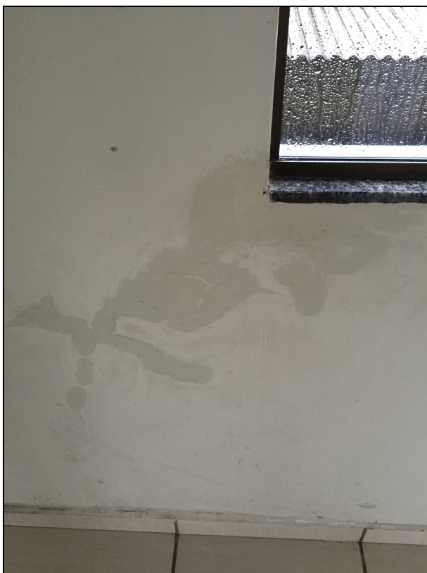
Figura 18 – Patologia ocorrida por infiltração.
