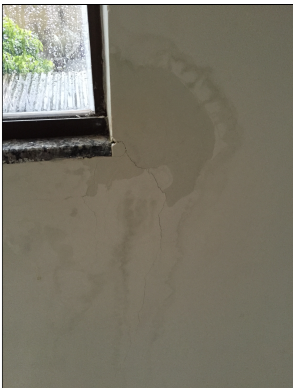
Figura 07 – Infiltração em edificação.
