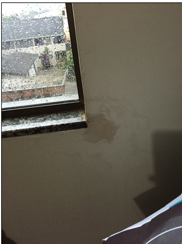
Figura 24 – Patologia por infiltração.
