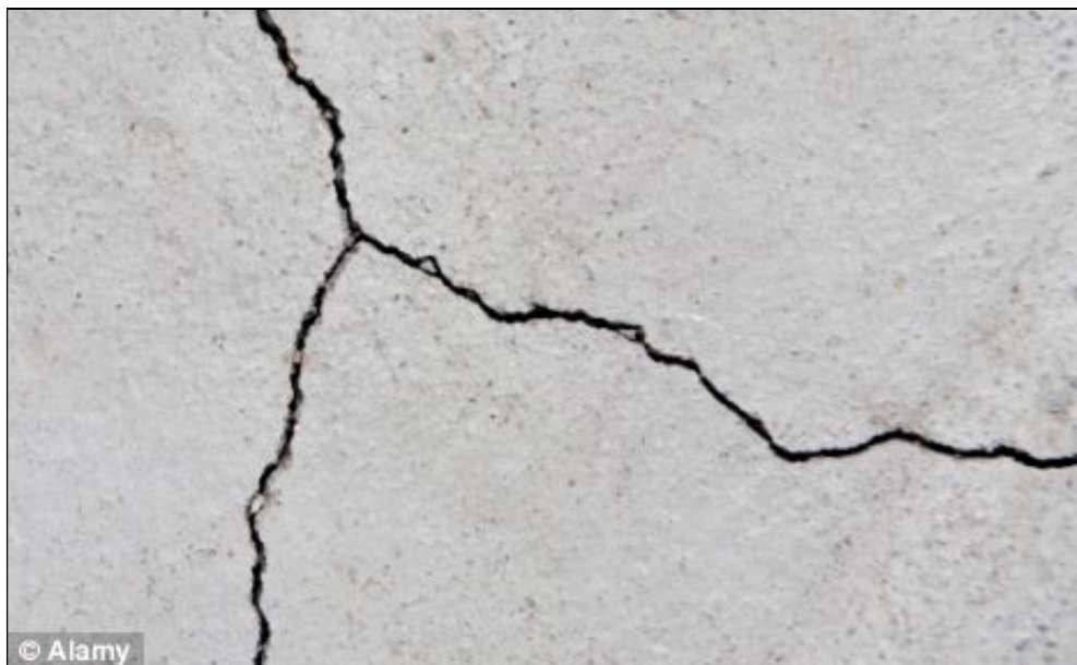
Figura 10 – Fissuras em paredes de concreto.
