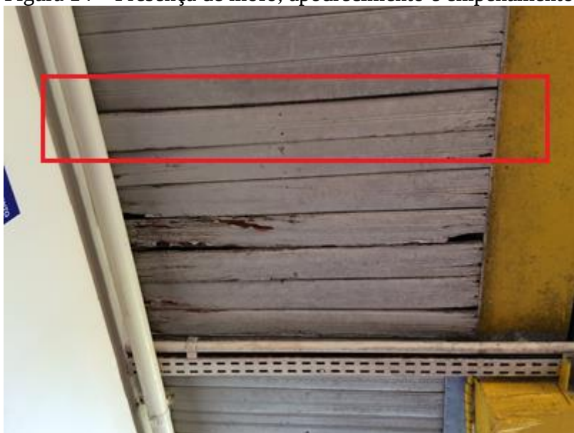
Figura 14 – Presença de mofo, apodrecimento e empenamento longitudinal
