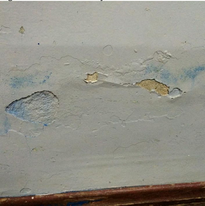
Figura 28 – Descolamento junto com reboco
