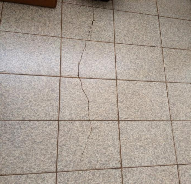
Figura 25 – Trinca no revestimento cerâmica
