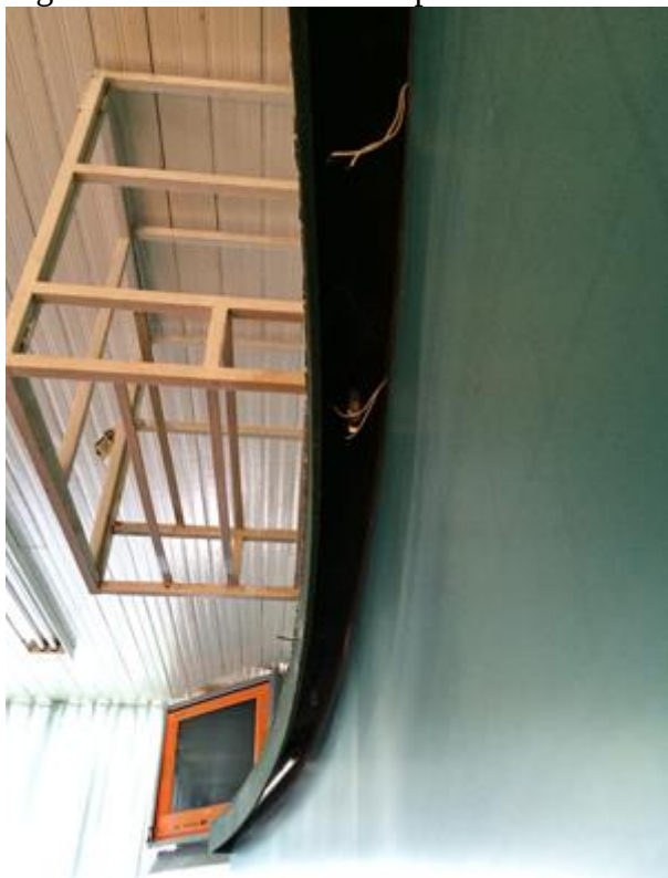
Figura 42 – Ausência de lâmpadas
