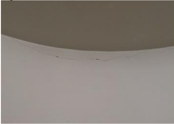
Figura 36 – Ausência de encunhamento
