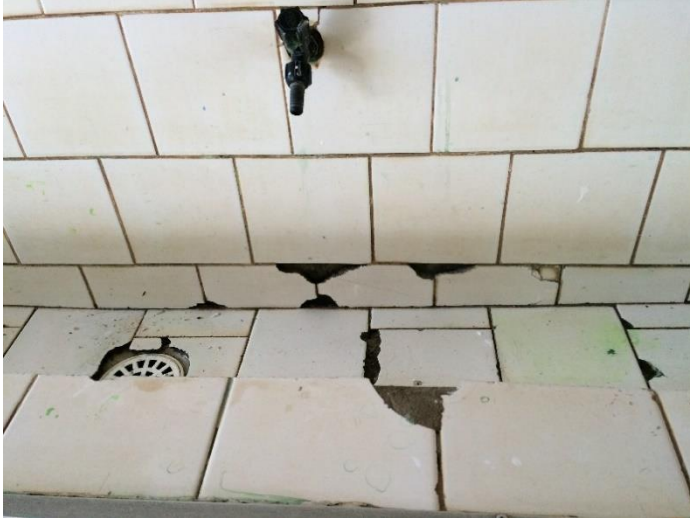
Figura 34 – Descolamento do revestimento cerâmico com presença de água
