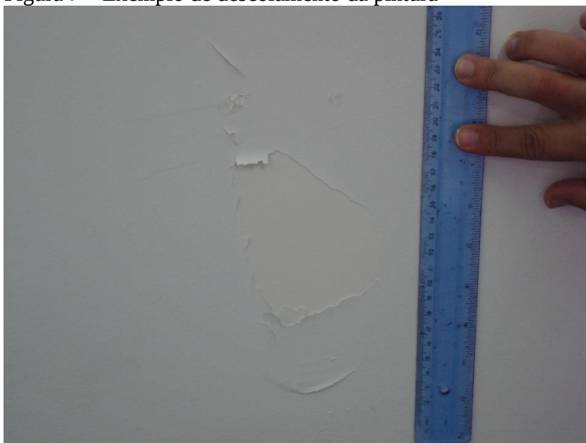
Figura 7 – Exemplo de descolamento da pintura
