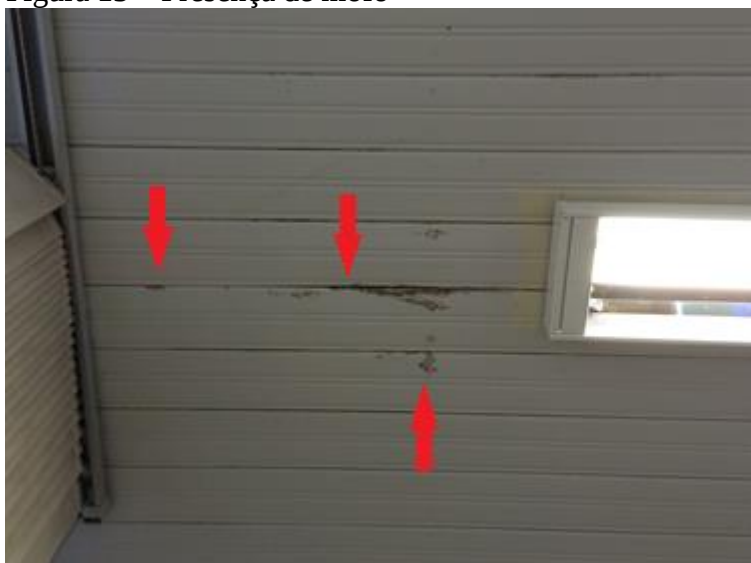
Figura 13 – Presença de mofo
