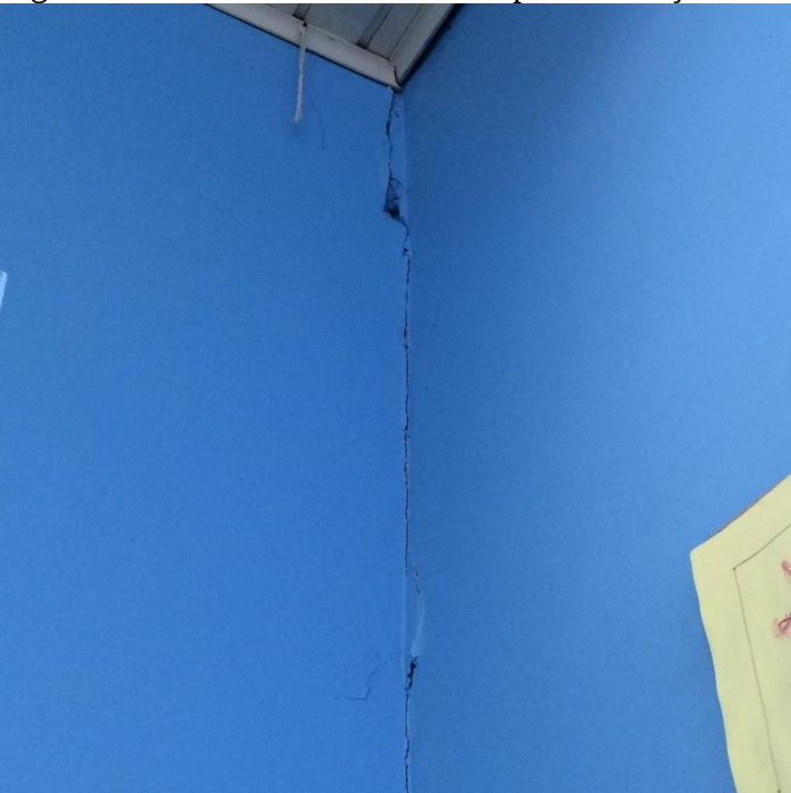
Figura 26 – Trinca vertical causada por amarração
