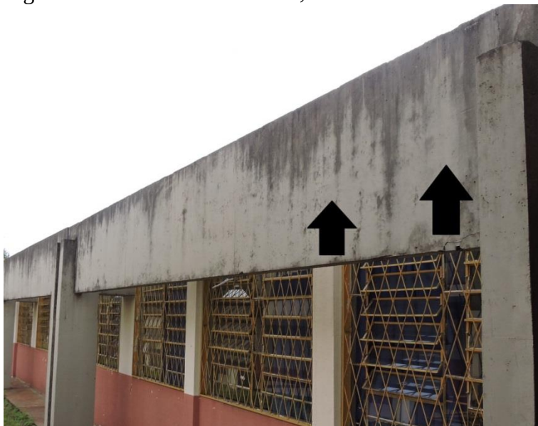
Figura 22: Bolor na área externa, na face Oeste do bloco 04.
