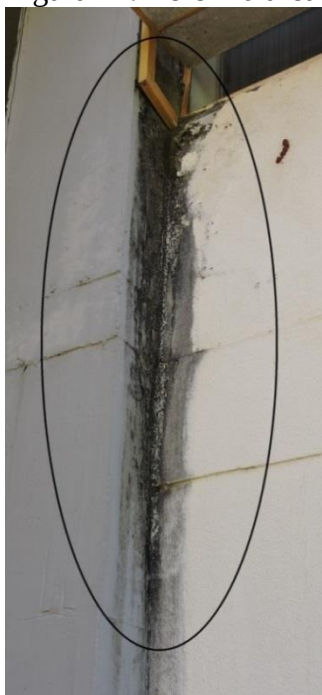
Figura 21: Bolor na área externa, na face Sul do bloco 05.
