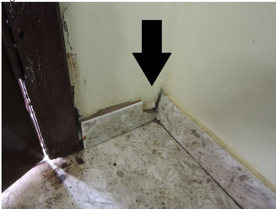
Figura 23: Descolamento de revestimento na área interna de uma sala de aula do bloco 04.
