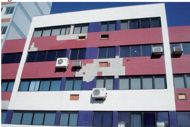
Figura 10: Descolamento de revestimento cerâmico.
