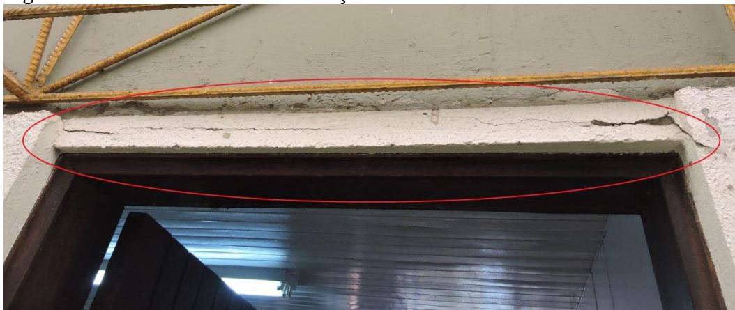
Figura 13: Fissuras na área de circulação coberta do bloco 05.
