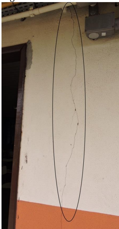
Figura 17: Fissura na área externa no bloco 04.
