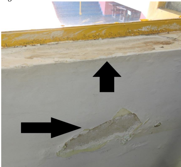
Figura 19: Destacamento na área interna da Secretaria Escolar no bloco 05.
