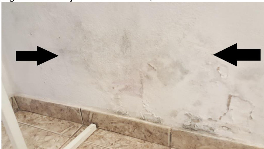
Figura 18: Infiltração no mini-auditório, na face leste do bloco 05.
