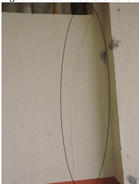
Figura 14: Fissura na área externa do bloco 04.
