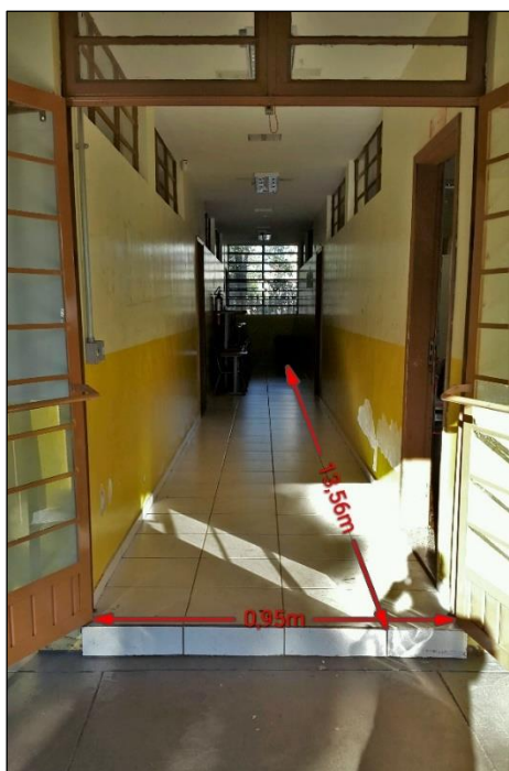
Figura 53 – Desnível no acesso ao bloco 1
