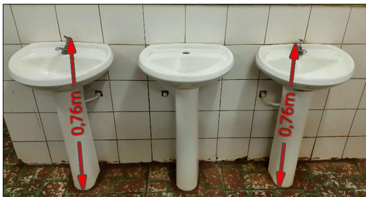
Figura 40 – Lavatórios do banheiro masculino
