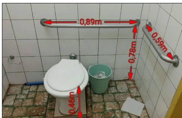
Figura 43 – Bacia sanitária do banheiro adaptado
