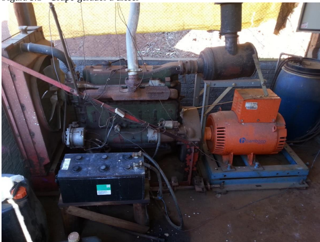
Figura 3.1 - Grupo gerador a diesel
