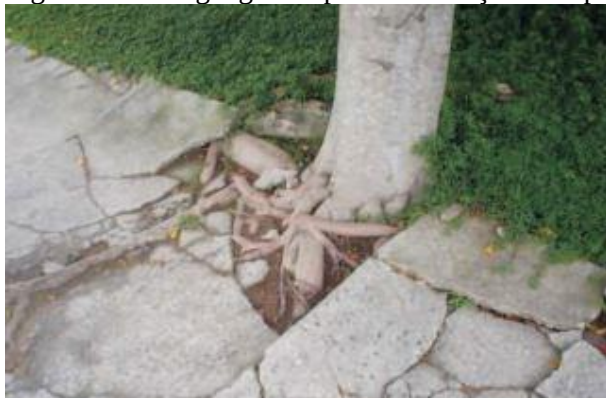
Figura 5: Patologia gerada pela arborização de espécie inadequada.
