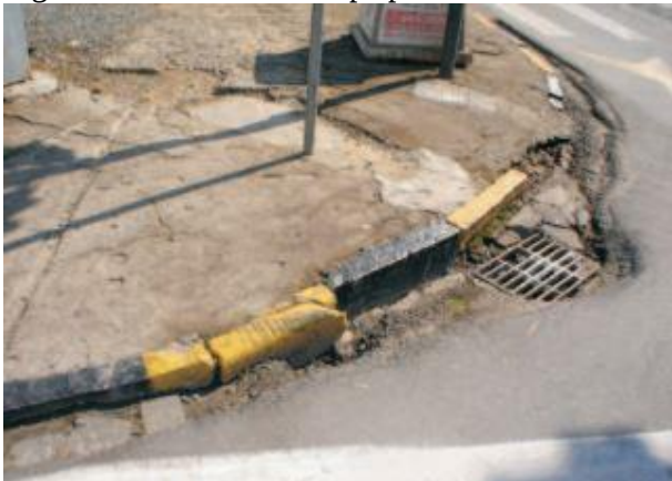
Figura 7: Ausência de rampa para acesso a cadeirantes e piso podotátil.
