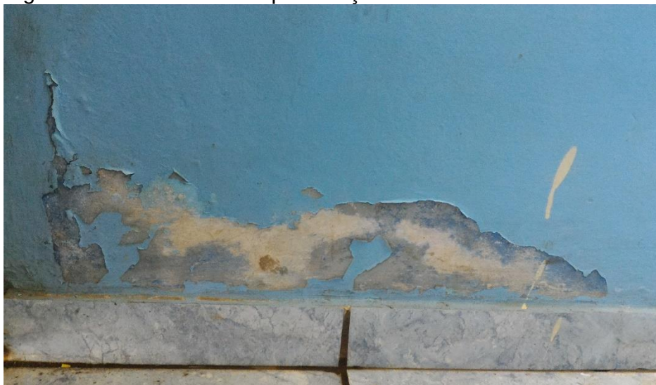
Figura 18 - Amostra 34: saponificação advinda de umidade ascendente.
