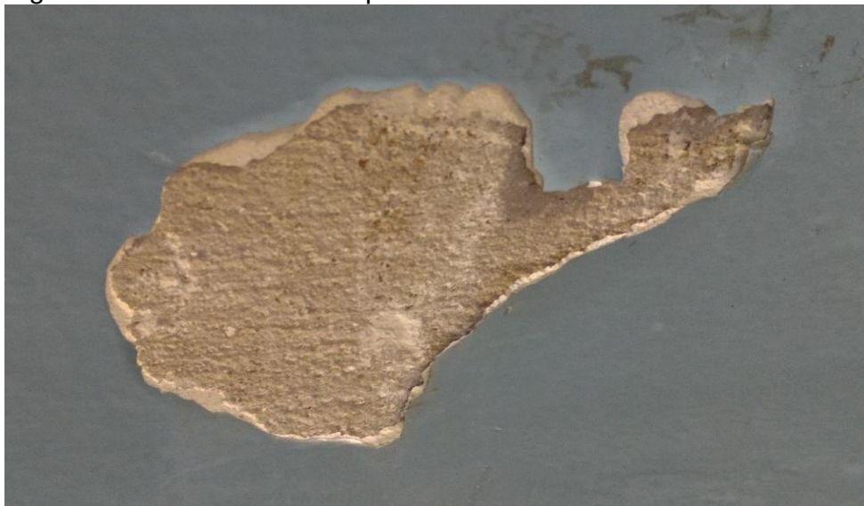
Figura 5 - Descolamento da pintura.
