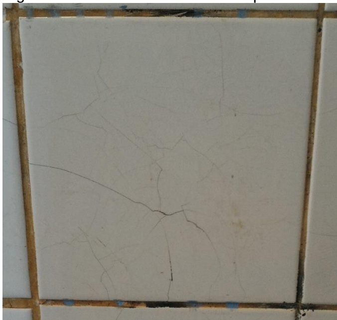
Figura 16 - Amostra 28: fissura em placa cerâmica.
