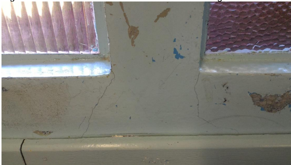
Figura 10 - Amostra 4: fissura advinda de sobrecarga.
