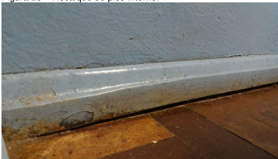
Figura 13 – Recalque do piso interno.
