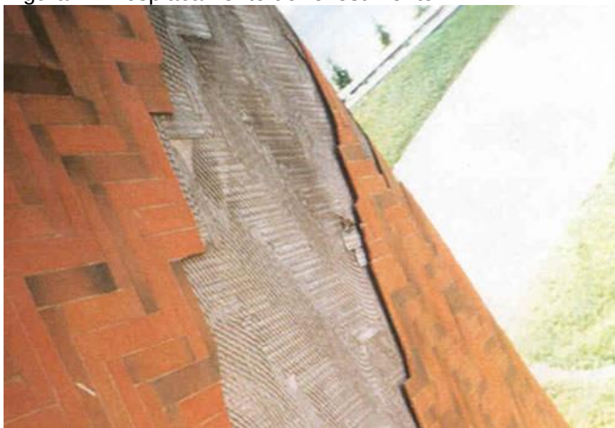
Figura 4 - Desplacamento do revestimento.
