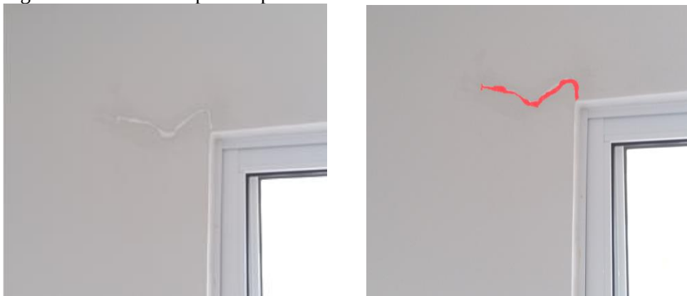
Figura 22 – Fissura na parte superior do vão.
