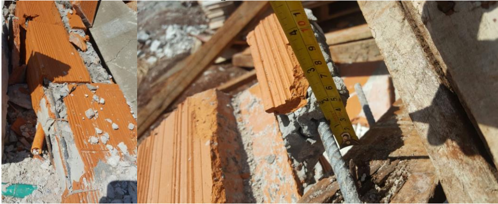
Figura 28 – Rompimento da contraverga devido flexão – Método 3.
