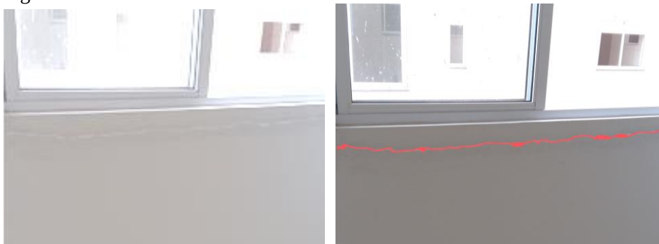
Figura 23 – Fissura em toda extensão da abertura.
