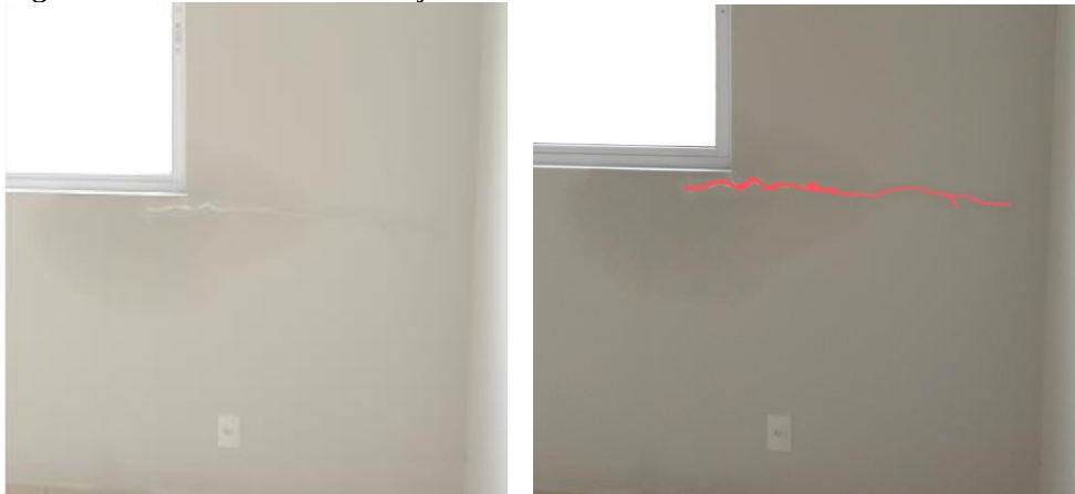
Figura 21 – Fissuras em vão de janela de unidade habitacional.
