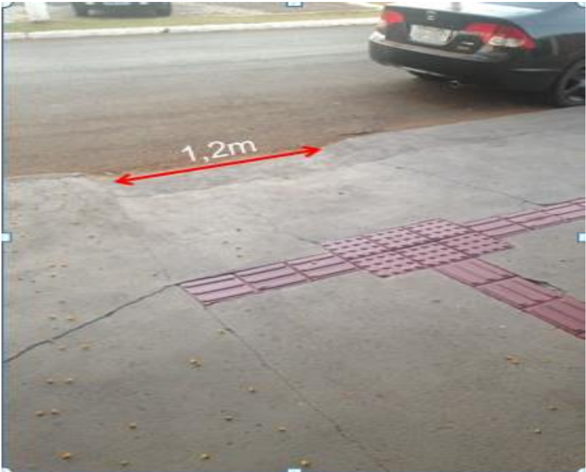
Figura 9: Guia rebaixada 2, com medidas adequadas e falta de sinalização internacional de acesso.
