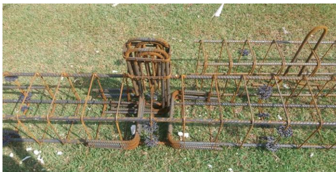
Figura 7 - Armaduras disposta para lançamento com oxidação e inspecionada
