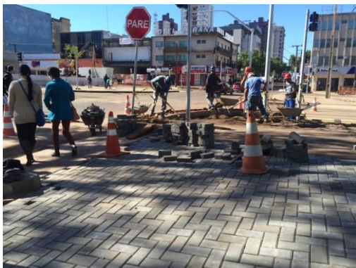
Figura 02 – Piso em processo de substituição com material correto.
