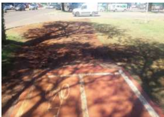
Figura 01: Pista de Caminhada e Ciclovia não acabadas
