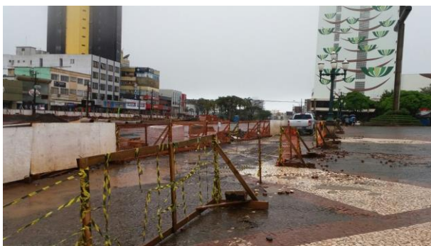
Figura 3 - Desvio localizado em frente a Catedral e em péssimas condições de uso.
