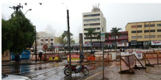
Figura 2 - Sinalização provisória e com algumas falhas próximo a Catedral Nossa Senhora Ap a .
