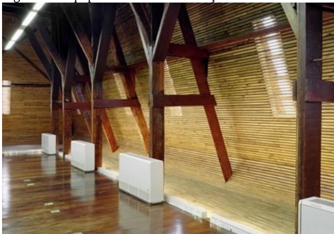
Figura 08: Equipamentos de climatização
