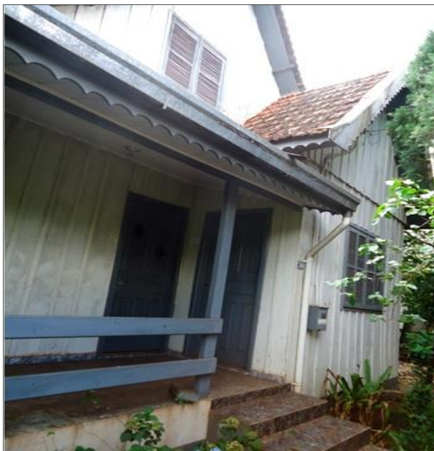
Figura 23 – Estado atual de conservação da Casa Theodor Schierholt
