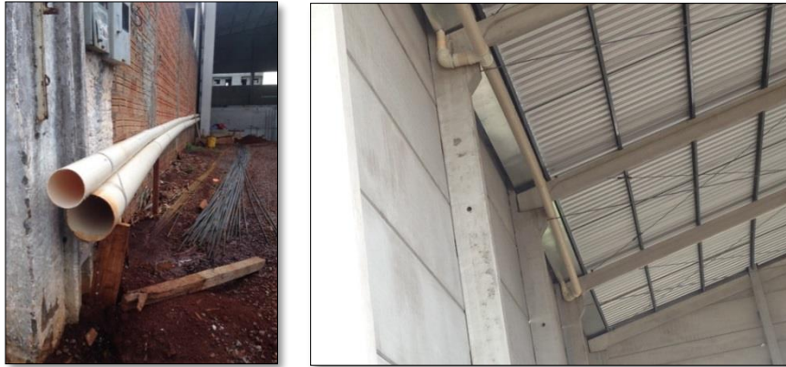
Figuras 34 e 35: Tubulação.
