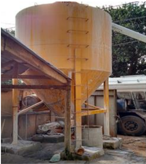
Imagem 1: Silo de depósito componentes e produção da argamassa
