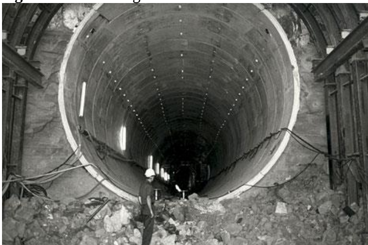
Figura 1: Tubo de água do Central Arizona
