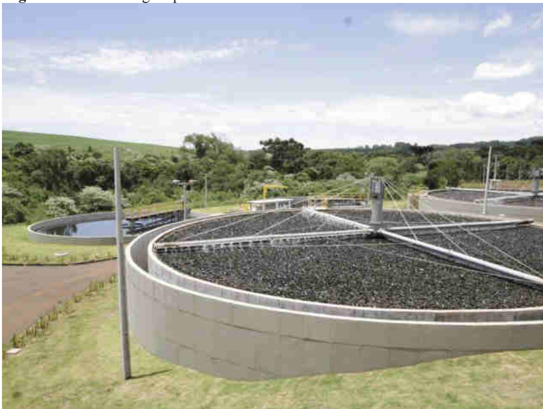
Figura 6: Filtro biológico percolador ETE Melissa Cascavel
