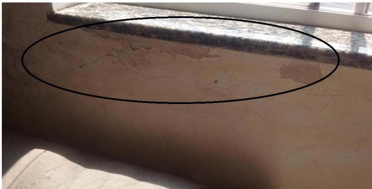
Figura 35 – Desagregação da argamassa
