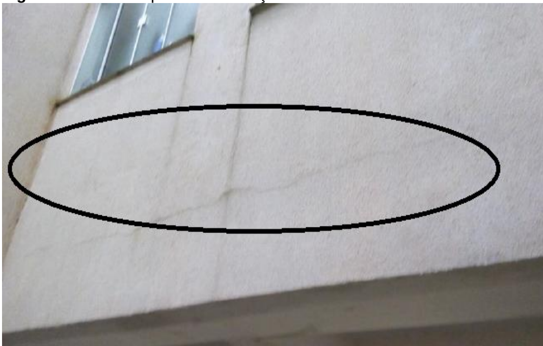
Figura 27 – Fissura por movimentação térmica
