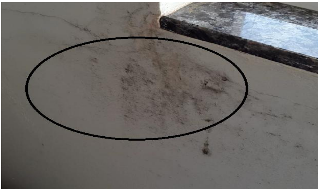
Figura 32 – Infiltração abaixo da janela
