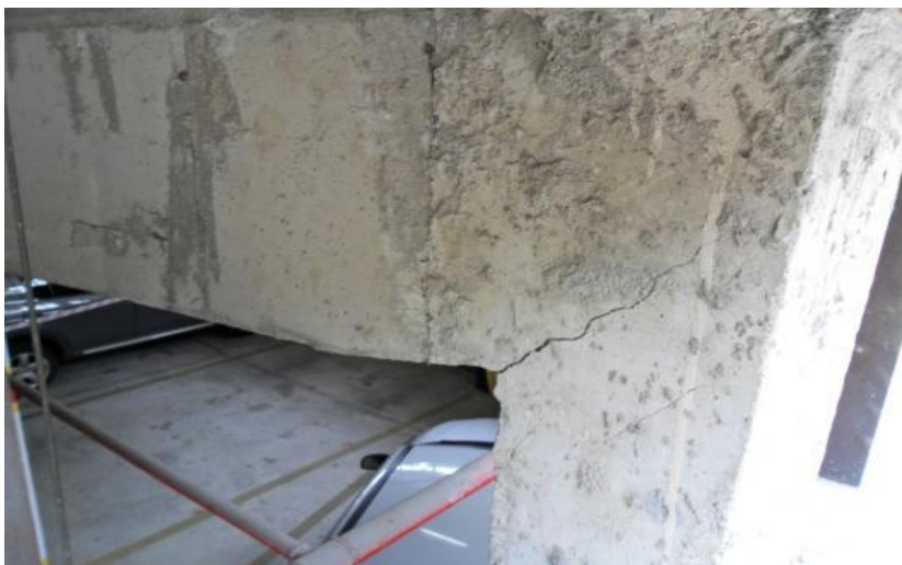
Figura 9 – Fissuras em viga
