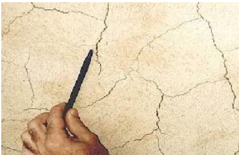
Figura 4 – Fissura por retração da argamassa
