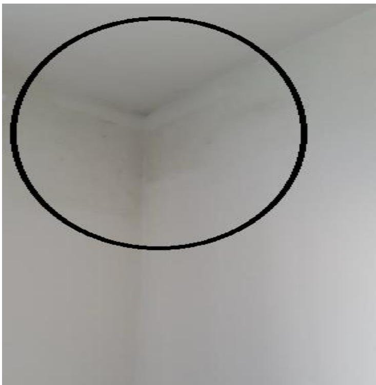
Figura 31 – Infiltração na parede
