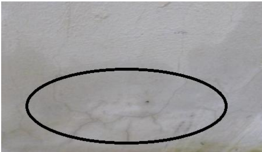
Figura 29 – Fissura por retração da argamassa
