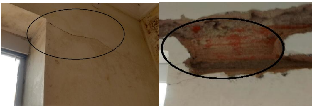
Figura 24 – Fissura por falta de verga
