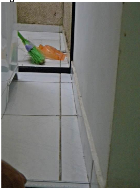
Figura 33: Assentamento incorreto do piso
