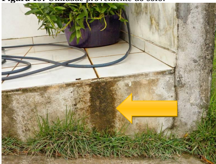
Figura 19: Umidade proveniente do solo.
