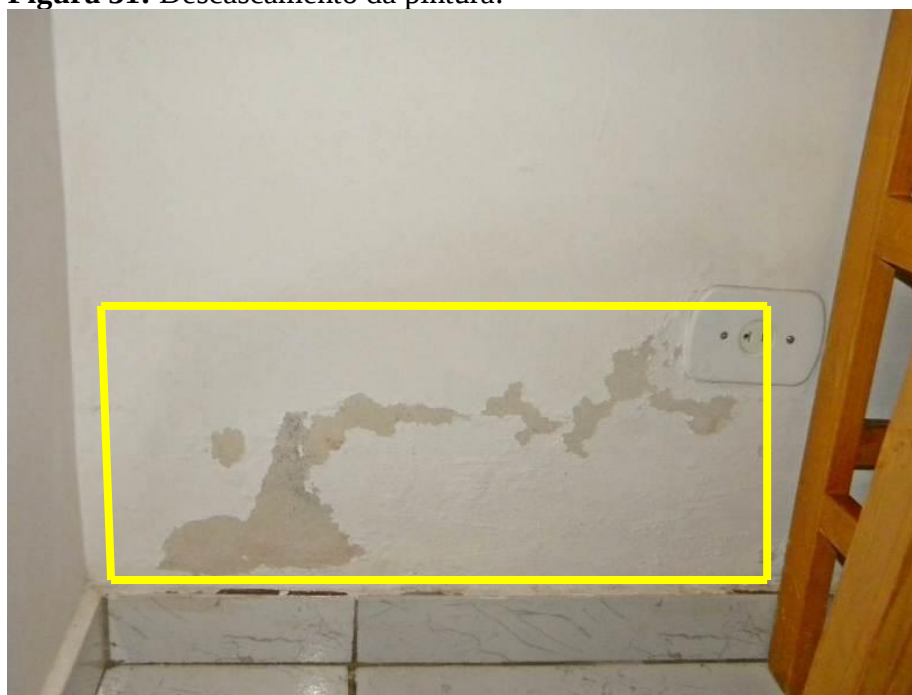
Figura 31: Descascamento da pintura.
