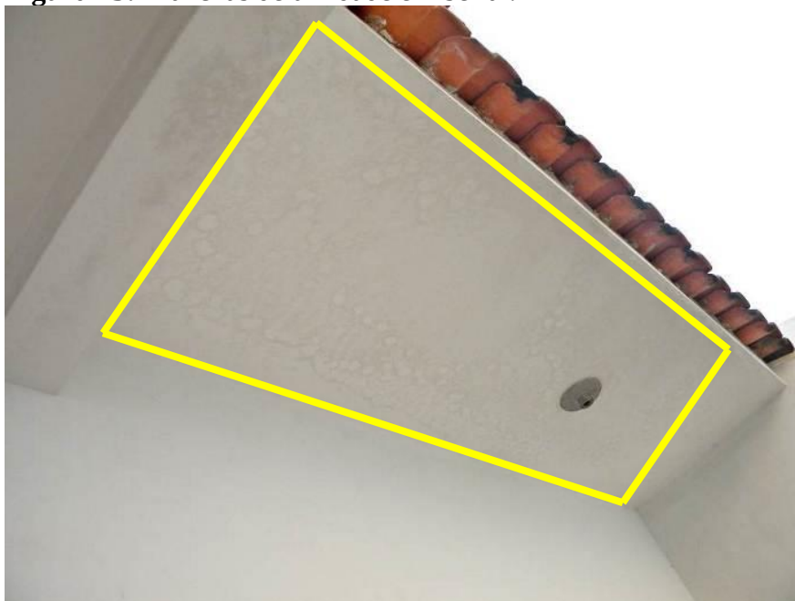
Figura 23: Manchas de umidade em beiral.
