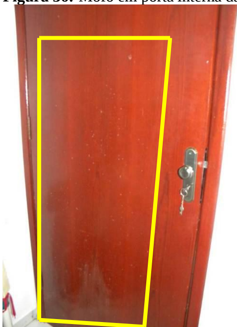
Figura 36: Mofo em porta interna da residência.
