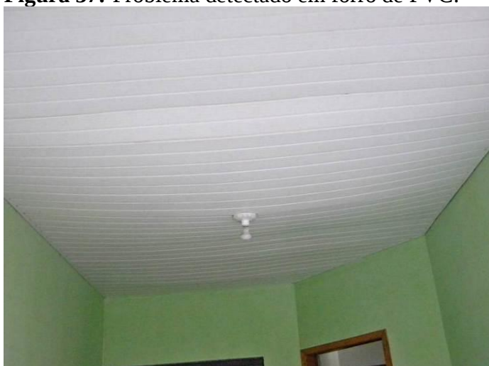
Figura 37: Problema detectado em forro de PVC.
