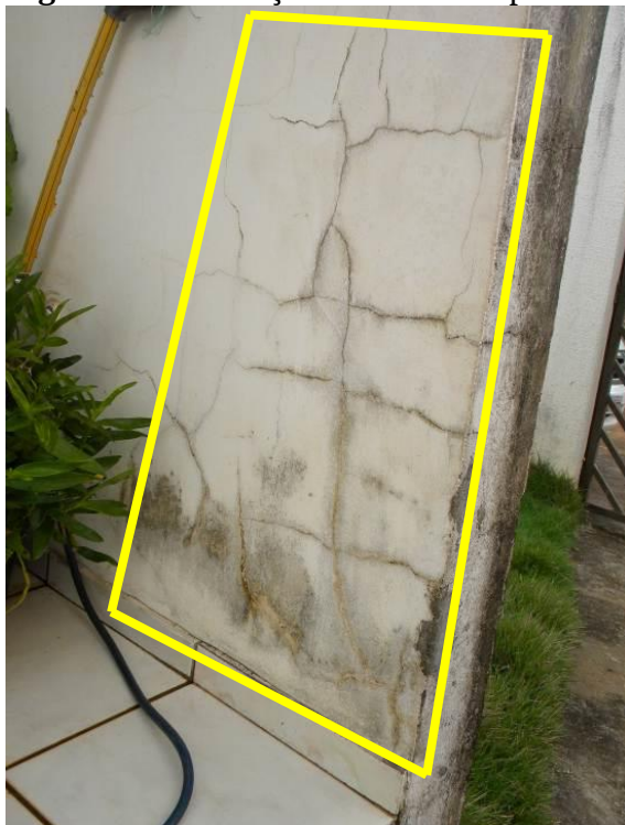
Figura 21: Presença de fissuras na parede.
