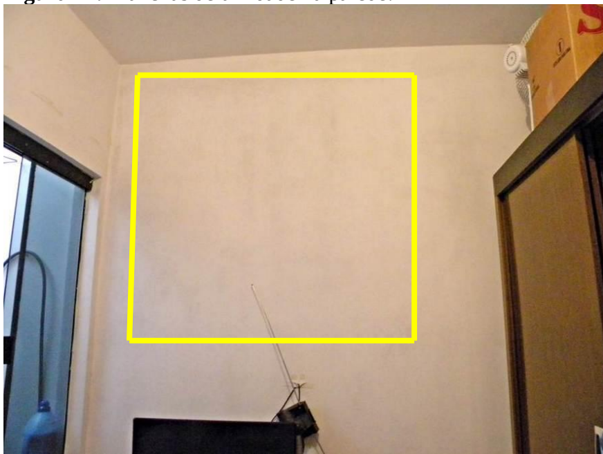
Figura 24: Manchas de umidade na parede.
