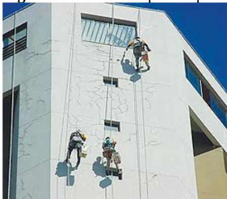
Figura 4: Fissuras mapeadas provocadas pela retração de secagem da argamassa.
