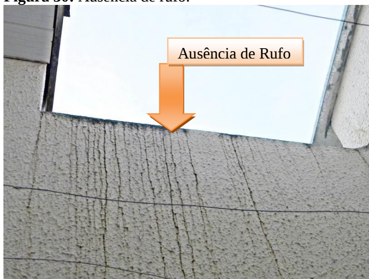
Figura 30: Ausência de rufo.
