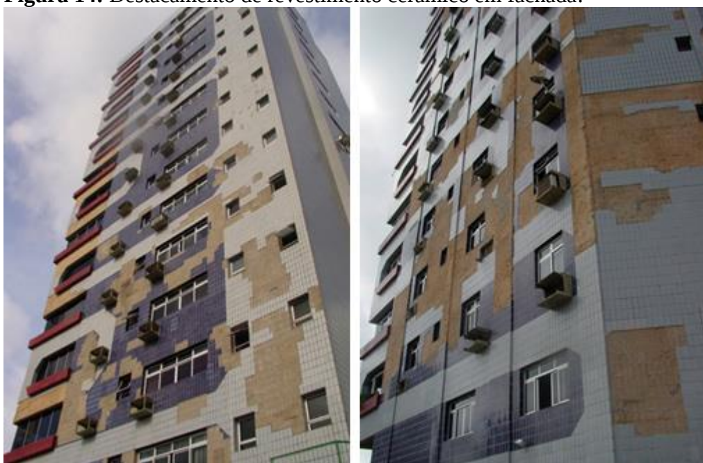
Figura 14: Destacamento de revestimento cerâmico em fachada.
