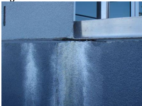
Figura 6: Eflorescência em revestimento argamassado.
