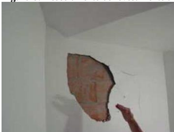
Figura 8: Descolamento de revestimento argamassado.
