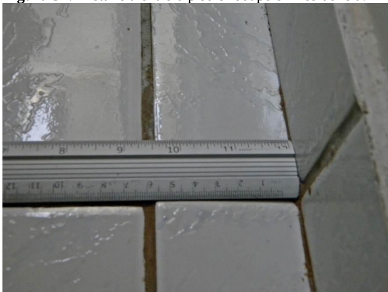
Figura 34: Distância entre o piso e rodapé em residência.
