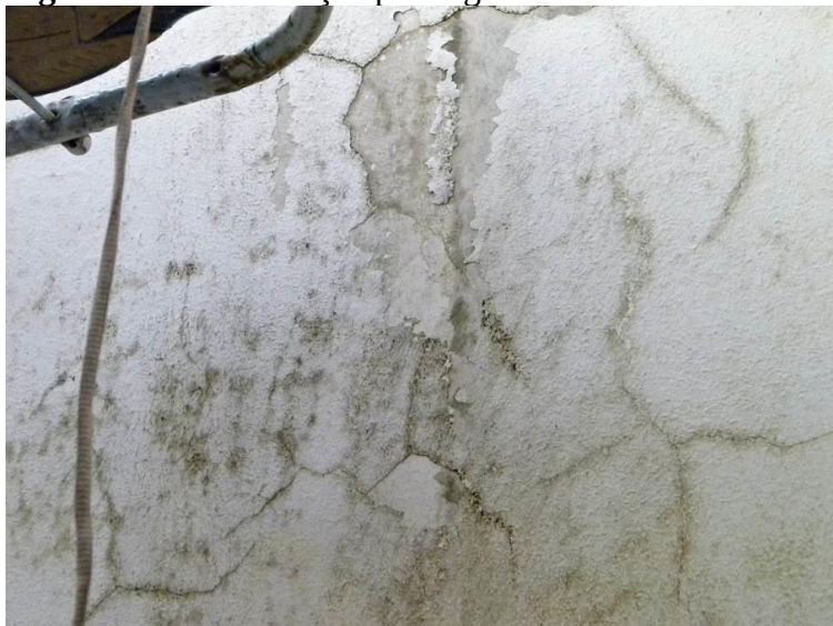
Figura 29: Manifestação patológica verificada na lavanderia.
