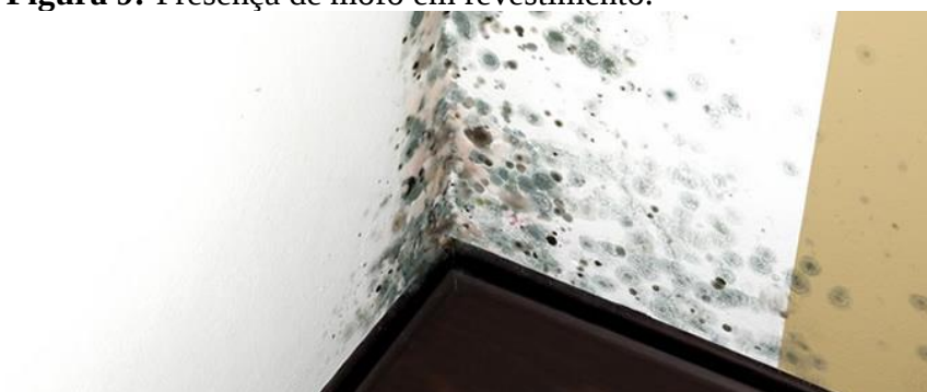
Figura 9: Presença de mofo em revestimento.
