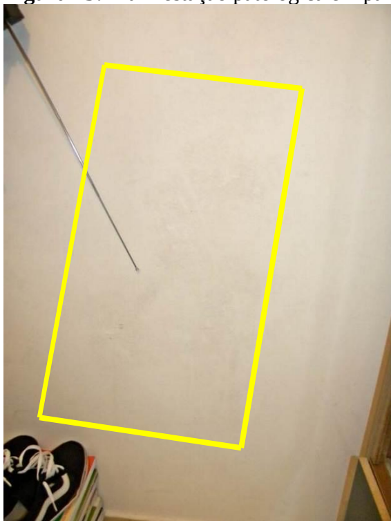
Figura 25: Manifestação patológica em parede do quarto.
