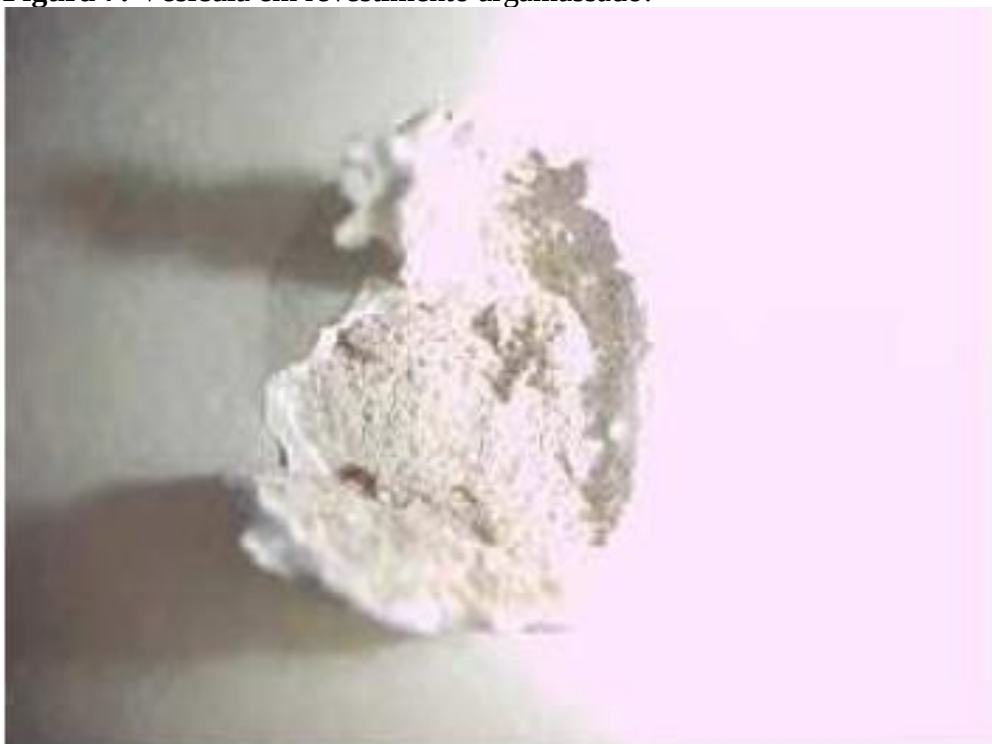
Figura 7: Vesícula em revestimento argamassado.
